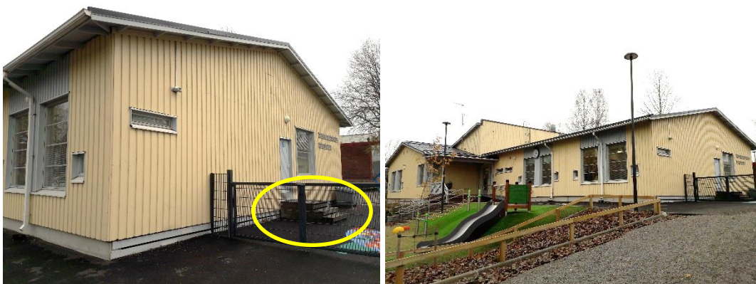
Kuva 12. Yleiskuvaa rakennuksen etelän ja lännen puoleisista julkisivuista. Julkisivut olivat aistinvaraisesti arvioiden hyväkuntoiset. Etelän puoleisen päädyn varauloskäynnin rakenneliittymistä oli päässyt vettä ulkoseinä- ja alapohjarakenteisiin ks. kuvat 13 ja 14. Tilan 30 ulkoportaan vastaisissa ulkoseinä- ja alapohjarakenteissa todettiin kosteus- ja mikrobivaurioita.
