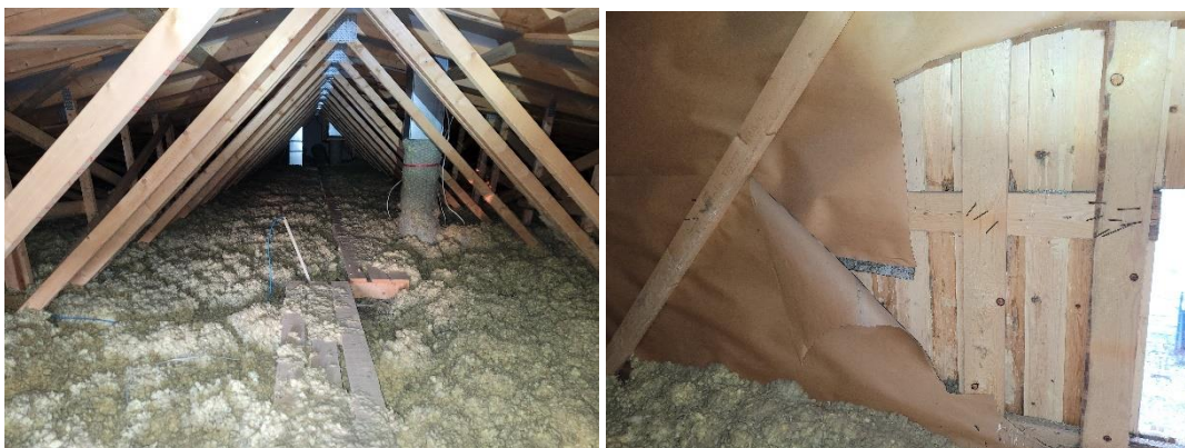
Kuva 19. Yleiskuvaa rakennuksen yläpohjasta. Eteläpäädyn sisäänkäynnin ympärillä ilmansulkupaperi oli revitty.
