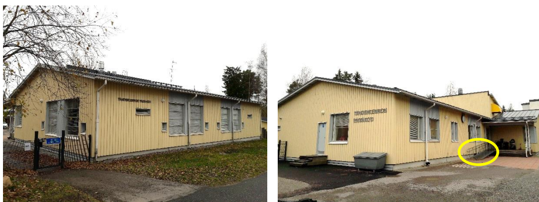
Kuva 11. Yleiskuvaa rakennuksen pohjoisen ja idän puoleisista julkisivuista. Julkisivut olivat aistinvaraisesti arvioiden hyväkuntoiset. Idän puoleisella julkisivulla sadevesi oli kastellut seinän alaosan ja perustuspalkin syöksytorven kohdalta ks. kuva 14. Tilan 23 alapohjarakenteessa todettiin mikrobivaurio.
