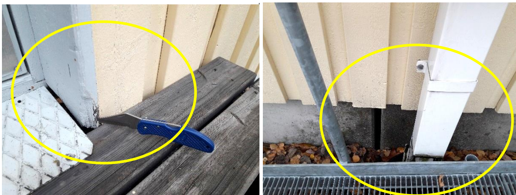
Kuva 14. Etelän puoleisen päädyn varauloskäynnin ovenpielistä oli päässyt vettä tilan 30 ulkoseinä- ja alapohjarakenteisiin, ja ovea ympäröivissä ulkoseinä- ja alapohjarakenteissa todettiin mikrobikasvustoa. Idän puoleisella julkisivulla sadevesi oli kastellut seinän alaosan ja perustuspalkin syöksytorven kohdalta ja tilan 23 alapohjan lämmöneristeessä todettiin mikrobikasvustoa.
