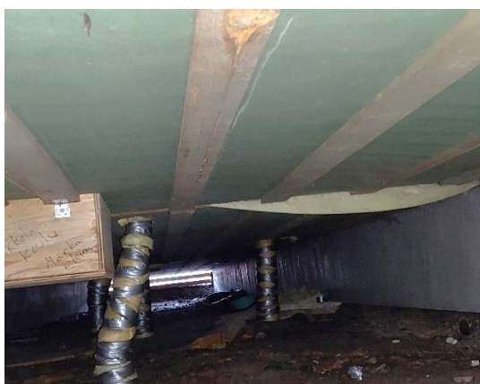
Kuva 7. Elementtisaumojen muovisuojatut mineraalivillakkaistat ovat monin paikoin valuneet pois paikoiltaan.
