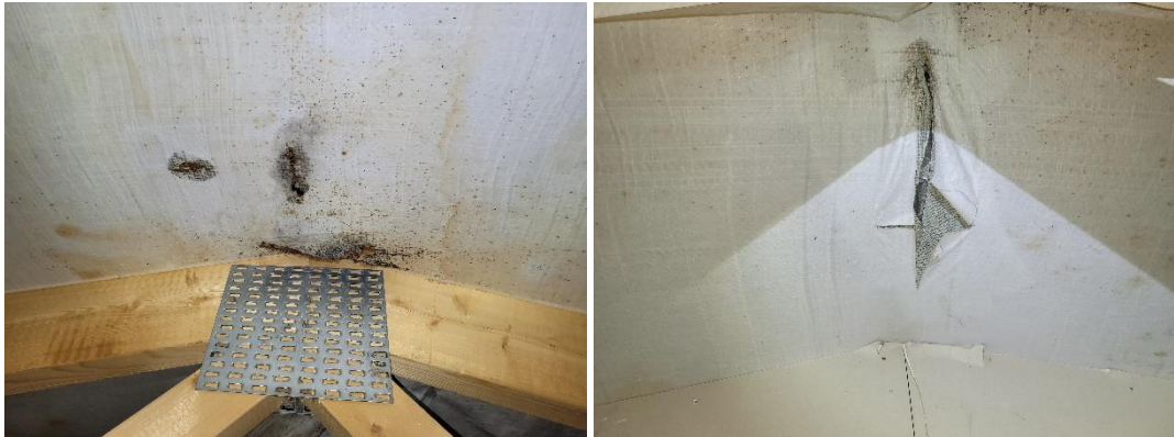
Kuva 20. Yläpohjan aluskatteessa oli paikoin reikiä ja keltaisia jälkiä todennäköisesti kondenssikosteudesta johtuen.
