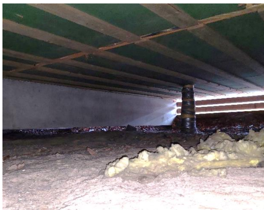
Kuva 5. Ryömintätilassa havaittiin paikallisesti rakennusmateriaaleja.
