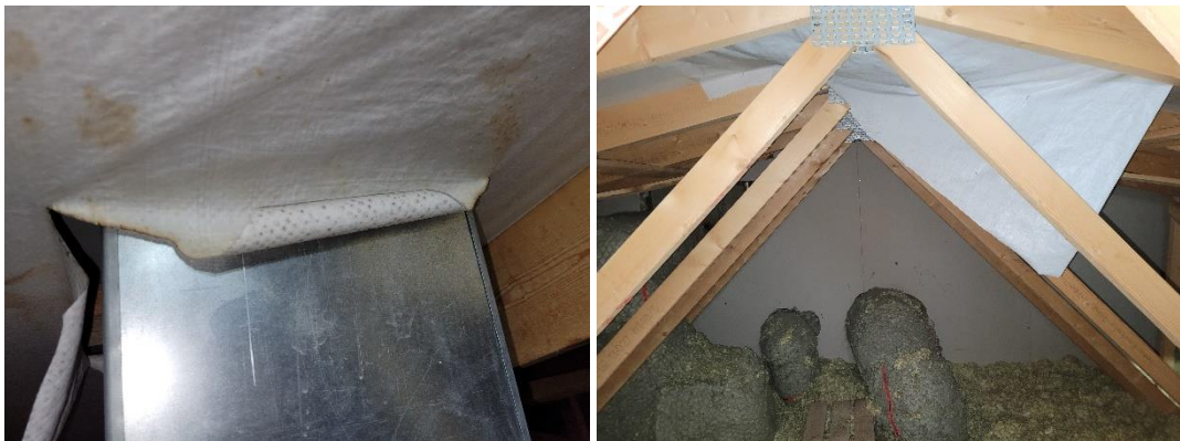
Kuva 21. Aluskatetta ei ollut teipattu vesikaton läpivientien kohdalta. Aluskate oli paikoin irti.
