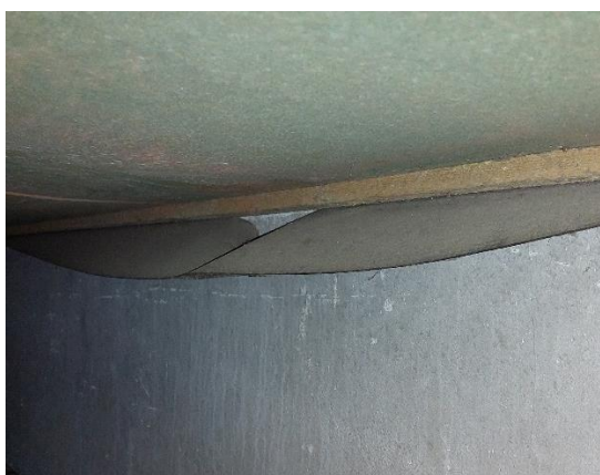
Kuva 6. Bitumikermikaistat ovat paikoin huonosti asennettu.
