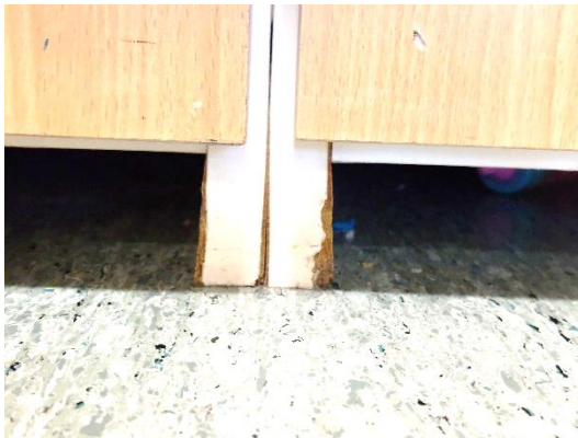
Kuva 3. Leikki- ja lepoahuoneen 02 sänkykaappien alaosissa havaittiin todennäköisesti lattian pesuvesien aiheuttamia kosteusjälkiä.
