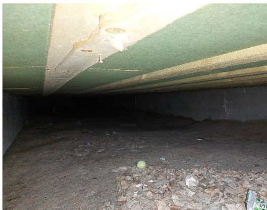
Kuva 4. Ryömintätilassa havaittiin vähäisiä määriä lehtiä ja roskia.
