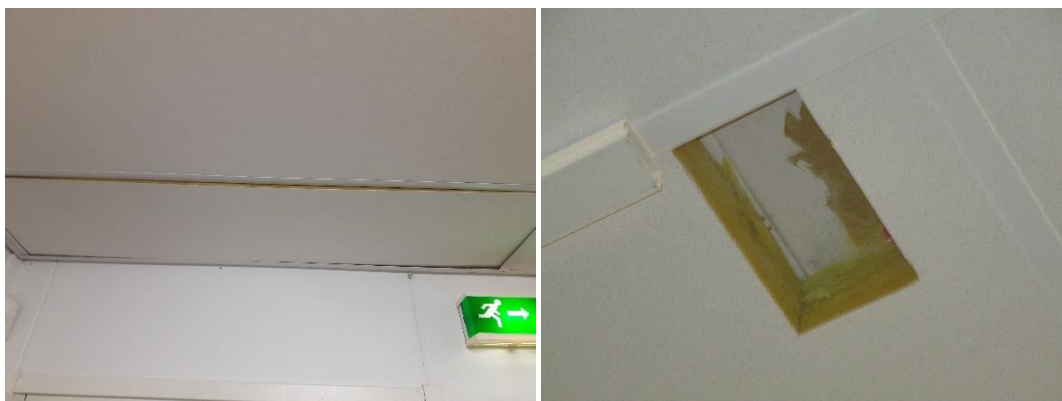
Kuva 18. Eteistilojen alaslaskettujen kattojen akustiikkalevyt olivat reunoiltaan pinnoittamattomia. Leikki/lepohuoneessa 02 katon akustiikkalevyä oli leikattu niin, että mineraalivillapinta näkyi.
