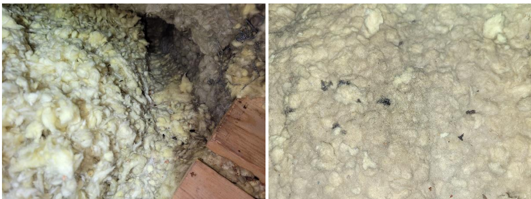
Kuva 22. Yläpohjan lämmöneristeissä oli runsaasti jyrssiöiden käytäviä ja ulosteita.
