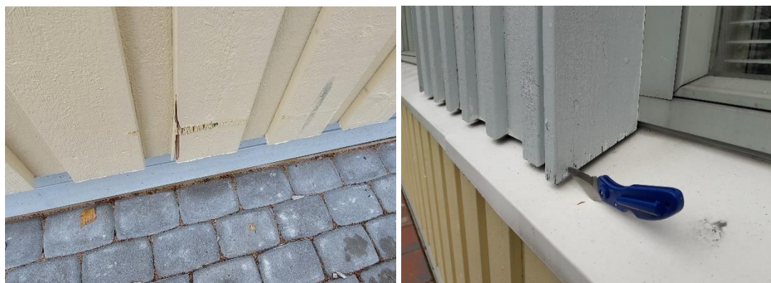
Kuva 16. Idän puoleisella julkisivulla oli vaurio seinälaudoituksessa. Ikkunapeltien kaltevuus ja tuuletusrako on riittävä. Ulkoseinäverhouksen maalipinta vesipeltien yläpuolella alkaa rapistua ja puu oli hieman pehmentynyt.
