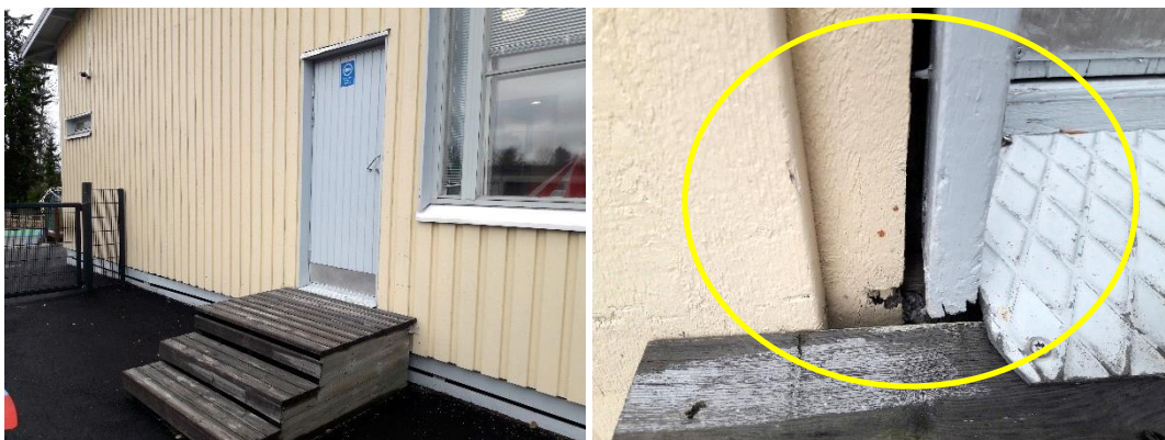
Kuva 13. Etelän puoleisen päädyn sisäänkäynnin rakenneliittymistä oli päässyt vettä tilan 30 ulkoseinä- ja alapohjarakenteisiin, ja ovea ympäröivissä ulkoseinä- ja alapohjarakenteissa todettiin mikrobikasvustoa.
