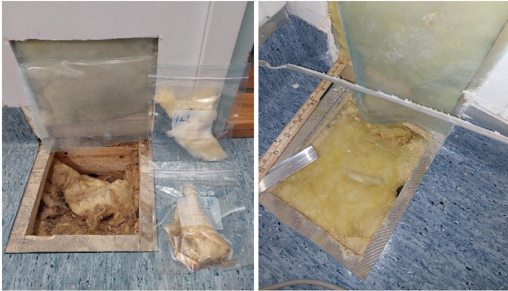
Kuva 2. Alapohjarakenteisiin tehdyissä rakenneavauksissa pienryhmähuoneen 30 sisäänkäynnin vasemmanpuoleisen rakenneavauksen RA1 mineraalivillaeristeestä, runko- ja alaohjauspuusta otetussa kokoomanäytteessä todettiin mikrobikasvustoa sekä oikeanpuoleisen rakenneavauksen RA16 alapohjan mineraalivillaeristeestä otetussa näytteessä epäily mikrobikasvustosta. Alapohjan tuulensuojalevy oli märkä. Ruokailu- ja neuvottelutilan 23 rakenneavauksen RA4 alapohjan mineraalivillaeristeessä todettiin mikrobikasvustoa.
