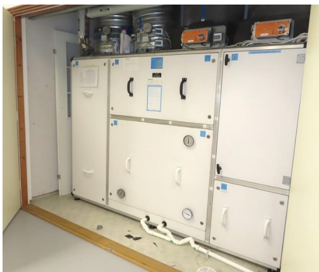
Kuva 20. Ilmanvaihtokone TK01. (kone on samantyyppinen kuin kone TK02)
