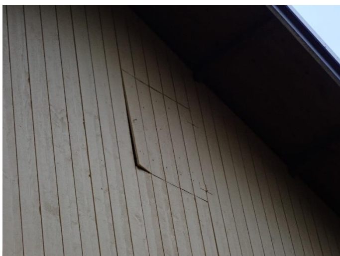
Kuva 10. Luukku on kieroutunut.
