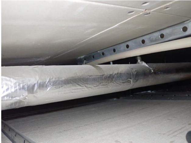
3. Pölyä silminnähdessä havaittavissa putkien päällä.
