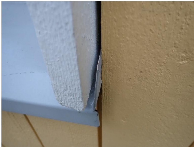
Kuva 2. Ikkunan täytelistan ja ikkunapellityksen välissä on rako.
