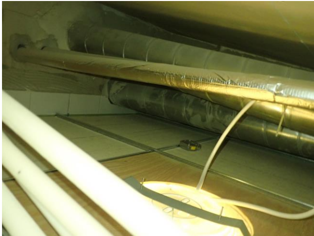
5. Pölyä silminnähdessä havaittavissa putkien päällä.
