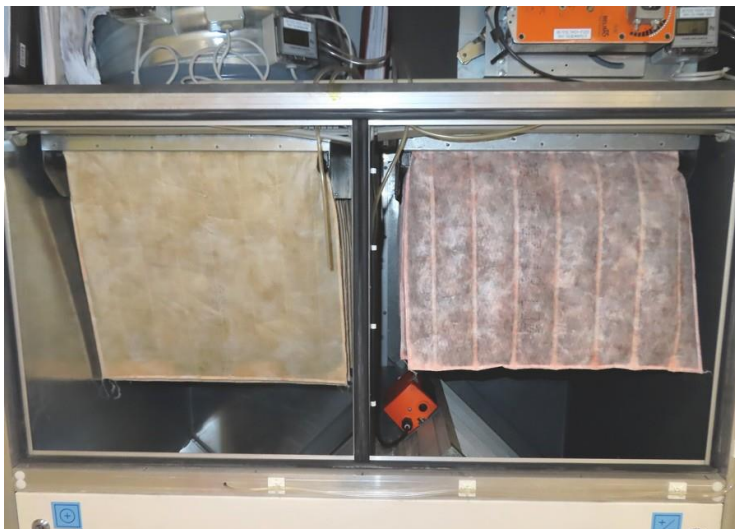
Kuva 21. Tuloilmasuodatin oli F7-tasoinen (oikealla). Poistoilmasuodatin oli M6-tasoinen (vasemmalla). Suodattimien kehykset olivat tiiviit.
