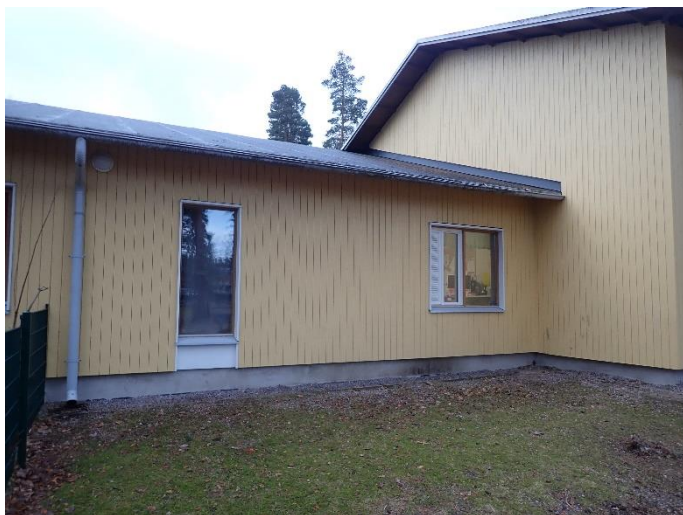
Kuva 15. Sokkelissa kosteuden aiheuttama tummuma
