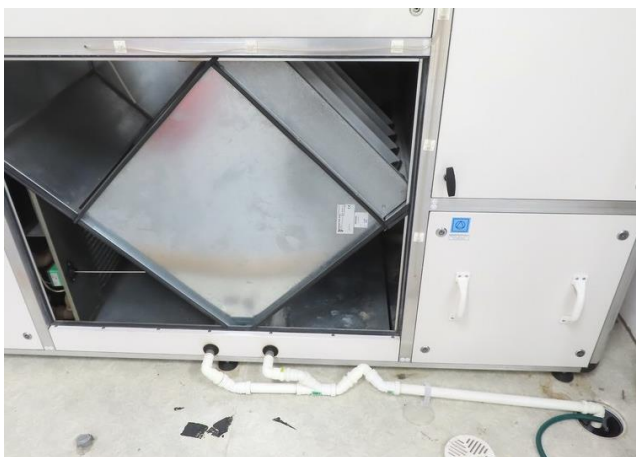
Kuva 22. Levylämmöntalteenottolaitteen veden poistoputket on liitetty lattiakaivoon.
