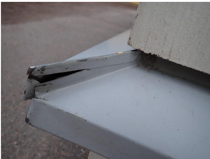
Kuva 4. Ikkuna pellityksessä vaurio.
