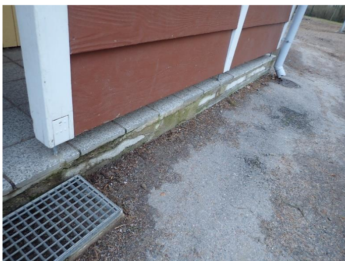
Kuva 6. Sisäänkulun katoksen pohja on sivustalta pahoin vaurioitunut.
