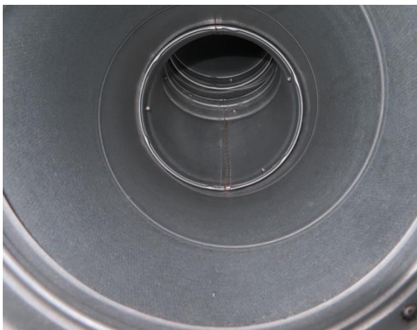
Kuva 28. IV-koneen TK02 tuloilmakanava, leikki-huone 143. Sisäpinnan pölykertymäarvio oli alle 1 g/m 2 (arviointipiste KP4).
