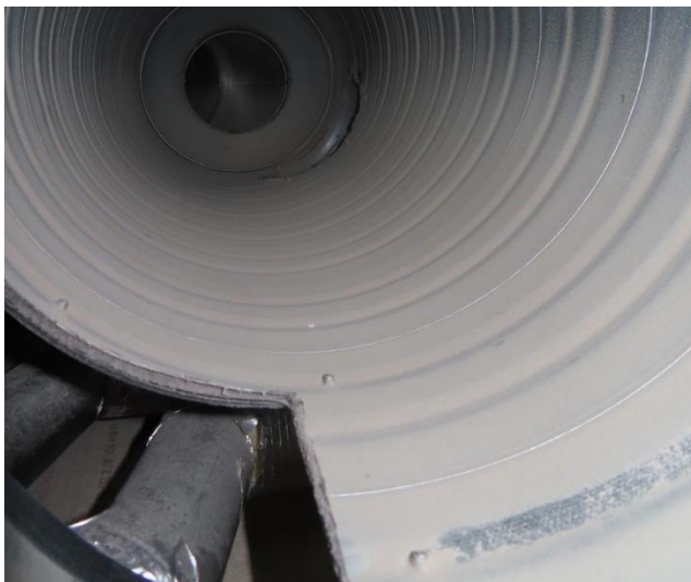
Kuva 29. IV-koneen TK02 poistoilmakanava, eteinen 122. Sisäpinnan pölykertymäarvio oli 5-7 g/m 2 (arviointipiste KP6).
