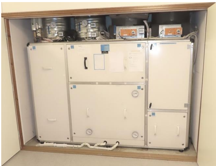
Kuva 24. Ilmanvaihtokone TK02. (kone on samantyyppinen kuin kone TK01)
