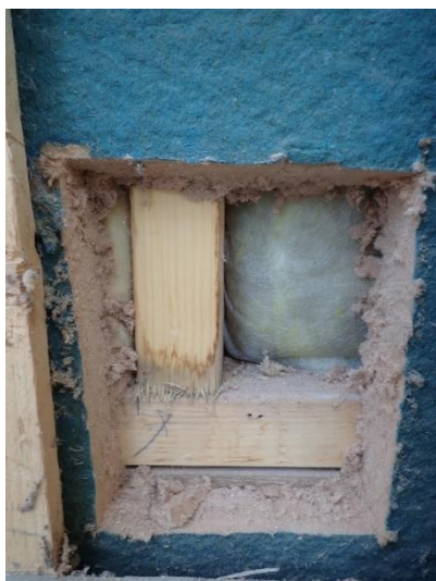
Kuva 15 RA5 kosteusjälkiä puurungossa
