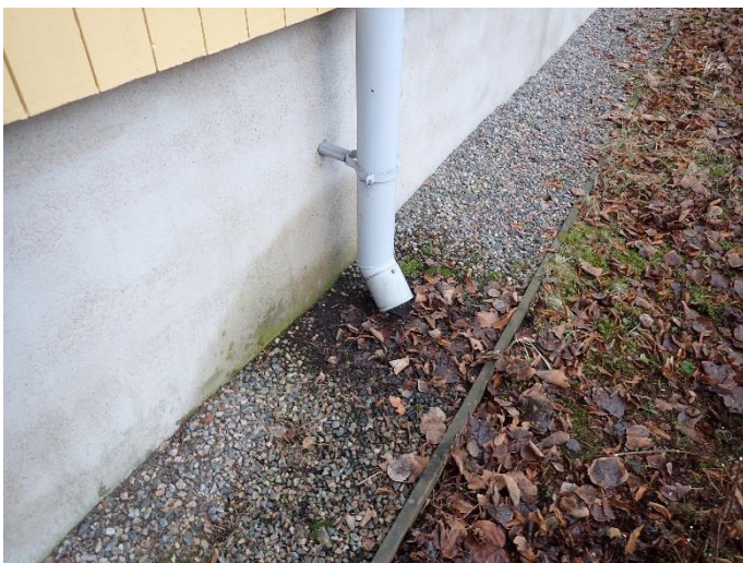
Kuva 13. Syöksytorvi ohjaa kattovedet viemäriin, jonka ritilä on lehtien peitossa.
