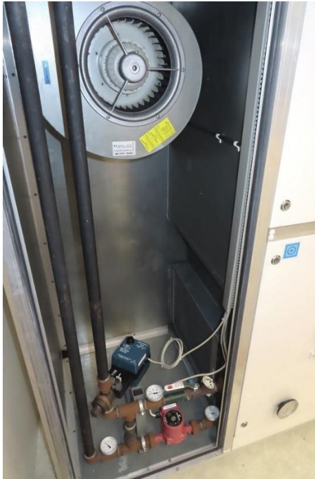
Kuva 23. Suorakäyttöinen tuloilmapuhallin lämmityspatterin jälkeen.
