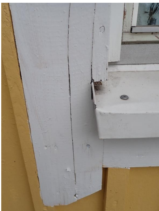
Kuva 17. Ikkunan täytelistoituksen vauriot.
