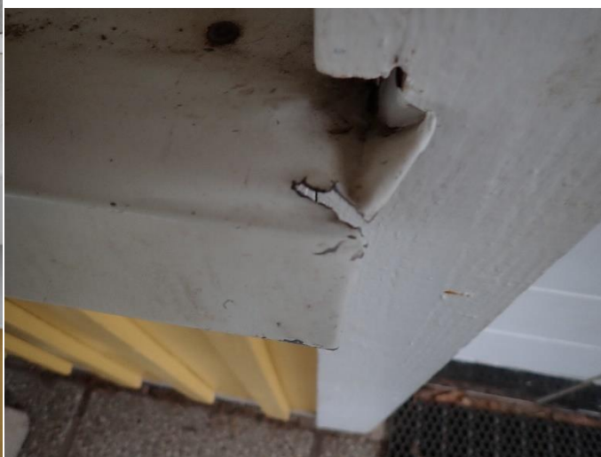
Kuva 18. Ikkunapellitykset ovat paikoin vaurioituneet.
