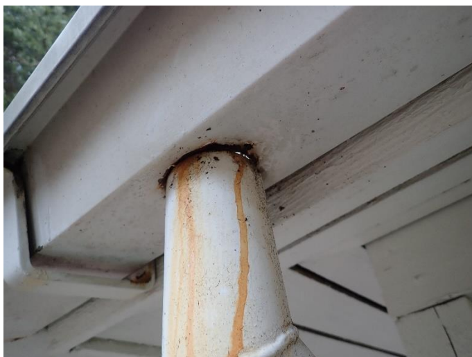
Kuva 22. Räystäskourujen ja syöksytorvien liittymät ovat laajalti vaurioituneet.
