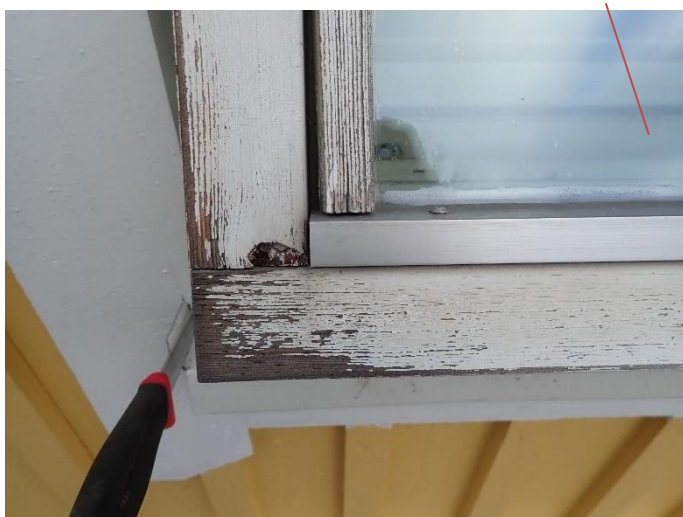
Kuva 12. Ikkunapuitteissa on laajalti maalivaurioita. Lahovaurioita esiintyi vain satunnaisesti ja pääosin lievinä.
