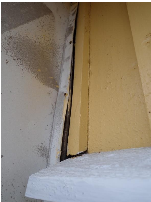
Kuva 9. IV-koneen ilmanoton huuuvan kiinnitys on vaurioitunut. Huuva on heikosti kiinni pehmeneessä/irronneessa taustalaudassa.
