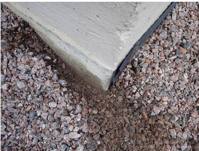
Kuva 14. Kaikilla seinustoilla ei havaittu pato levyä.
