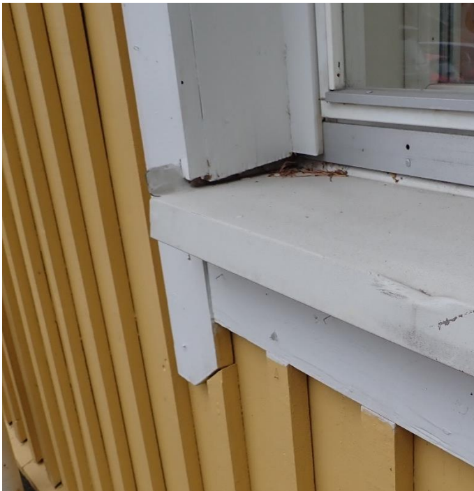
Kuva 23. Ikkunan täytelistat on paikoin tehty siten, että ikkunalaudan pellitys on nostettu puurakenteiden sisään/väliin. Tämän rakennetyypin peitelautoitukset ovat alapäästä vaurioituneet.
