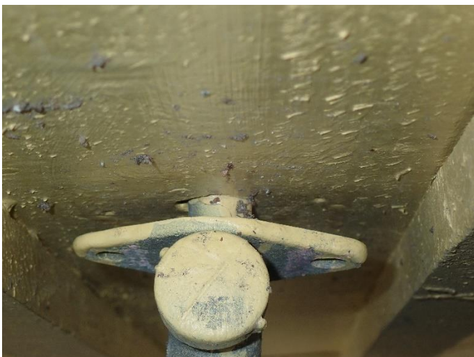
Kuva 4. Seinien läpiviennit ovat pääsääntöisesti tiivistämättä. Sadevedellä on suora yhteys ulkoverheuslaudoituksen taakse.
