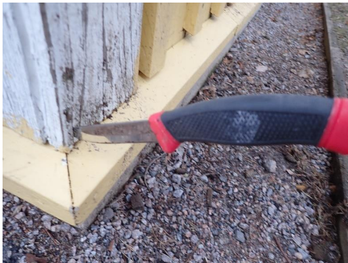
Kuva 2. Rakennuksen nurkkalauδοitukset ovat alareunasta pääsääntöisesti pehmeitä ja laudoitus alkaa lähes maanpinnasta, mikä altistaa puurakenteet lahovaurioille.
