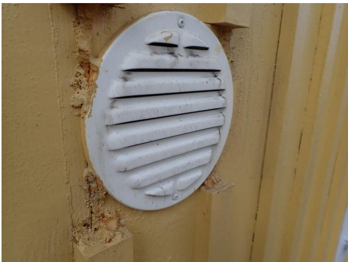
Kuva 3. IV-järjestelmän takia tehdyt aukot on viimeistely puutteellisesti. Katkaistun rimoituksen takia avonaisiksi jääneet raot laudoituksessa on paikattu polyuretaanilla, joka ei ole ilma eikä vesitiivis.
