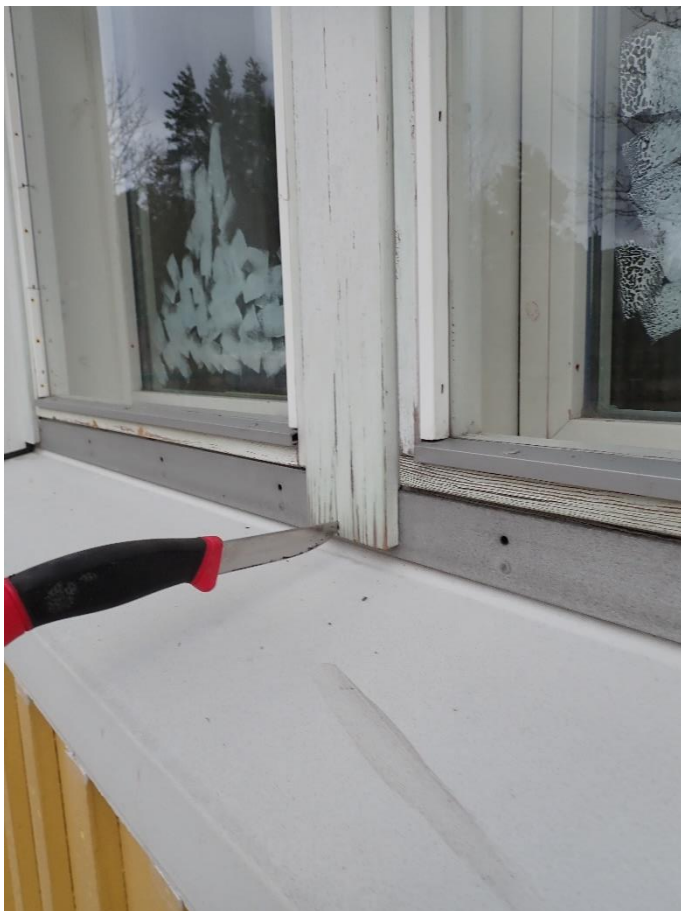
Kuva 13. Ikkunalistat ovat alaosistaan paikoin lahovaurioituneet. Lahovauriot usein lieviä ja vähäisiä.
