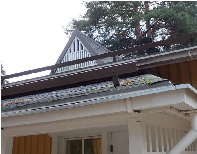
Kuva 24. Katolla on havaittavissa sammalkasvustoa ja havunneulasia.
