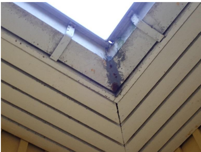
Kuva 6. Räystäskourut ovat paikoin ruostuneet puhki, jolloin vesi vuotaa hallitsemattomasti seinustalle.
