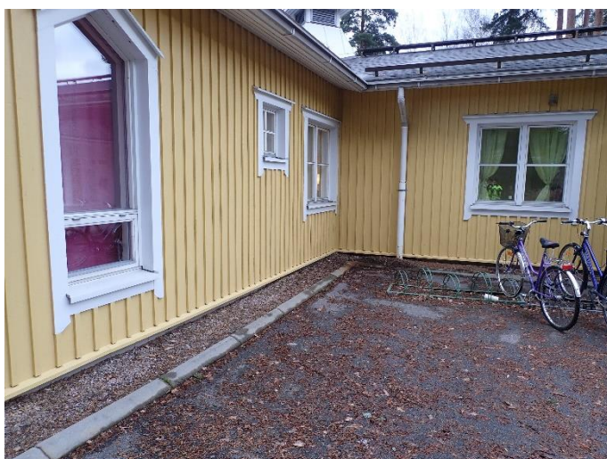
Kuva 20. Julkisivulautoitus alkaa lähes suoraan maanpinnasta. Maan pinnan yläpuolista sokkeliä ei käytännössä ole.
