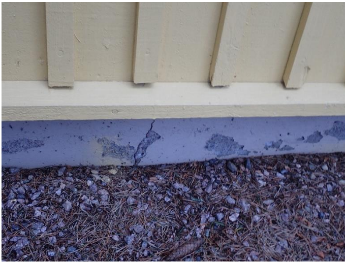
Kuva 15. Sokkelin pinnoitus on varioitunut ja sokkelissa on halkeamia.
