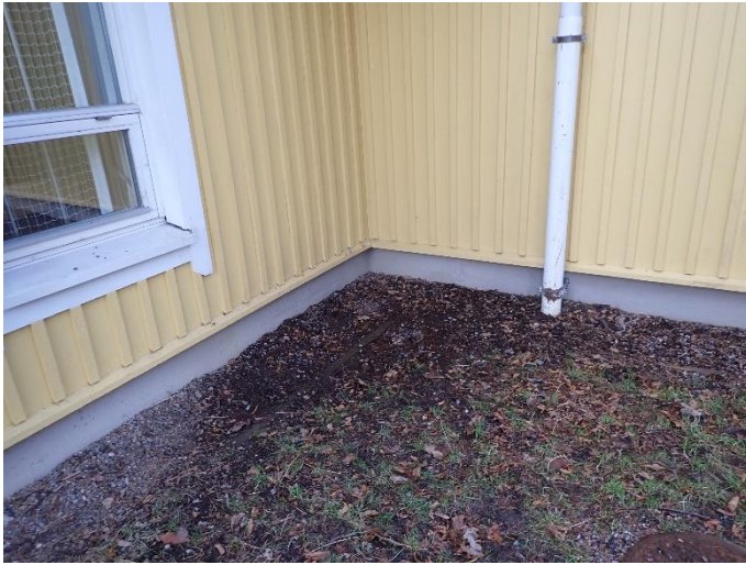
Kuva 7. Sisänurkassa on visuaalisesti havaittavissa korkeampaa kosteutta.
