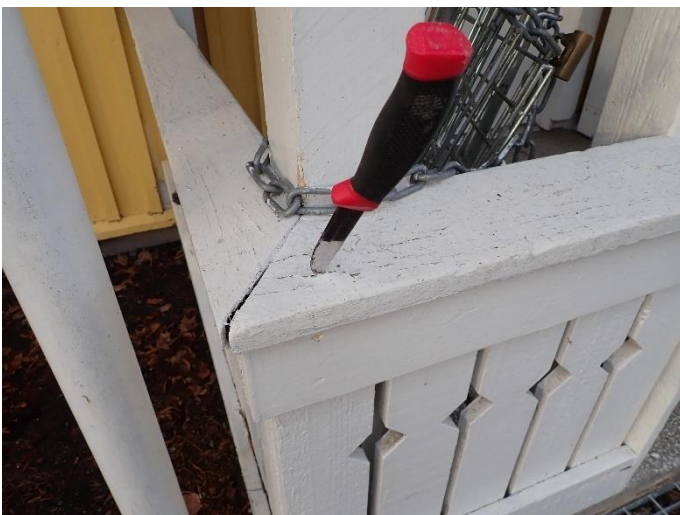
Kuva 10. Sisääntulokatoksen puurakenteissa on laajalti lieviä lahovaurioita. Sisääntulokatoksen lahovauriot ovat pääsääntöisesti koristelaudoituksissa ja katoksen kaiteissa. Kantavissa rakenteissa ei havaittu vaurioita.
