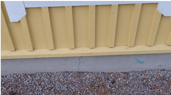
Kuva 5. Sokkelissa on satunnaisia halkeamia.
