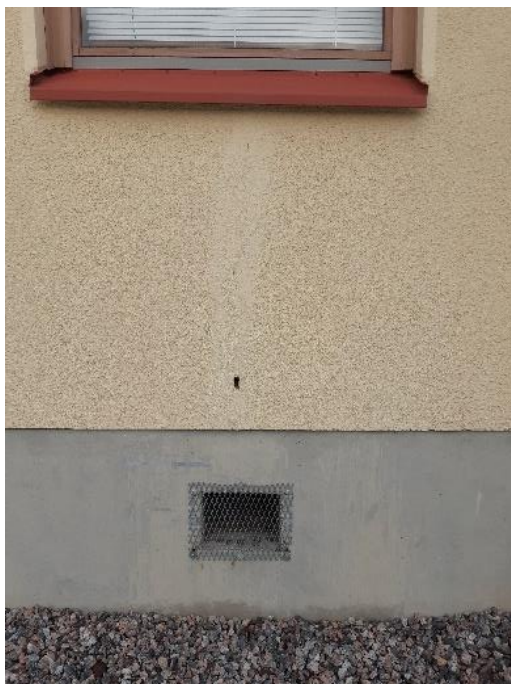
Kuva 14. Satunnaisia korjattuja halkeamia julkisivurappauksessa.
