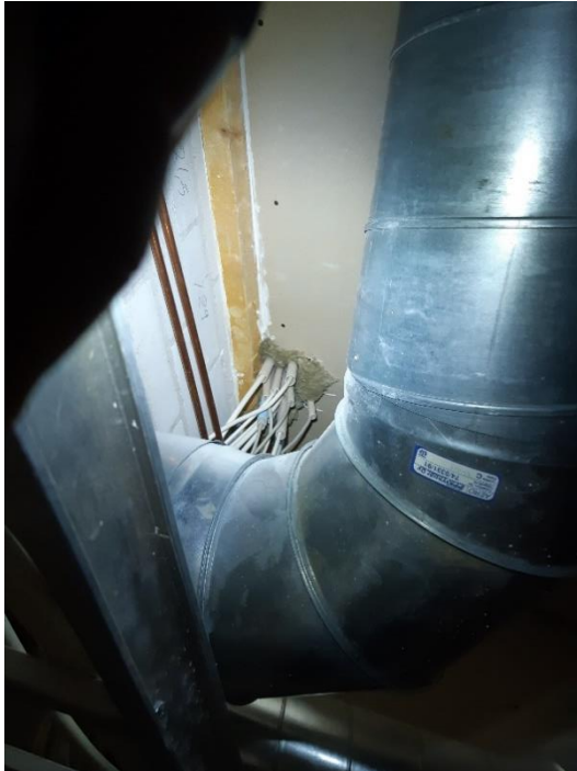
Kuva 19 Alakatto. Pölyisyyttä ja tiivistämättömiä läpivientejä.
