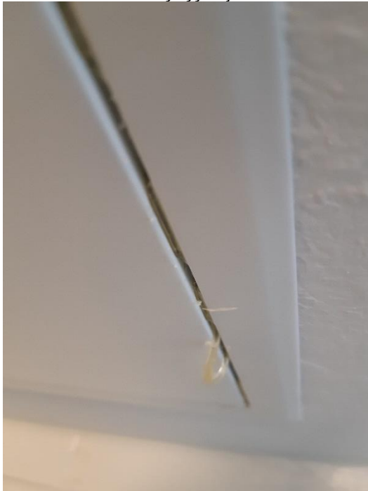
Kuva 20. Kattoluukun kittaukset ovat vaurioituneet.
