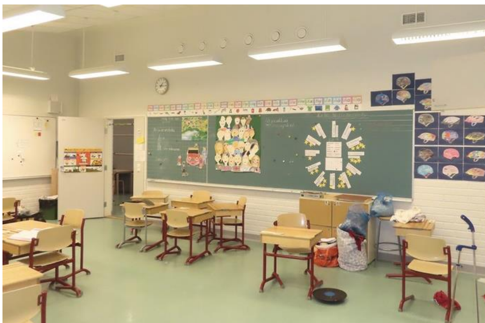
Kuva 17 Esimerkki mitatusta tilasta. Kuva on otettu opetustilasta 014. Tuloilmasäleiköt ja poistoilma-venttiilit on asennettu käytäväseinälle. Tilassa 014 todettiin savun avulla, että tuloilmasäleiköistä puhaltavan tuloilman aiheuttama ilmavirtaus ulottui 1-1,5 metrin päähän vastakkaisesta ulkoseinästä.
