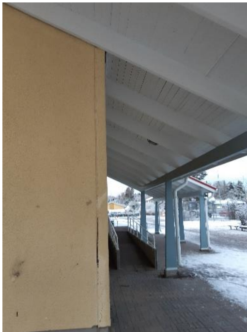
Kuva 13 Ulkoseinässä avoin sauma.
