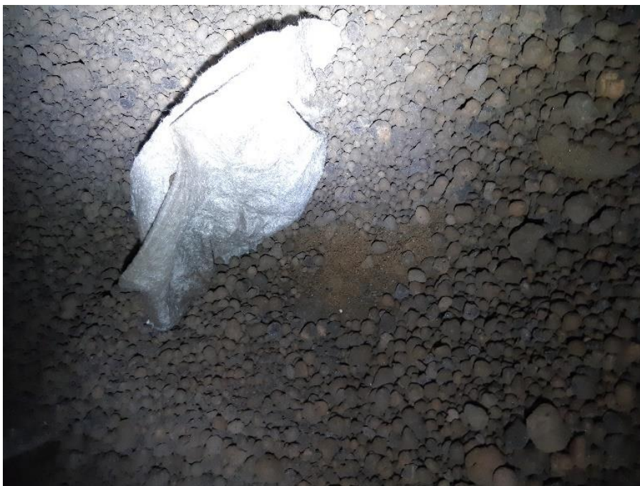
Kuva 7 RA4 kevytsorakerroksen alla puuttuu osittain suodatinkangas.
