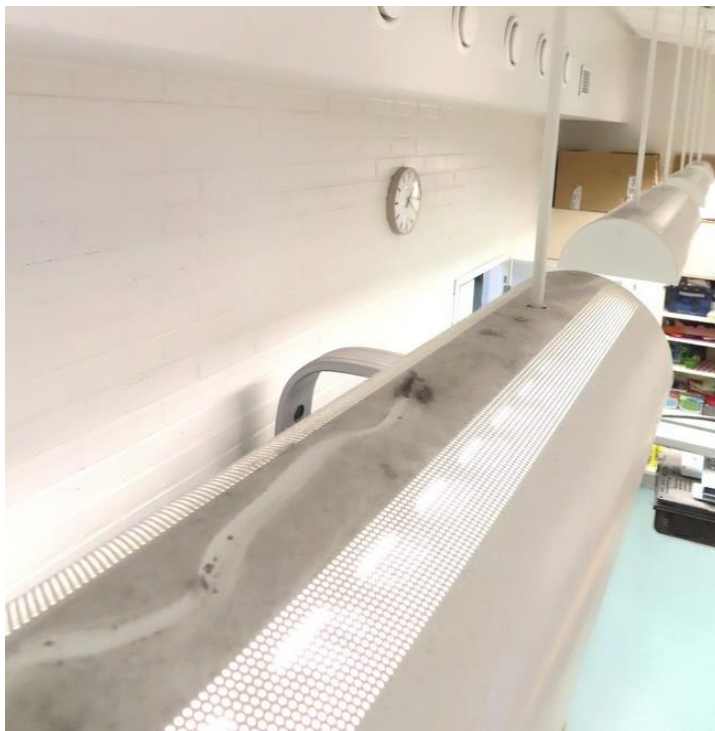
Kuva 18 Opetustilassa 016 oli erittäin paljon pölyä valaisimien yläpinnoilla.
