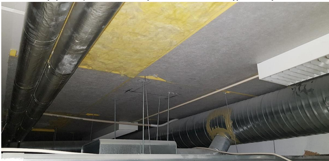
Kuva 5. Käytävällä 1061, tilassa 1062 katossa reunoilta ja paikoin alapinnalta pinnoittamatonta mineraalivillalevyä.
