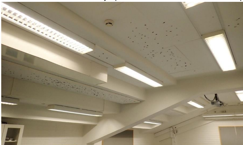
Kuva 8. Tilassa 1013 akustiikkalevytys oli rikkoontunut ja sen arvioidaan olevan sisäilman laatua heikentävä mineraalikuitulähde.
