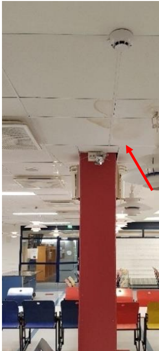
Kuva 22. Kosteusjälki ruokalan 1053 alakattolevyissä
