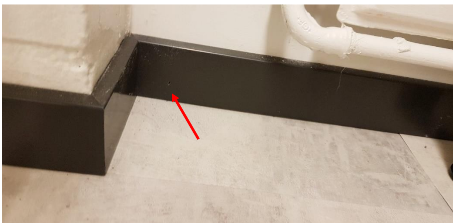
Kuva 17. Lattialistoja on paikoin asennettu nauloilla/ruuveilla seinäpintaan, joka on tiivistyskorjattu.
