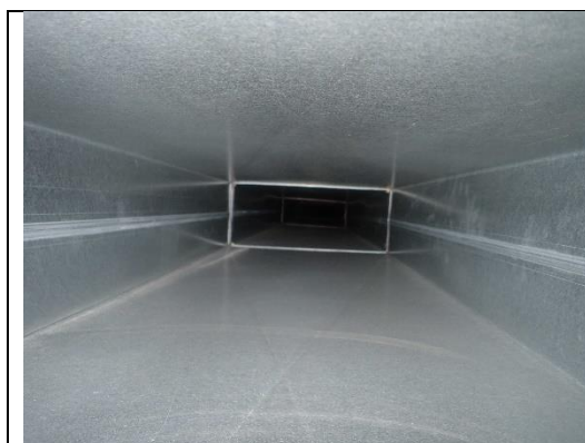
Kuva 28. Arviointipiste KP3, tuloilmakanava TK31, pölykertymäarvio alle 1 g/m 2 .
