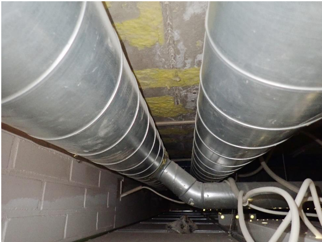
Kuva 4. Käytävältä 1095 tarkastettuna välipohjalaatan alapinnasta on poistettu akustiikkalevyt ja kattopinnassa on vain jäämiä mineraalivillalevyjen kiinnityksistä.
