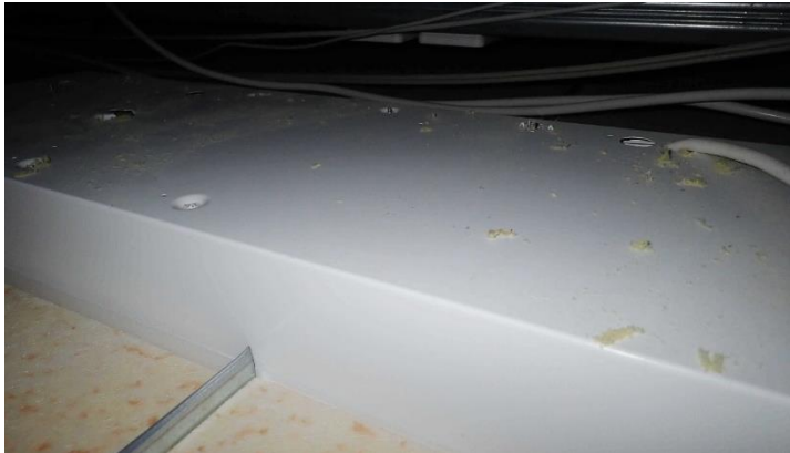
Kuva 6. Kokoelmatilan 1057 alakattolevyjen päällä kuitukankaalla päällystettyä mineraalivillalevyä. Alakattolevyn päällä oli sormipyyhkäisyllä arvioituna mineraalivillapölyä.
