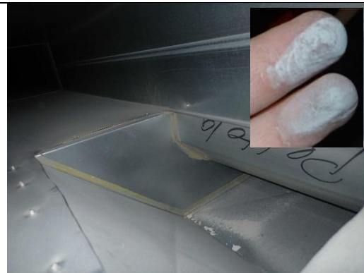
Kuva 32. Arviointipiste KP7, poistoilmakanava TK31, pölykertymäarvio 3-4 g/m 2 .
