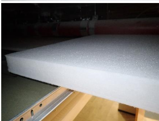
Kuvat 2 ja 3. Tilan 1096 alakaton tarkastusaukko. Alakattolevymateriaali pölyää herkästi. Mineraalivillaeristeitä ei havaittu.
