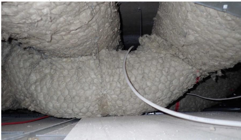
Kuva 7. Ilmanvaihtokanavia ympäröivät mineraalivillaeristeet ovat pinnoittamattomia.
