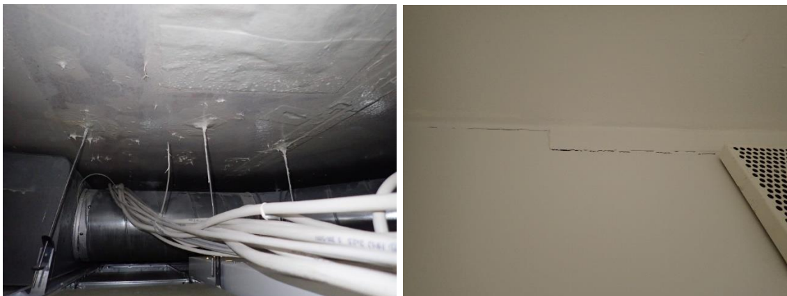
Kuva 16. Tilan 2027 lasketun katon yläpuolella ei havaittu aistinvaraisesti puutteita tiivistyksissä. Väliseinien liittymissä yläpohjaan havaittiin runsaasti rakoja useissa tiloissa, kuvassa tila 2026.
