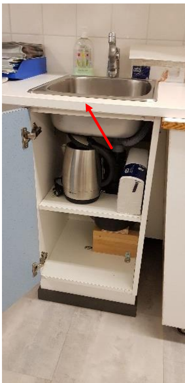
Kuva 23. Tiloissa 2033, 2034 viemäreiden hajua vesipisteiden putkien kohdalla.
