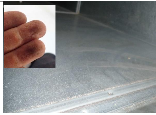
Kuva 33. Arviointipiste KP8, tuloilmakanava TK31, pölykertymäarvio alle 1 g/m 2 .
