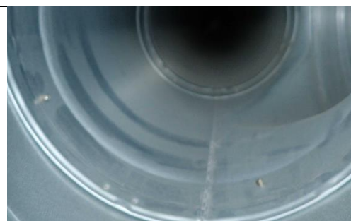
Kuva 30. Arviointipiste KP5, poistoilmakanava, tuloilmakone TK41, pölykertymäarvio alle 2 g/m 2 .
