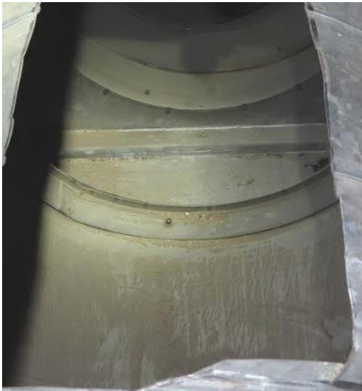
Kuva 27. Tuloilmakanava IV-konehuoneessa koneen TF01 jälkeen, sisäpinnan pölykertymäarvio oli 10-15 g/m 2 (arviointipiste KP1). Kauempana kanavassa arvio oli 2-4 g/m 2 .
