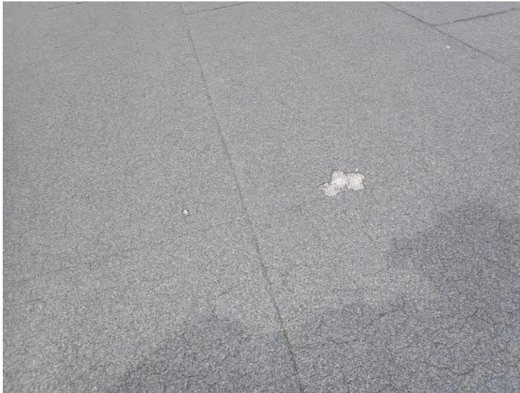
Kuva 18. Bitumikermikatteessa oli yksittäinen kohta, josta kermi oli erityisen kulunut. Em. kohdassa ei kuitenkaan alhaalta päin todettu viitteitä vesivuodosta. Vesikatolla oli vähäinen määrä metallijätettä (ruuveja).
