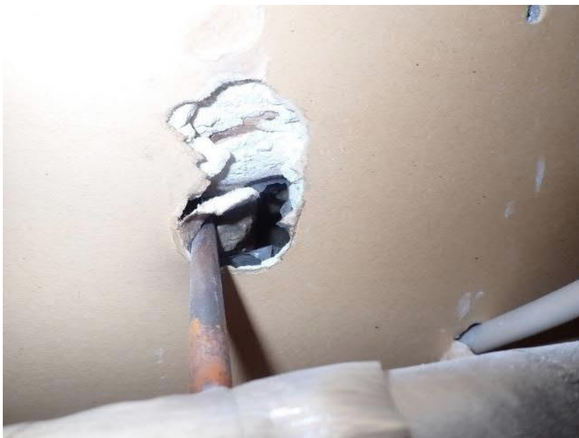
Kuva 22. Tilassa 117 (Sali) yläpohjan kotelorakenteessa on läpivientejä yläpohjan eriste-tilaan. Läpiviennit eivät ole ilmatiiviitä aistinvaraisen arvion perusteella.
