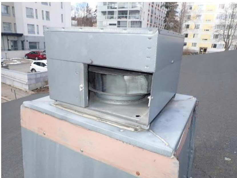
Kuva 17. Poistopuhaltimen pellitys on irronnut. Puhaltimen siivet ovat näkyvissä ja kosketettavissa.
