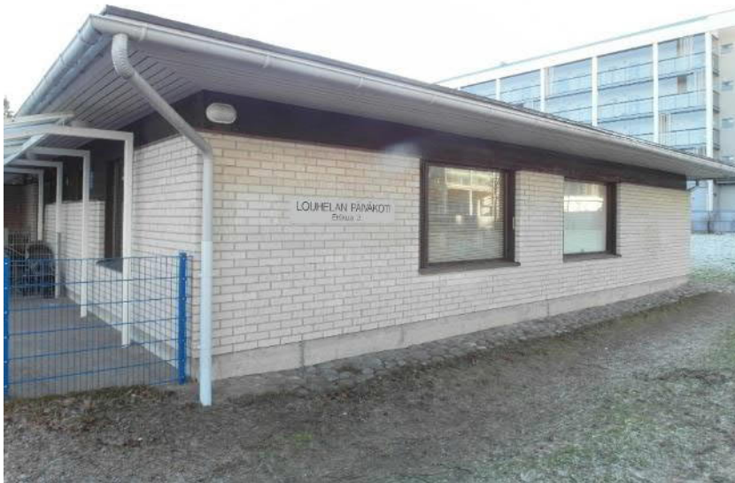
Kuva 5. Rakennuksen julkisivuna on tiilimuuraus. Ulkoseinän yläosassa on lautaverhoilu. Sokkelissa havaittiin yhdessä kohdassa paljas raudoitusteräs ja halkeama.
