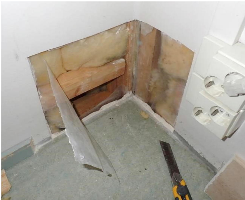
Kuva 7. Ulkoseinärakenteen alaohjauspuu ja sisäverhouskipsilevy ovat lattian betonilaattaa vasten. Mineraalivillakerroksen alaosissa todettiin useissa kohdin oletettavasti hiiren jätöksiä. Rakennusma- teriaaleissa ei todettu aistinvaraisesti poikkeavaa hajua tai värimuutoksia. Höyrynsulkumuovi on kiinnitetty niiteillä runkoon.
