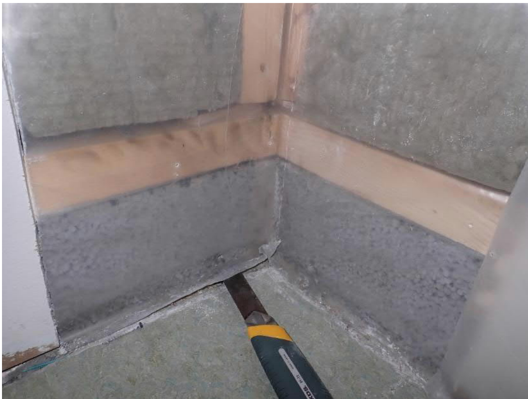
Kuva 8. Ulkoseinärakenteen alaohjauspuu on tietyiltä osin korjattu asentamalla kevytsoraharkko alaohjauspuun tilalle. Kevytsoraharkon ja nostetun alaohjauspuun välissä on kosteuseristeenä toimiva bitumikermi tai muovikalvo.
