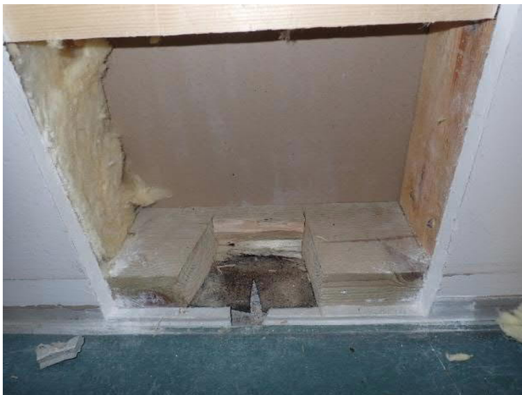
Kuva 11. Kuvassa kantava väliseinä. Väliseinärakenteen alaohjauspuu on tietyiltä osin korjattu asentamalla kevytsoraharkko alaohjauspuun tilalle. Kevytsoraharkon yläpinta on lattian betonilaa- tan yläpinnan tasolla. Kevytsoraharkon ja nostetun alaohjauspuun välissä on kosteuseristeenä toi- miva bitumikermi tai muovikalvo.
