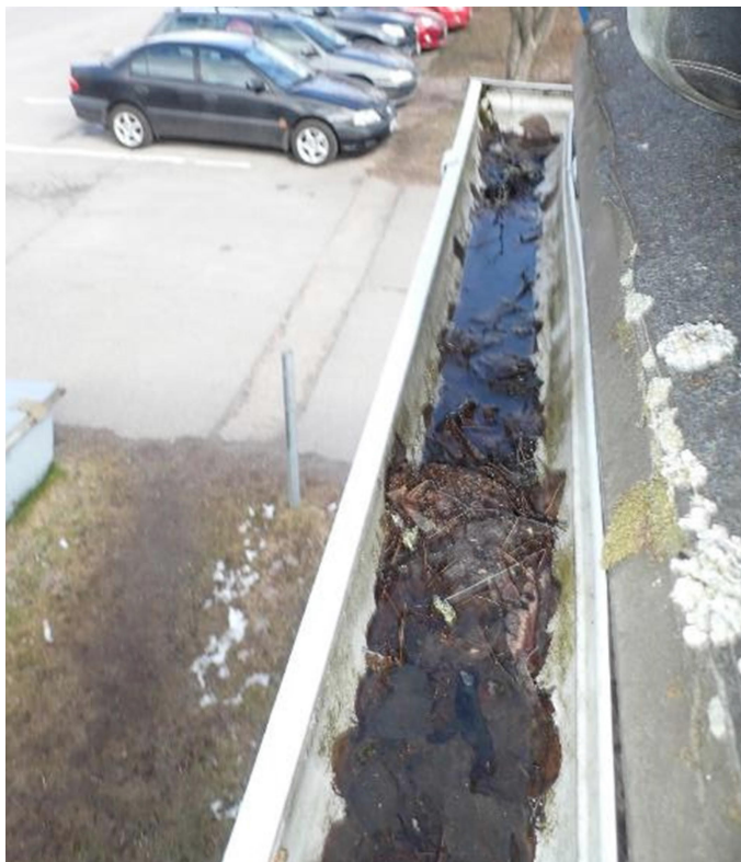
Kuva 19. Kattokourut olivat paikoin täynnä lehtiä ja muuta roskaa. Nykyisellään hulevesi patoutuu paikoin kouruihin.
