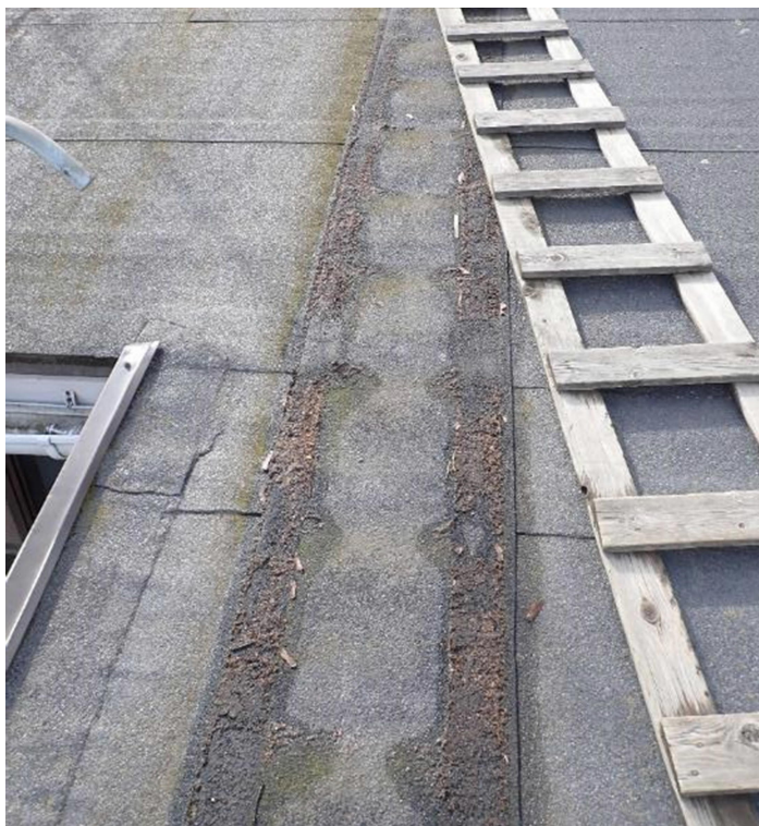
Kuva 20. Vesikatolla olevat kulkutikkaat ovat puiset. Tikkaiden kunto arvioidaan tyydyttäväksi. Tarvittaessa kulkutikkaat voidaan uusia metallisiin.
