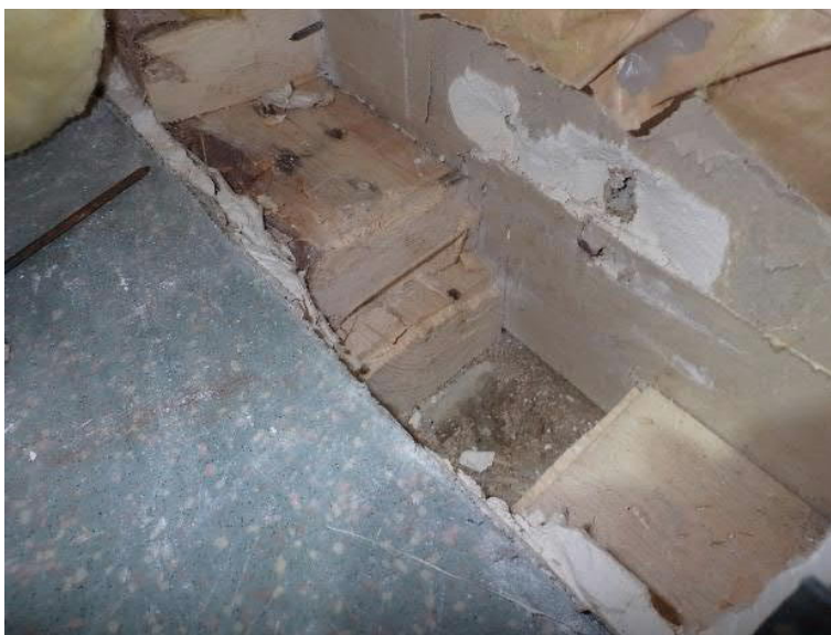
Kuva 12. Kuvassa kantava väliseinä siivoushuoneen ja suihkun välillä. Väliseinärakenteen alaoh- jauspuun päälle on asennettu kaksi lisäpuuta. Sekä siivoushuoneen että suihkun sisäverhouslevy- jen alapinta on alimman alaohjauspuun alapinnan tasolla. Avauksen rakennusmateriaaleissa ei to- dettu poikkeavaa hajua tai visuaalisia viitteitä kosteus- tai mikrobivauriosta. Alimman alaohjauspuun alla on muovikalvo.
