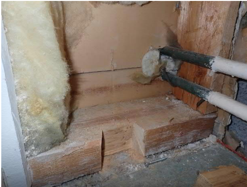
Kuva 10. Kuvassa ei-kantava väliseinä. Väliseinärakenteen alaohjauspuu on tietyiltä osin korjattu asentamalla kevytsoraharkko alaohjauspuun tilalle. Kevytsoraharkon yläpinta on lattian betonilaa- tan yläpinnan tasolla. Kevytsoraharkon ja nostetun alaohjauspuun välissä on kosteuseristeenä toimiva bitumikermi tai muovikalvo.
