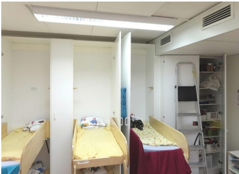
Kuva 37. Tila 105, jossa sänkykaappien ovien ollessa auki kaapin ovi estää toisen tuloilmalaitteen tuloilman kulkua tilaan.
