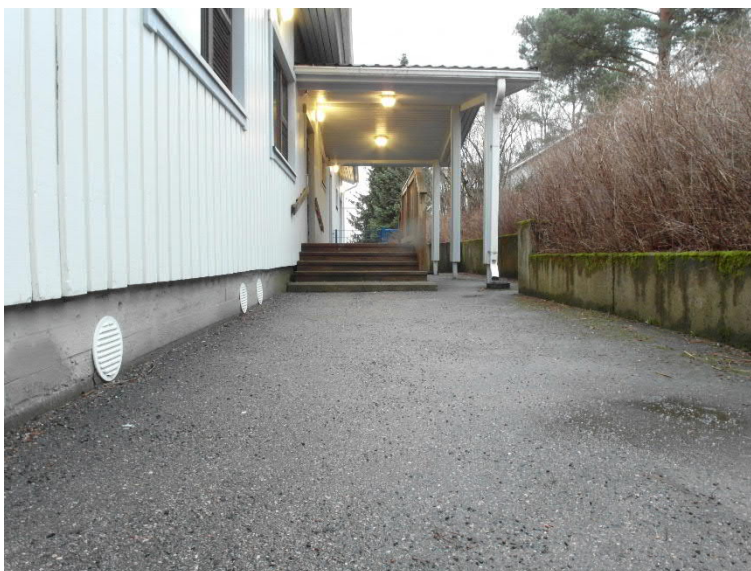
Kuva 30. Rakennuksen eteläsivulla maapinta on asfaltoitu. Muilla julkisivuilla sokkelin vieressä on maanpintana hiekka. Rakennuksen sokkelissa ei havaittu patolevyä. Yläpihan tukimuurin pinnalla oli havaittavissa paljon kasvustoa.
