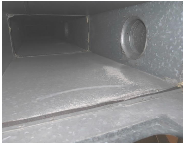
Kuva 34. Tuloilmakanava tilassa 114, sisäpinnan pölykertymäarvio oli 1-3 g/m 2 (arviointipiste KP4). Lisäksi kanavan pohjalla oli paikallinen hiekka- tai muu pölykasautuma.
