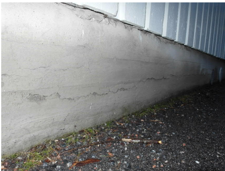
Kuva 12. Vaakahalkeama sokkelissa eteläjulkisivulla. Raudoiteteräkset paljastuvat suojabetonin alta.
