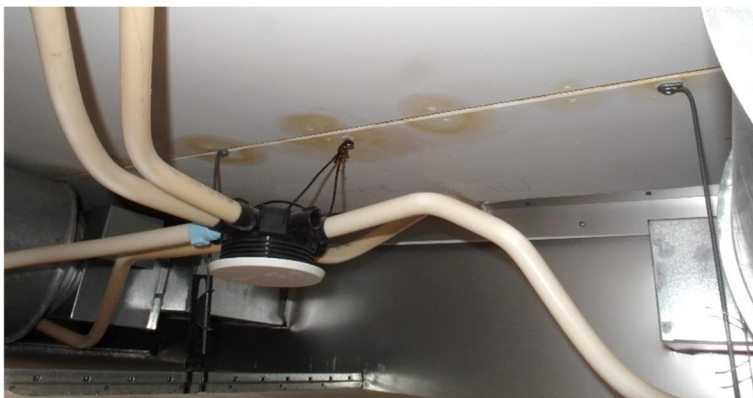
Kuva 28. Vesivuotojälkiä tilassa 116 alakaton yläpuolella.
