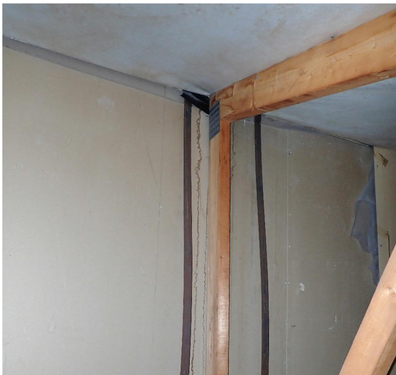
Kuva 25. Vesivuotojälkiä IV-konehuoneen rakennuslevyn ulkopinnassa, vesikaton liittymässä.
