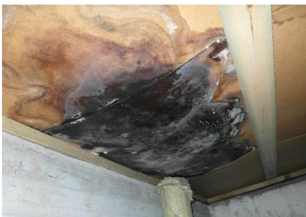
Kuva 4. Siivoustilan 122 kohdalla ryömintätilassa todettiin aktiivinen vesivuoto. Ryömintätilassa ei todettu muissa kohdin aktiivisia vesivuotoja.
