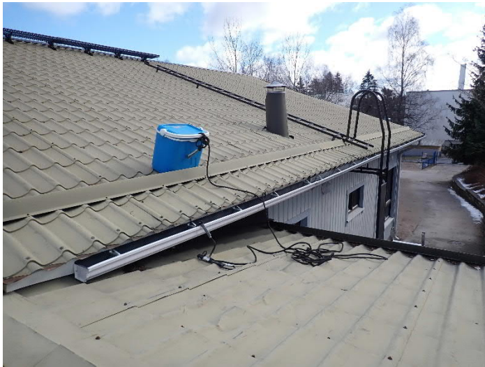
Kuva 21 . Yleiskuva vesikatolta. Katolla on tarpeelliset turvavarusteet. Turvavarusteiden kiinnityssruuvit läpäisevät vesikatteen.
