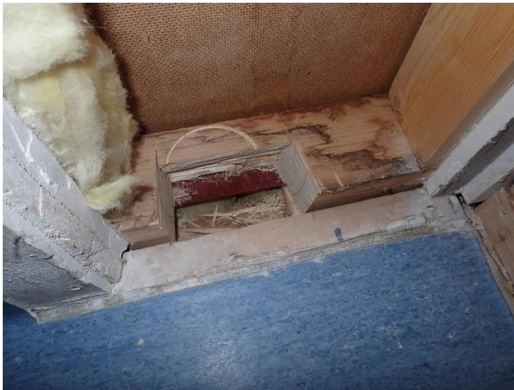
Kuva 19. Kuvassa tilojen 114 (WC) ja 116 (leikkihuone) väliseinä. Väliseinäarakenteen sisällä rakennuslevyn ja alaohjauspuun pinnoilla on nähtävissä vanhoja vesivuotojälkiä. Alaohjauspuun alla on tilaelementin teräskehikon palkki ja sen alla suoraan lattian lämmöneristemineraalivilla.
