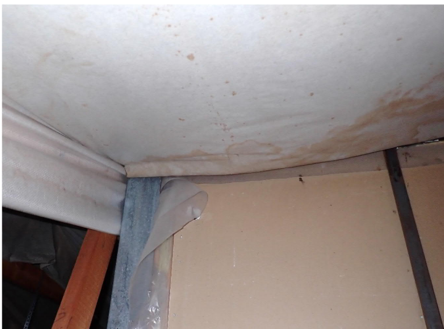
Kuva 26. Vesivuotojälkiä aluskatteessa IV-konehuoneen ja vesikaton liittymässä.
