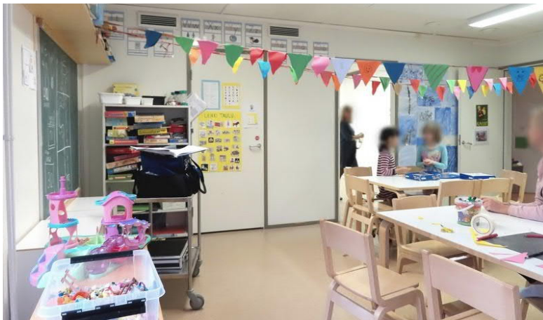
Kuva 37. Tila 103, jossa tuloilman päätelaitteiden edessä ei ole esteitä.
