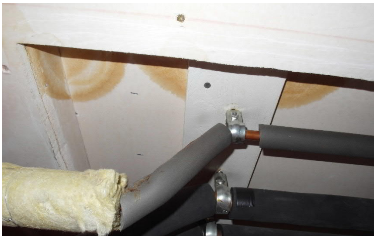
Kuva 27. Vesivuotojälkiä tilassa 113 alakaton yläpuolella.
