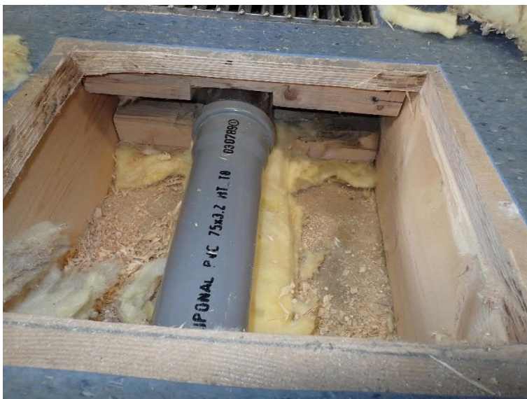
Kuva 8. Esimerkki alapohjarakenteen rakenneavauksesta. Kuraeteisen 101 lattian rakenneavaus hiekanerotuskaivon vierestä. Puussa ja mineraalivillassa oli tummentumia, jotka mikrobitutkimuksen perusteella olivat mikrobikasvustoa. Mineraalivillan tummentumat ovat osittain seurausta ilmavuodoista.
