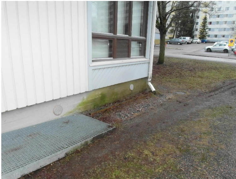
Kuva 31. Räystäskourujen syöksyputkien kohdalla sokkelissa oli vesivuotojälkiä ja paikoin kasvusto. Sokkelin paikallinen kastuminen johtuu pääasiassa vesivuodoista syöksyputkissa ja roiskeve- sistä.
