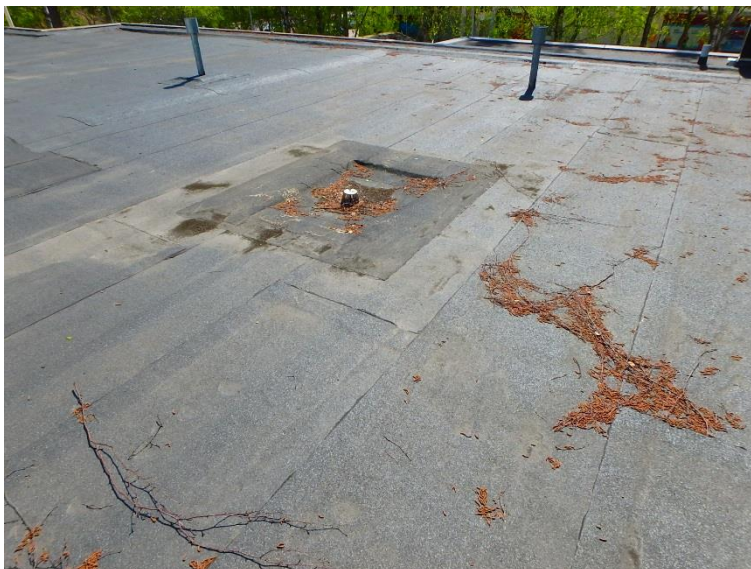
Kuva 20. Vesikatolle oli kerääntynyt lehtiä ja risuja, jotka tukkivat kattokaivot.
