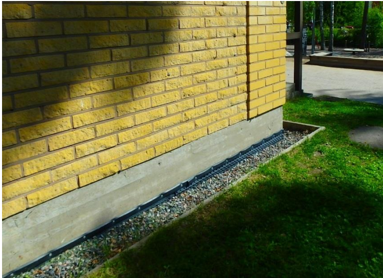
Kuva 35. Rakennuksen itä- ja etelä-julkisivut kaatavat poispäin rakennuksesta.
