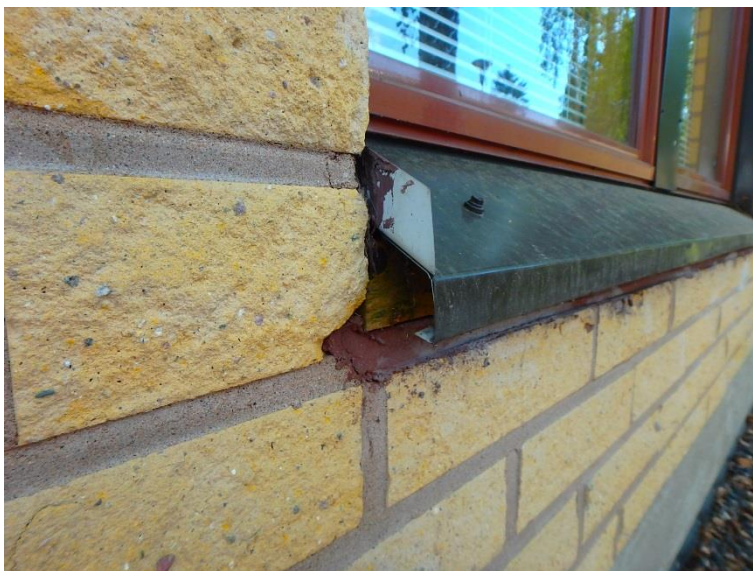
Kuva 23. Ikkunan vesipelti kaatoi reilusti pois päin julkisivusta.
