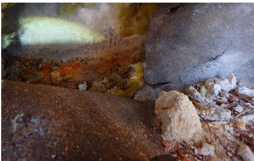
Kuva 10. Ulkoseinään tehdyssä avauksissa 2 havaittiin lahonnutta kovalevyä. Avauksessa oli kermi sokkelin ja tiilimuurauksen välissä
