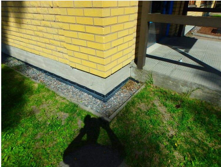
Kuva 6. Sokkelin vieressä on pesty sepeli. Sokkelissa on patolevyt maanpinnan alapuoleisissa osissa.
