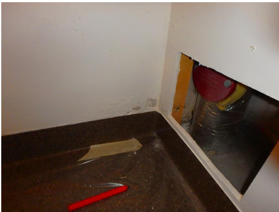
Kuva 18. Sadevesiviemärin viereisessä seinässä havaittiin hieman kohonneita pintakosteuslukemia, sekä vähäistä pinnoitteiden irtoamista.
