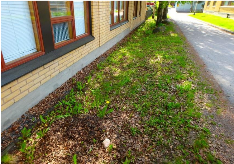
Kuva 24. Rakennuksen länsisivu viettää jyrkästi kohti rakennusta ja sokkelin vierus sepeli oli peittynyt lehdillä.
