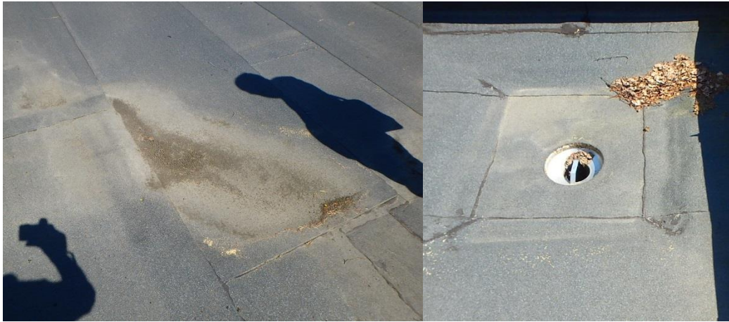
Kuvat 21 ja 22. Vesikatolla oli jälkiä veden paikallisesta lammikoitumisesta. Yhdestä kattokaivosta puuttui roskasihti.
