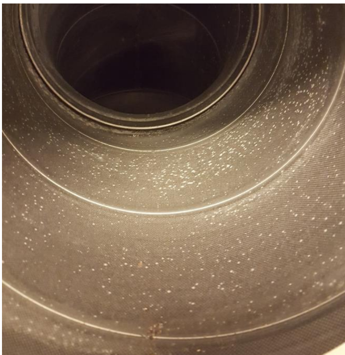
Kuva 32. Ilmanvaihtokonehuone (huone 43) (KP4).
