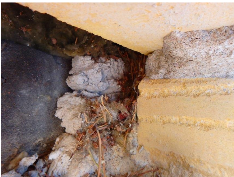
Kuva 15. Ulkoseinäavauksessa 2 havaittiin orgaanista jätettä (havuja yms.) julkisivumuurausten takana.
