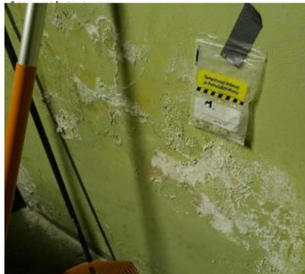
Kuva 6. Talon varasto ulkoiluvälineille 143. Näyte seinän vaurioalueelta.
