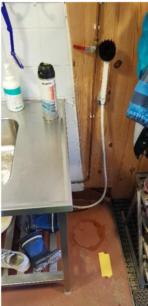
Kuvat 3 Kuraeteinen A117, jossa käsisuihkun käytöstä pääsee vettä muovimattopinnan alle. Muovimaton ylösnosto seinää/puupalkkia vasten on irti.
