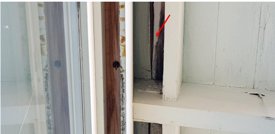
Kuvat 19-22. Vesikatteen pellityksen vaakasaumassa lähellä räystästä on koloja lähellä räystästä. Pellitysten saumojen arvioidaan olevan syynä vesivuotoihin. Tilan B138 kohdalla aluskatemuovi päättyi ennen räystäään otsalautoitusta. Tilan B139 kohdalla aluskatemuovi päättyi osittain jo ennen ulkoseinän ulkopintaa.
