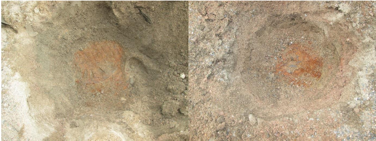
Kuva 1 ja 2: Ritaläkännellä varustettuja sadevesikaivoja hiekan alla (noin 30cm).
