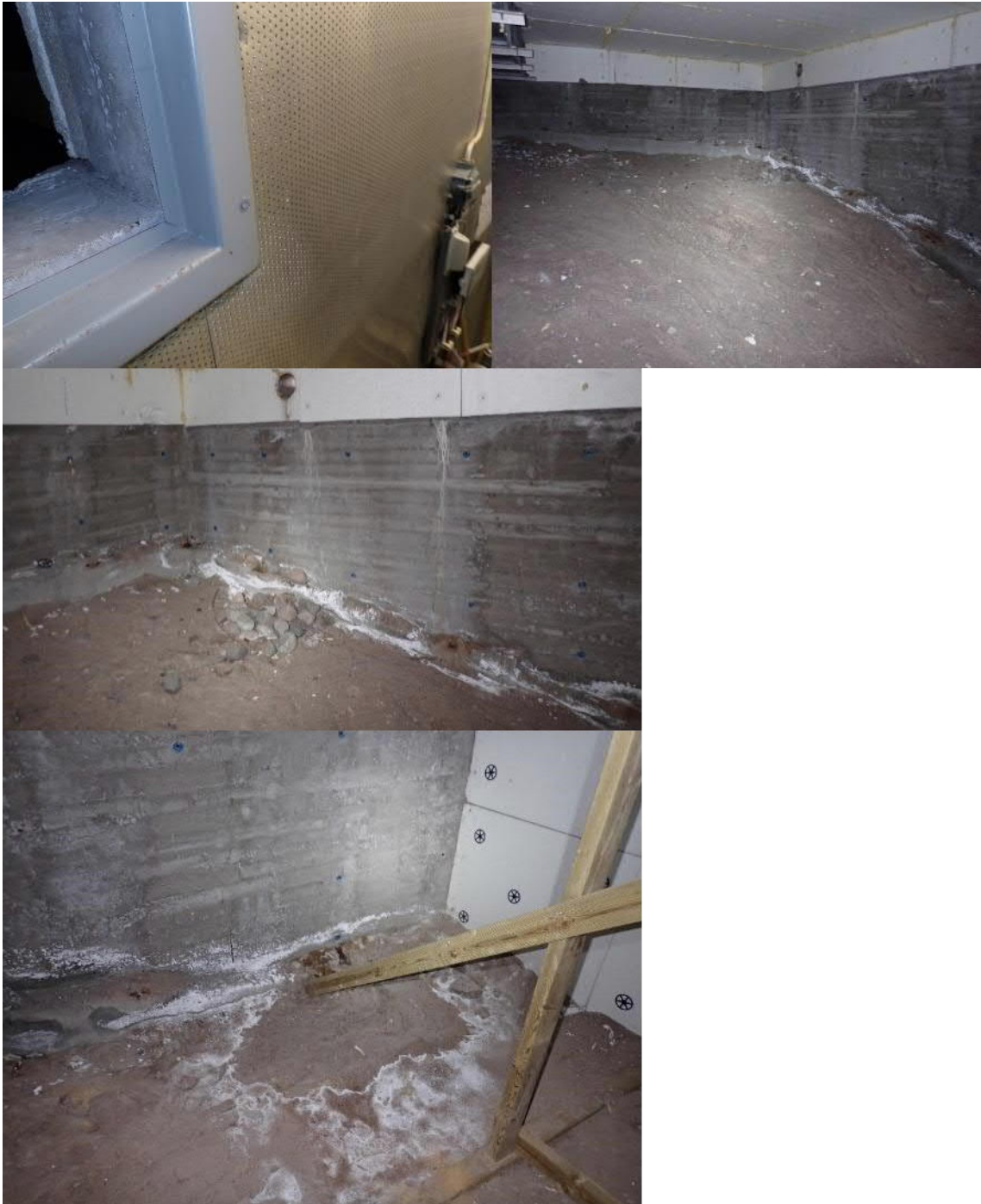
Kuvat 9, 10, 11 ja 12. Yleiskuvia IV-konehuoneen viereisestä ryömintätilasta. Tilassa oli jonkin verran mikrobivaurioituneita rakennusmateriaaleja, paljon vanhoja vesivuotojälkiä ja niistä tullutta kalkkihärmettä. Käyntiluukussa ei ole tiivisteitä.
