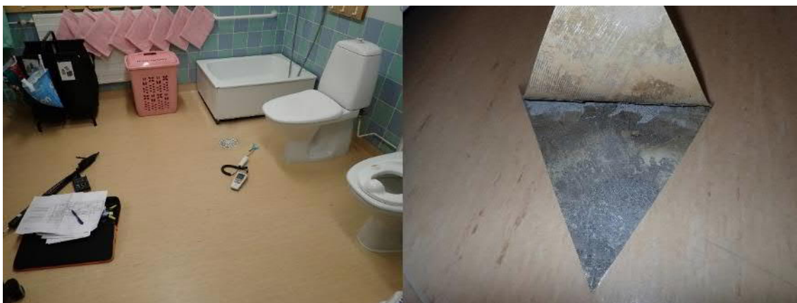
Kuvat 7 ja 8. Pesuhuoneessa 13 lattiarakenne oli pinnoitteen alta, betonilaatasta ja maaperästä märkä kosteusmittausten perusteella.
