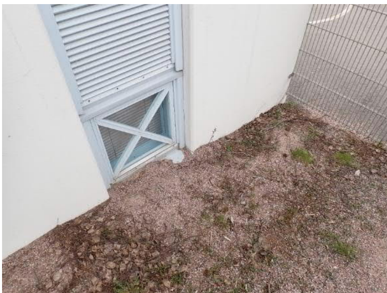
Kuva 30. Rakennuksen länsijulkisivulla maanpintaa on ilmeisesti nostettu hiekalla niin, että ikkunan vesipelti on hiekan alla. Nykytilanteessa on todennäköistä, että sateella ikkunarakenteen kosteusrasitus on hyvin korkea. Sisäpuolelta ikkunassa ei kuitenkaan tutkimushetkellä havaittu vaurioita.
