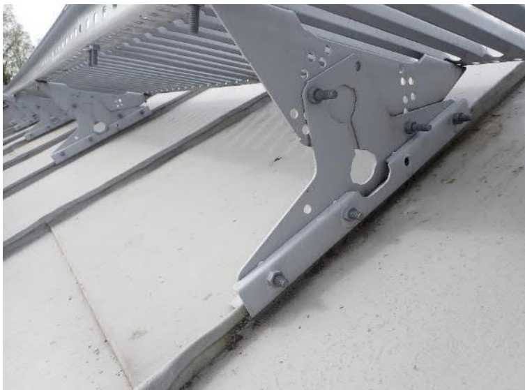
Kuva 47. Kattosillat ovat kiinnitetty vesikatteeseen asiamukaisesti puristamalla peltikatteen saumoihin.
