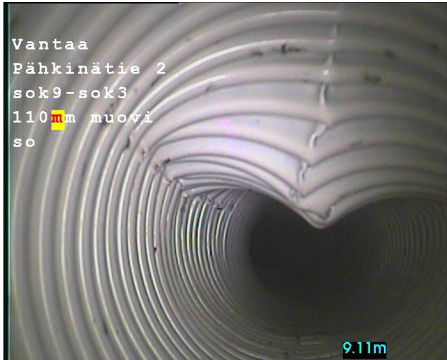
Kuva 3: Kohtalainen muodonmuutos, KUNTOLUOKKA 3.
