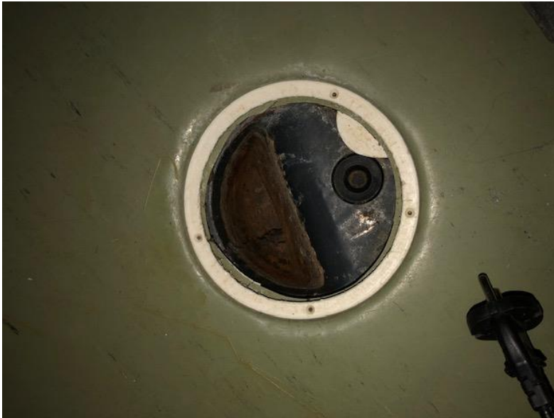
Kuva 8. Muovisissa kuivakaivoissa aiheuttavat lievää hajuhaitta.
