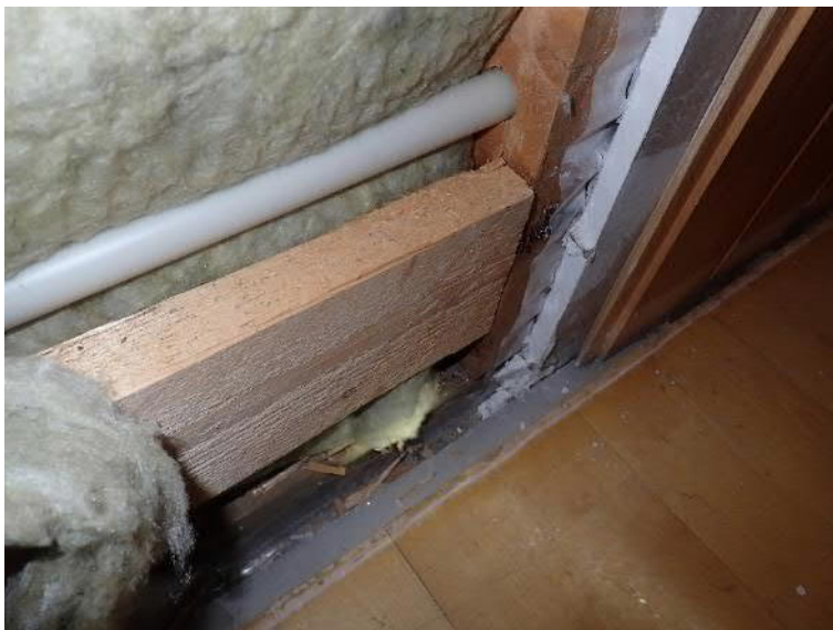
Kuva 33. 2. kerroksen ulkoseinien sisäverhouskipsilevy alkaa lattian ontelolaatan yläpinnasta eli kipsilevy on pintabetonivalua vasten. Näistä kohdista otetuissa materiaalinäytteissä ei kuitenkaan todettu mikrobikasvustoa.
