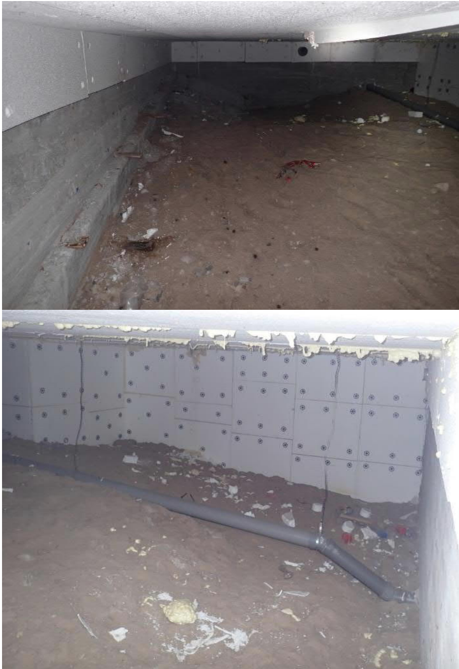
Kuvat 13 ja 14. Yleiskuvia liikuntasalin 67 alapuolisesta ryömintätilasta. Tilassa oli jonkin verran rakennusjätettä rakennusmateriaaleja ja roskaa. Pohjalla lepäävä viemäriputki on kannakoitu reikävanteella. Reikävanne näyttäisi olevan löysällä, mikä viittaa siihen, että viemäriputki on pudonnut aikaisemmasta korostaan pohjalle.
