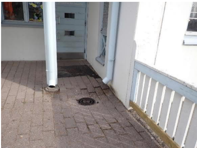
Kuva 29. Loiskekuppien puute ja pieni heittopituus räystäskourujen syöksyputkissa lisäävät ulkoseinän kosteusrasitusta.
