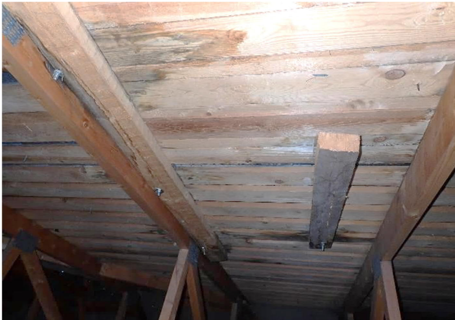
Kuva 59. Ruodelautojen tummentumia ja värimuutoksia.
