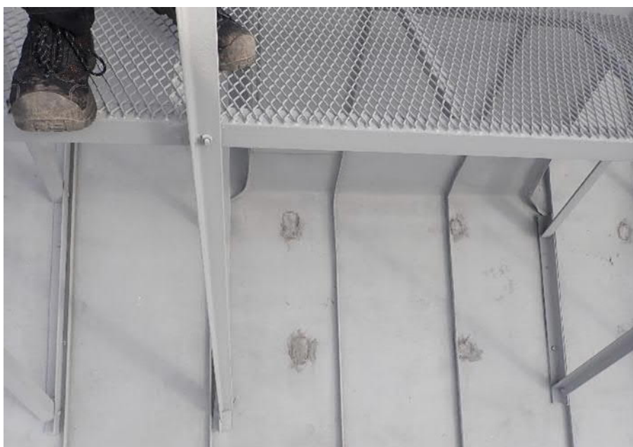
Kuvat 49 ja 50. Yllä yleiskuva vesikaton etelälapeelta. Kuvassa näkyy kaksi ilmanvaihtokoneiston puhallinta, joiden huoltotasojen tukien kiinnikkeet ovat puhkaisseet vesikatteen. Alla lähikuva huoltason vanhojen tukien paikatuista jäljistä vesikatteessa. Em. kohdilla vesikatteen puuosissa oli paljon värimuutoksia ja tummentumia, mitkä viittaavat vanhoihin vesivuotoihin.
