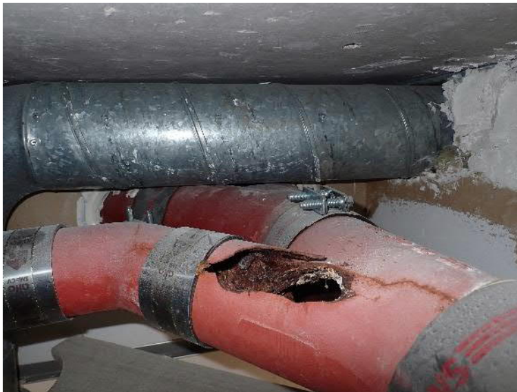
Kuva 41. 1. kerroksen katon välipohjassa (tila 10) oli vesivuotojälkiä alakattolevyissä sekä talotekniikan pinnoilla. Viemäri- ja vesiputkissa oli erityisen paljon vesivuotojälkiä. Viemäriputkissa oli halkeamia ja yksi iso reikä yläpinnassa.
