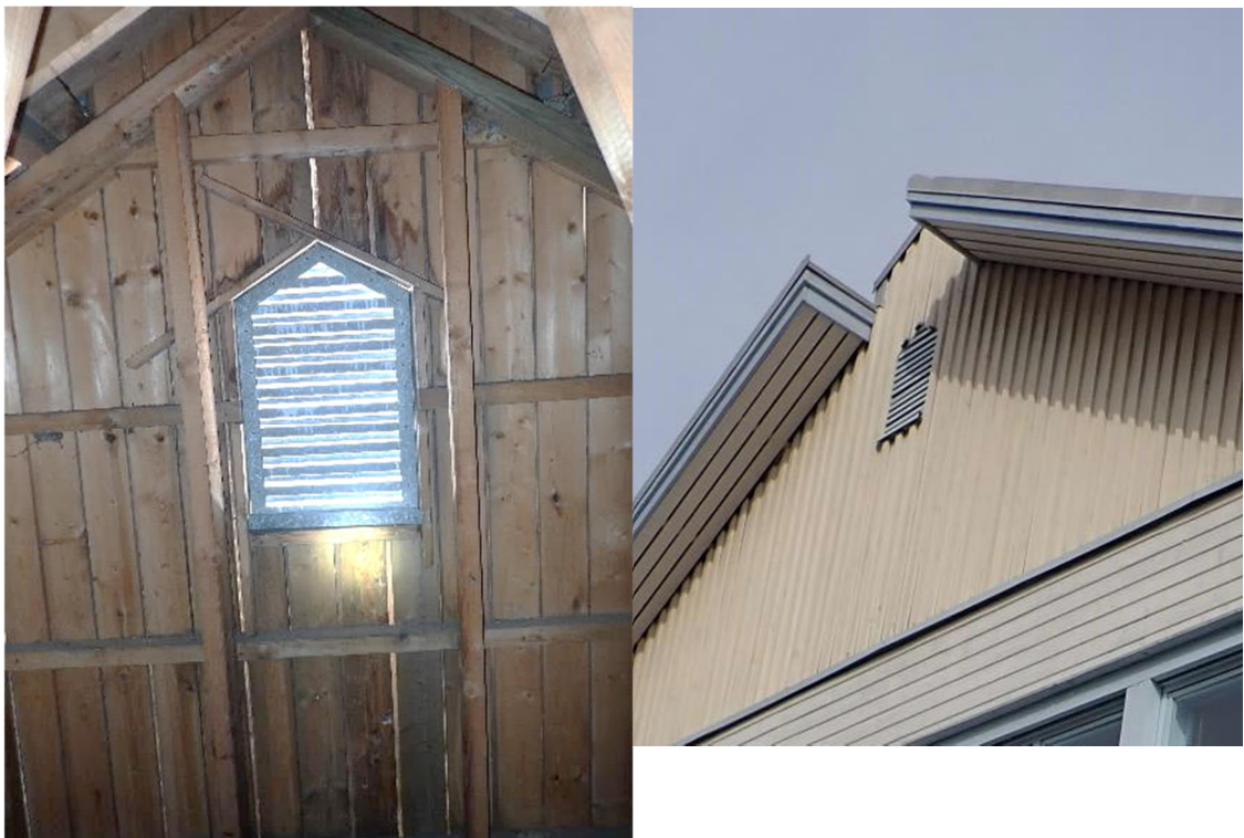
Kuvat 60 ja 61. Yläpohjan tuuletussäleikköjen kohdalla ulkoseinän laudoituksessa havaittiin vanhoja vesivalumajälkiä. Säleikköjen kohdalla ei ole räystästä.
