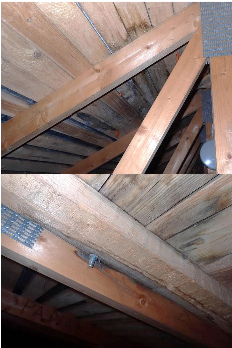
Kuvat 57 ja 58. Kattoruoteissa ja muissa vesikatteen puuosissa oli havaittavissa tummentumia ja värimuutoksia. Piikkimittausten perusteella näissä ei kuitenkaan todettu kohonnutta kosteutta.
