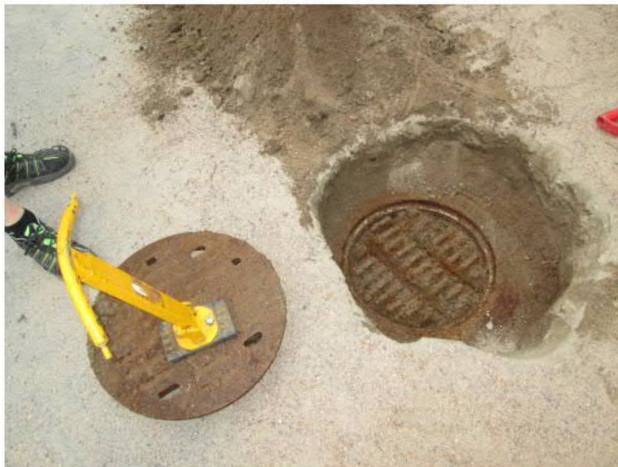
Kuvat 69. Sadevesikaivojen kannet olivat paikoin syvällä hiekan alla.
