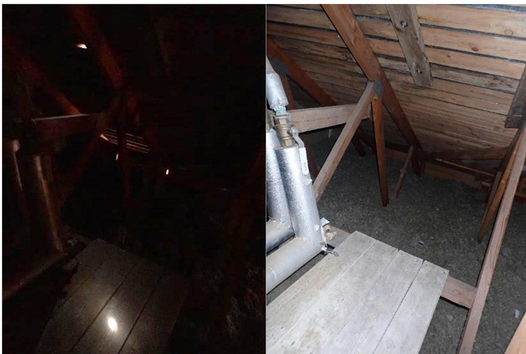
Kuvat 62 ja 63. Vesikatteessa havaittiin yksi reikä etelälappeella. Sama reikä on havaittu vuoden 2015 tutkimuksissa.
