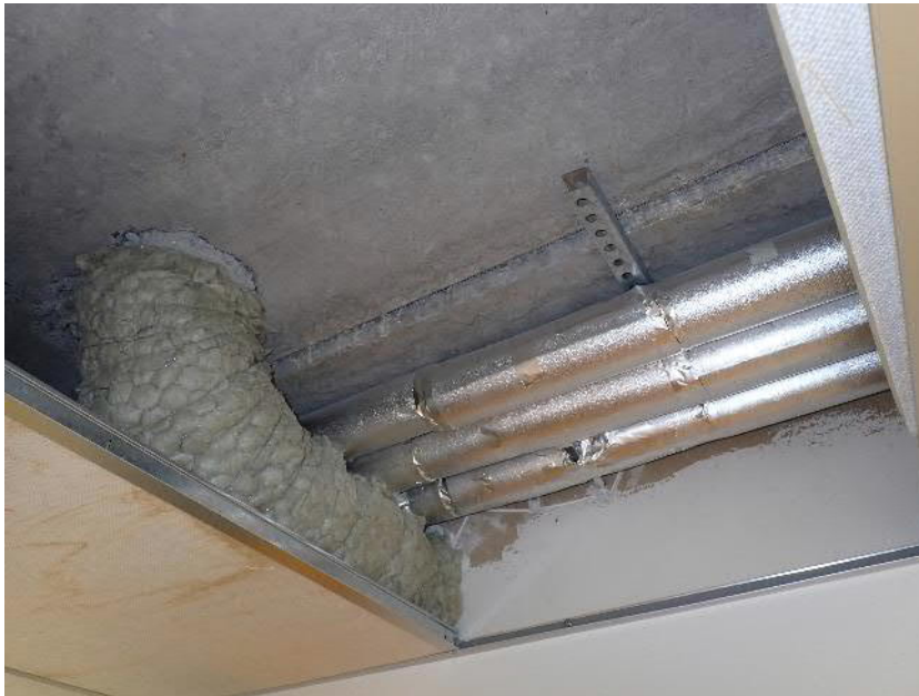
Kuva 40. 1. kerroksen katon välipohjassa (tila 14) oli oletettavasti vettä joskus vuotaneita läpivientejä. Ontelolaattojen saumassa on vanhoja vesivuotojälkiä. Välipohjassa ei todettu viitteitä kohonneesta rakennekosteudesta pintailmaisella.
