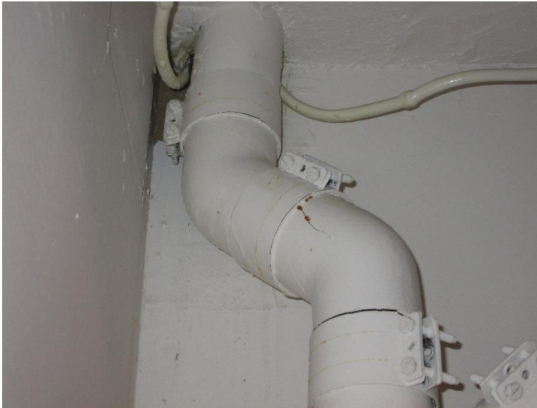
Kuva 1. Halkeama pystyviemärimässä Keltasirkkujen työhuoneen varastokomeroissa.
