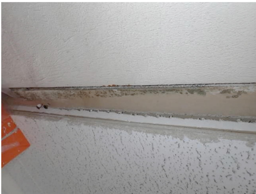
Kuva 66. Tilassa 52 yläpohjassa teräspalkin vieressä havaittiin kipsilevyssä pilkutusta, joka aistinvaraisesti vaikutti mikrobikasvustolta. Laboratorioanalyysissä näytteestä ei todettu mikrobikasvustoa.
