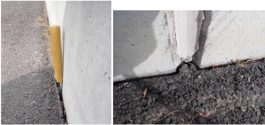
Kuvat 25, 26 ja 27. Ulkoseinän liittymät maapinnan asfaltointiin ovat epätiivisiä. Elementtisaumat on uusittu 2015 sisäilmatutkimusten jälkeen. Ulkoseinässä ei havaittu patolevyä.
