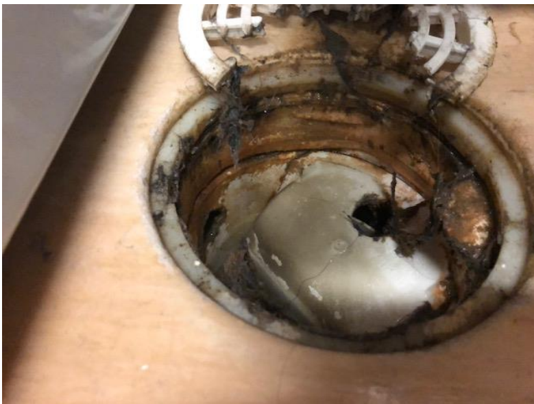
Kuva 9. Yläkerran siivouskomeron lattiakaivosta puuttuu tulppa.
