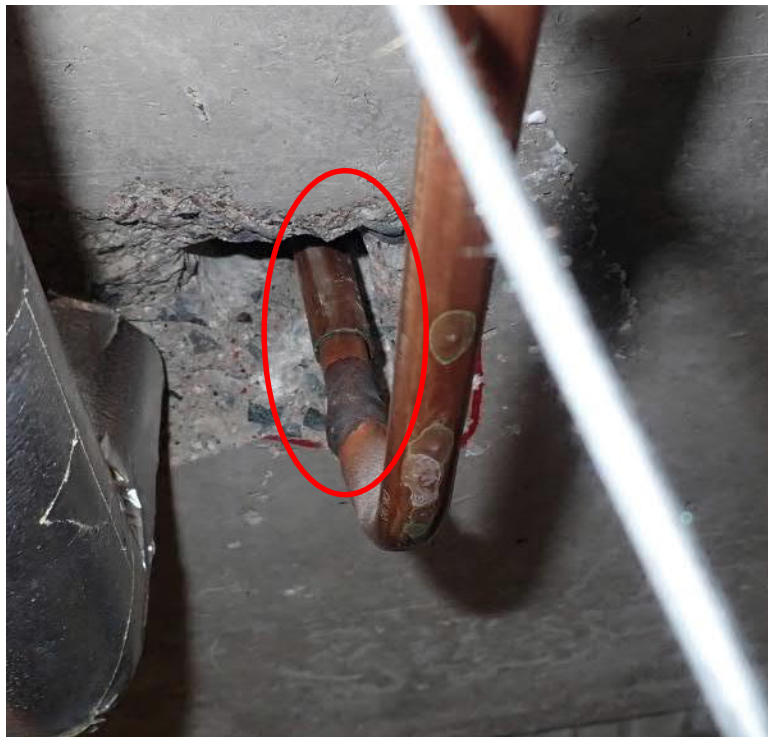
Kuva 42. Tilassa 10 yksi vesijohto on asennettu niin, että vesivuotojen todennäköisyys on suuri. Putken ylempi osa on limitetty alemman osan ulkopuolelle. Asennus tulisi tehdä toisin päin.
