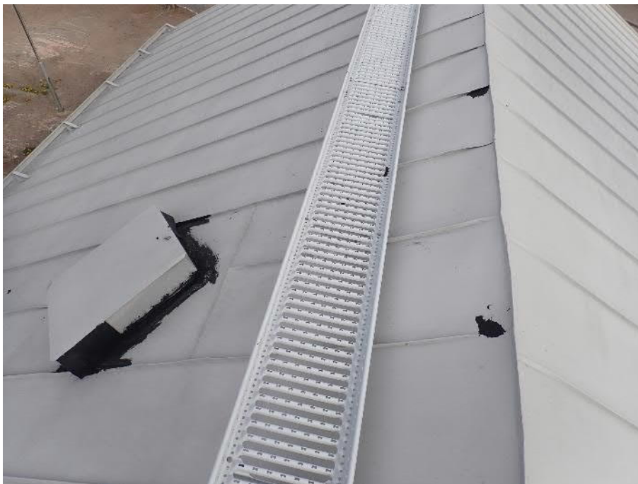
Kuva 51. Käyntiluukkuja yläpohjan eristetilaan on tiivistetty massalla. Vesikatteeen pintaa on paikoin myös tiivistetty.
