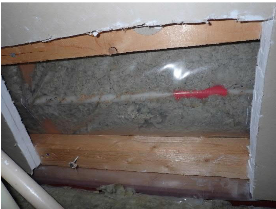
Kuvat 64 ja 65. Yleiskuvia tilan 62 yläpohjan rakenneavauksesta. Yläpohjan I-palkin kohdalla höyrinsulkumuovia ei ole limitetty tai teipattu, ja siitä on suora ilmayhteys sisäilmaan. alakattolevyissä oli palkin suuntaisesti vesivuotojälkiä koko huoneen pituudella.
