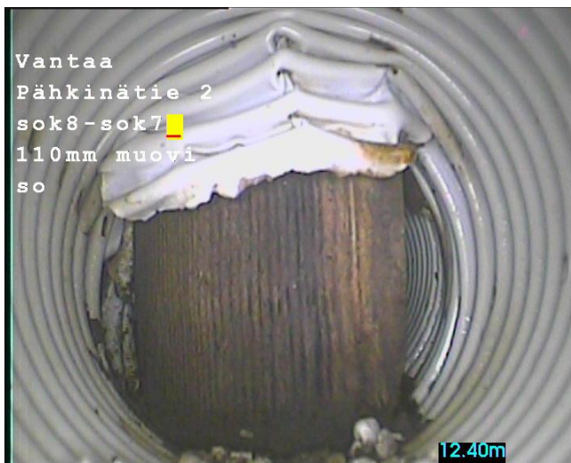
Kuva 4: Puu paalu putken läpi, KUNTOLUOKKA 4.
