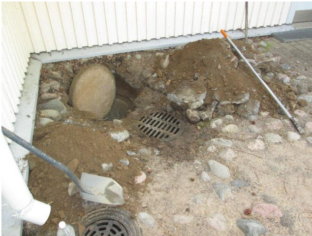
Kuva 6: Kaivo SOK 3 otettuna esille betonin ja kivien alta.
