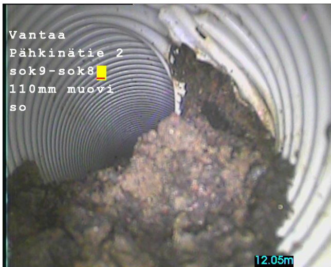
Kuva 2: Reikä putken seinämässä, josta valuu hiekka putken sisälle KUNTOLUOKKA 3.
