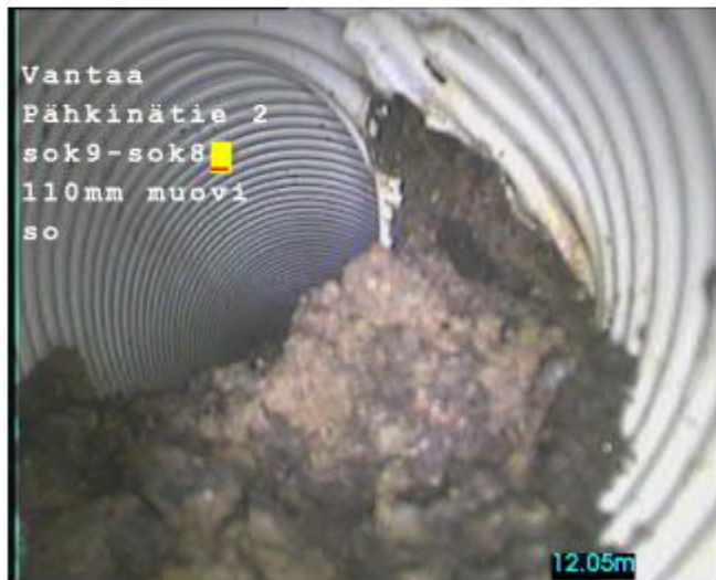
Kuvat 67 ja 68. Kuvia salaojien vaurioista.
