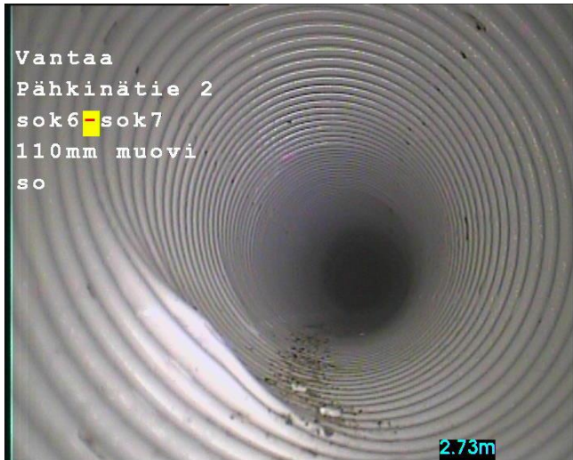
Kuva 1: vähäinen muodonmuutos putken seinämässä KUNTOLUOKKA 2.
