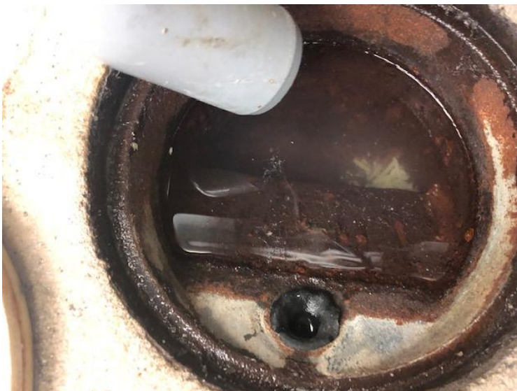
Kuva 7. Valurautakaivot ovat ruosteessa, mutta toiminnaltaan kunnossa.
