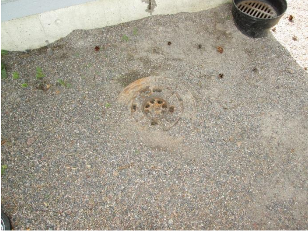
Kuva 4: SVK täynnä hiekkaa.
