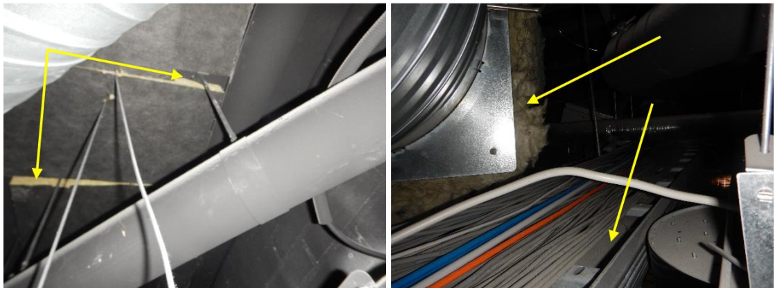
Kuva 24a ja b. Vasemman puoleisessa kuvassa on esitetty odotustilan kohdalla alakattotilassa todetut avonaiset akustolevyjen villapinnat ja oikean puoleisessa kuvassa odotustilan alakattotilassa iso alue vapaata villapintaa ilmanvaihtojärjestelmän eristeissä. Alakattotilan sähköarinoiden päälle on kertynyt runsaasti pölyä.
