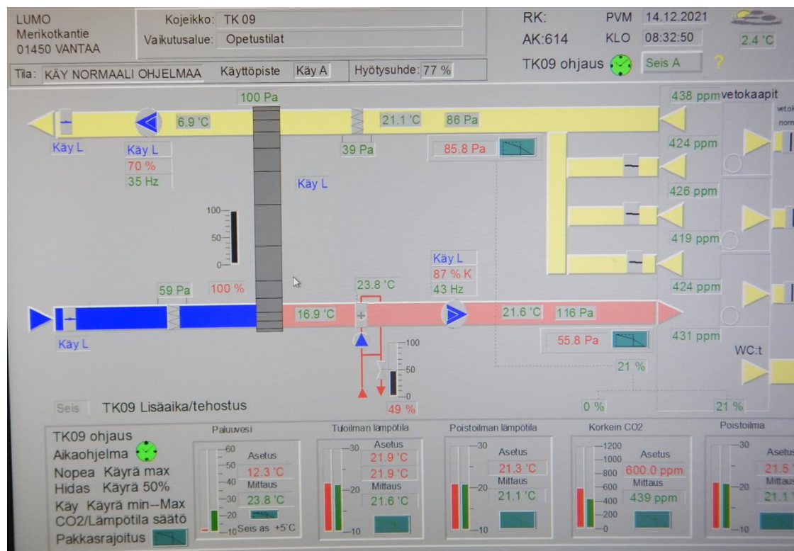
Kuva 35. Ilmanvaihtokoneen TK09 valvomopäätteeltä otettu valokuva ilmanvaihtokoneen asetuksista 14.12.2021 noin klo 8:30.
