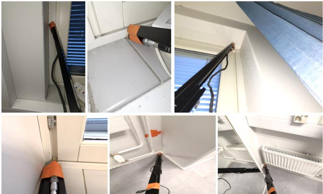
Kuva 33a - f. Valokuvia apulaisrehtorin huoneen ulkoseinän merkkiainekokeessa todetuista ilmavuodoista noin -2 Pa alipainetilanteessa. Ylärivissä vasemmanpuoleisessa kuvassa on esitetty ilmavuotokohta ikkunasmyygin ja peitelistan välistä, keskimmaisessä kuvassa ilmavuotokohta ikkunapenkin ja peitelistan välistä ja oikeanpuoleisessa kuvassa ilmavuotokohta ikkunan ylityspalkin ja peitelistan välistä. Alarivissä vasemmanpuoleisessa kuvassa on esitetty ilmavuotokohta ikkunakarmin puuliitoksista, keskimmaisessä kuvassa ilmavuotokohta seinän ja lattian liitoksesta väliseinän vieressä ja oikeanpuoleisessa kuvassa ilmavuotokohta seinän ja lattian liitoksesta pilarin vieressä.
