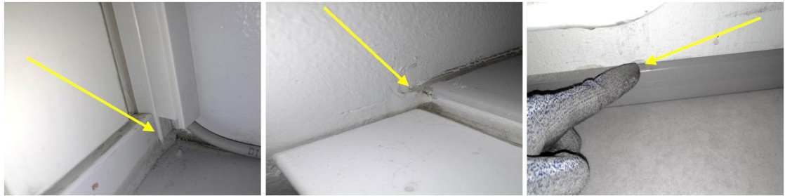
Kuva 32a - c. Valokuvia rehtorin huoneen ulkoseinän merkkiainekokeessa todetuista ilmavuodoista noin -2 Pa alipainetilanteessa. Vasemmanpuoleisessa kuvassa on esitetty ilmavuotokohta ikkunan alaosan karmin puuliitoksista, keskimmaisessä kuvassa pistemäinen ilmavuotokohta ikkunapenkin alta (massauksessa rako) ja oikeanpuoleisessa kuvassa ilmavuotokohta lattia-seinäliitymässä.
