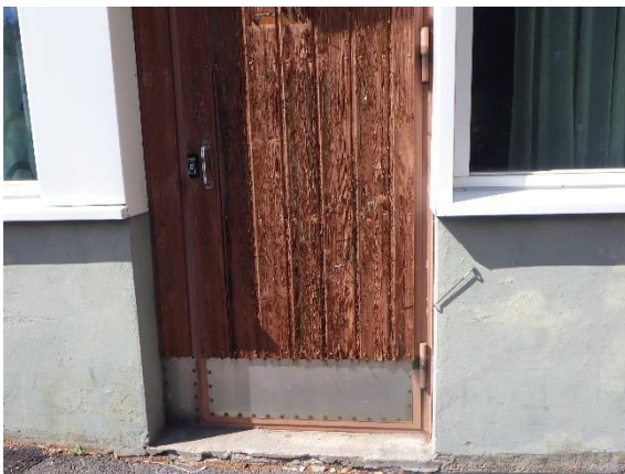
Kuva 59. E-sisäänkäynnin ulko-oven puuosat ovat haristuneet ja kynnys pellittämättä
