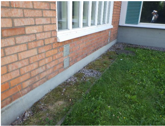
Kuva 4. Takasivulla rakennuksen sokkelin vierustalla on sora, pieneltä osin sammal / nurmikko on levittäytynyt sora-alueelle B-osalla
