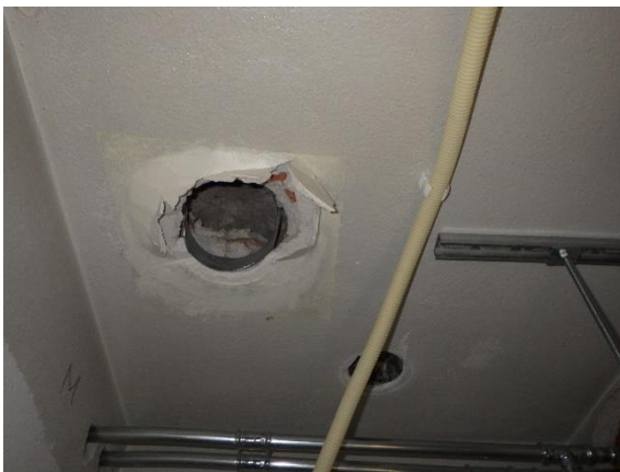
Kuva 98. Avoin läpivienti alakattotilassa
