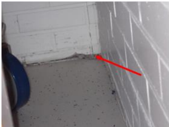
Kuva 71. Halkeama jatkuu lattiaan saakka.
