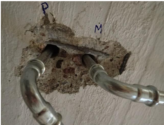
Kuva 66. B-osan välipohjassa on useita läpivientejä, joita ei ole tiivistetty. Maakellarin haju pääsee leviämään ainakin välipohjan eristekerrokseen saakka, osittain ensimmäisen kerroksen sisäilmaan saakka.
