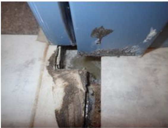
Kuva 35. Kuva välioiven kynnyksen kohdalta, jossa seinän ja lattian liittymästä pistemäisiä vuotoja.
