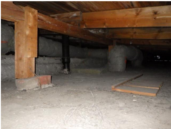
Kuva 84. Viemärin tuuletusputket on eristämättä
