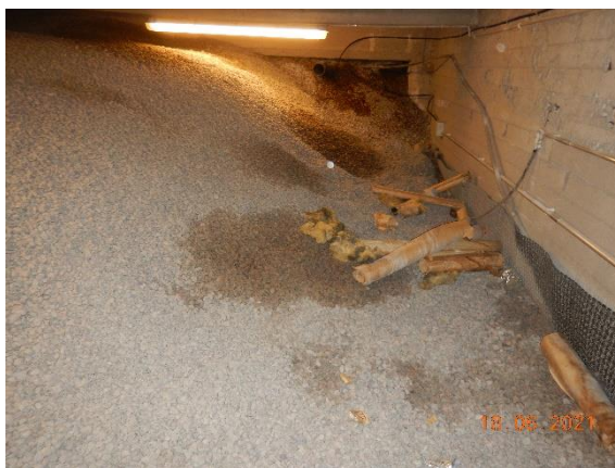
Kuva 27. Vanhoja putkieristeitä ryömintätilassa.
