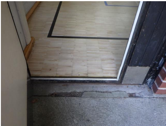
Kuva 61. A-osan liikuntasalin oven kynnys on pellittämättä
