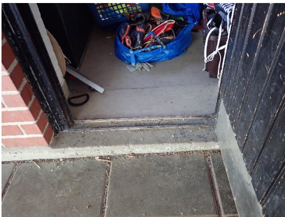
Kuva 21. Ulkoiluvälinevaraston (108) muovimatto on revennyt.
