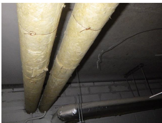
Kuva 95. Alakaton yläpuolella on pinnoittamattomia mineraalivillaeristeitä
