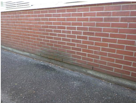
Kuva 7. A-osalla molemmin puolin rakennusta havaittiin muutamassa kohtaa sokkelin / ulkoseinän alaosassa kosteusjälkiä
