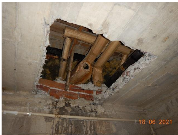
Kuva 29. Avoin aukko ryömintätilan katossa olevaan kanaaliin.
