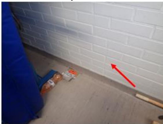
Kuva 72. Välinevaraston 120 väliseinässä on pystyhalkeama
