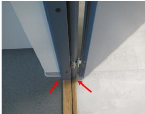
Kuva 33. Pistemäisiä vuotoja oven alanurkasta. Opetustila 138
