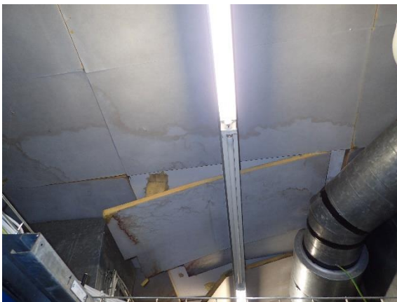
Kuva 101. A-osan IV-konehuoneen katossa on runsaasti kosteusjälkiä ja akustolevyjä on irronnut.
