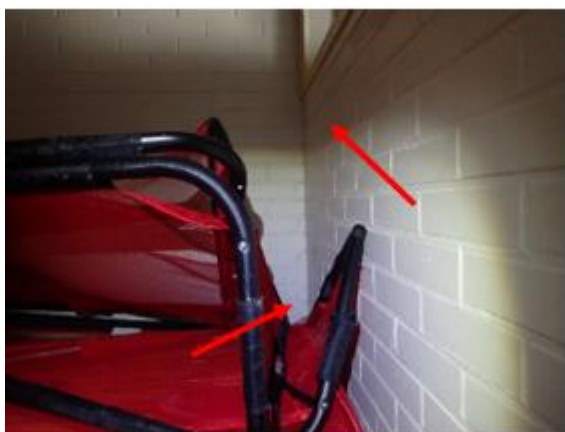
Kuva 70. Tuoli- ja näyttämövaraston väliseinässä on pystyhalkeama.
