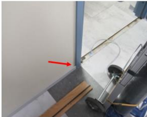
Kuva 32. Pistemäinen vuoto. Opetusvälinevaraston kohdalla.
