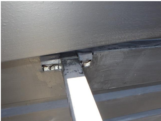
Kuva 111. A-osan katolle johtavien tikkaiden kiinnityskohta ei ollut tiivis
