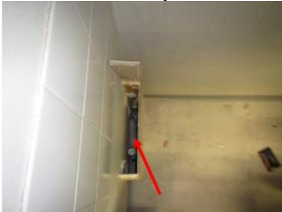
Kuva 34. Vuotoa koteloinnin sisältä läpivienneistä. Opetusvälinevarasto 139
