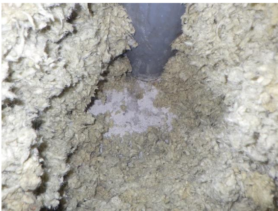
Kuva 92. Muilla osilla muovia ei ollut ja viemärin tuuletusputket ovat eristämättömät
