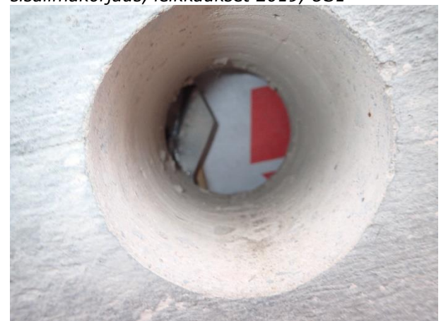
Kuva 4. Näkymä ulkopuolelta, saman ikkunan kohdalla avatun ritilän aukosta, jossa eristekerroksen tuulensuojapaperia näkyvissä.
