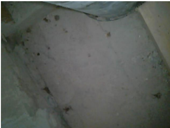
Kuva 22. Tiivistämätön läpivienti ja rakenneliittymä, kotelo käytävällä 135
