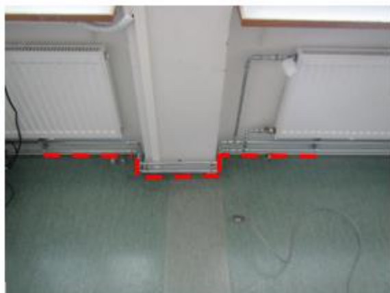
Kuva 69. Useita pistemäisiä vuotoja merkityllä alueella. Opetustila 190
