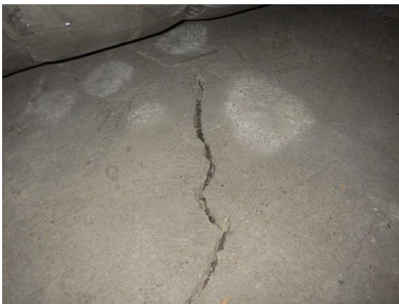
Kuva 86. Palopermannossa havaittiin halkeamia
