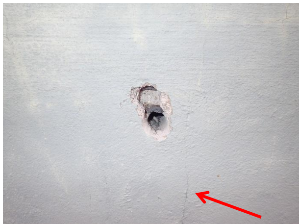
Kuva 3. Rakennekerroksia ja pystyhalkeama avauskohdan vieressä.
