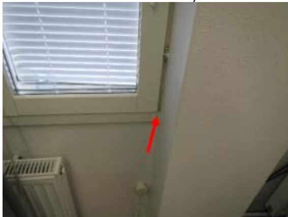
Kuva 52. Pistemäinen vuoto. Työhuone 157
