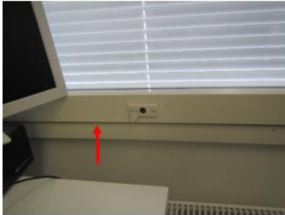
Kuva 51. Pistemäinen vuoto. Työhuone 157
