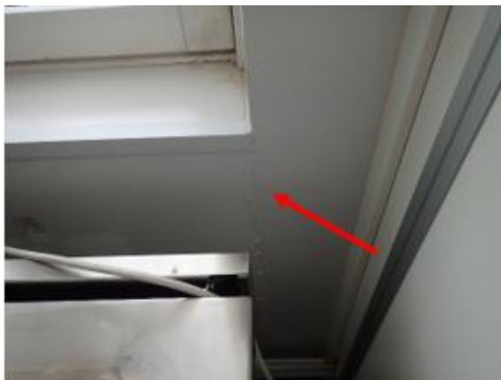
Kuva 49. Halkeama ulkoseinän ja pilarin rakenneliittymässä, kuva ruokasalista.
