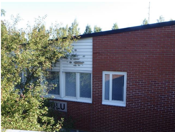
Kuva 43. A-osan peltiverhoilun maalipinta on irronnut pieneltä osin
