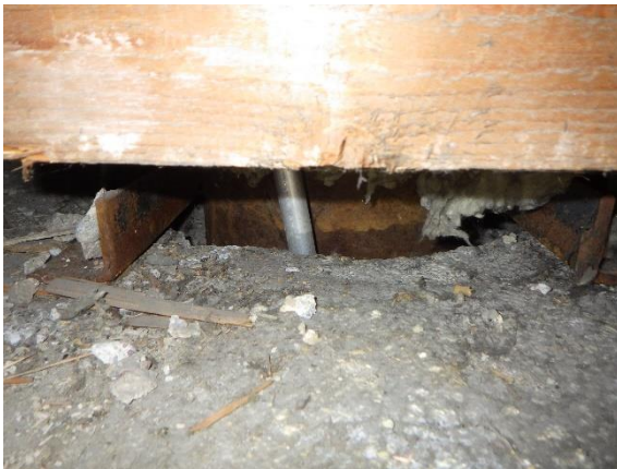
Kuva 85. Yläpohjarakenteen läpiviennit eivät ole tiiviitä
