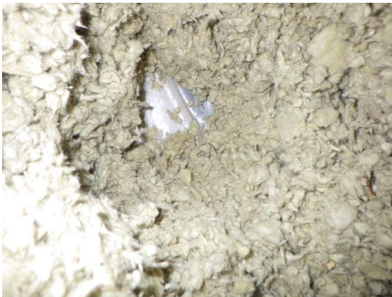
Kuva 91. Liikuntasalin yläpohjatilassa puhallusvillan alla on muovi
