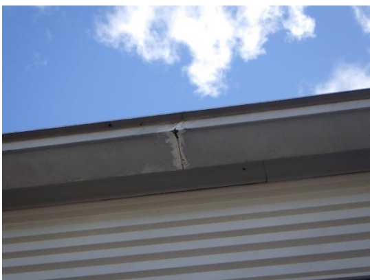
Kuva 8. Kosteusjäljet johtuvat räystäskourun saumasta tippuvasta vedestä
