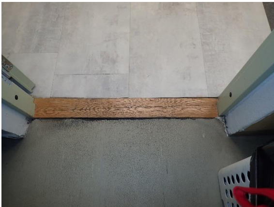
Kuva 68. Siivouskeskuksen 173 lattiamatto on revennyt kynnyksen kohdalta. Myös kynnyslauta on haljennut.
