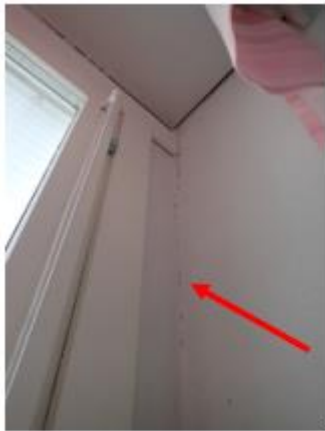
Kuva 47. Halkeama ulkoseinän ja pilarin rakenneliittymässä, kuva opetustilasta 207.
