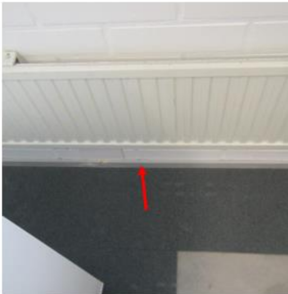
Kuva 31. Pistemäinen vuoto. Opetustila 124
