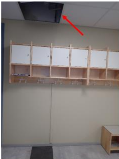
Kuva 74. Liikuntasauma käytävän 135 kohdalla, sauma on avoin alakaton yläpuolella.
