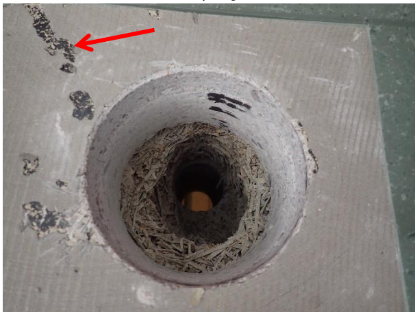
Kuva 3. Välipohjan rakennekerroksia, asbestipitoista mustaa liimaa tasoitekerroksen alla.
