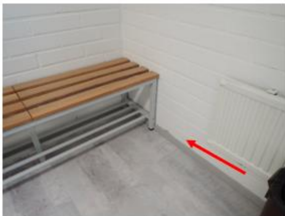
Kuva 45. Maalipinta hilseilee pienellä alueella pukuhuoneen 109 ulkoseinällä. Poikkeamia pintakosteudessa ei kuitenkaan havaittu.
