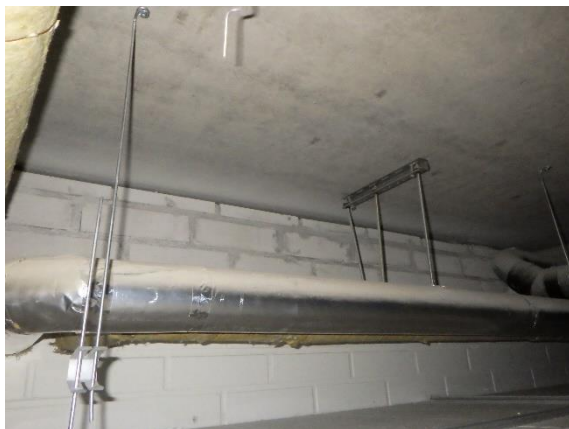
Kuva 96. Putkien yläpinnoilla on paikoin paljon pölyä. Väliseinän yläosan liittymä ei ole tiivis
