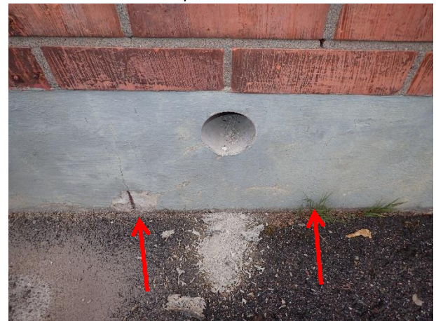
Kuva 4. Raudoitusta on tullut näkyviin ja sokkelissa on pystyhalkeamia.
