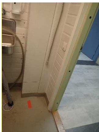
Kuva 23. Siivoushuone 130, pesuaineannostelijan letku on pilarin kohdalla ja pystykotelossa on viemäriputki. Kotelon sisällä puuosissa kosteuden aiheuttamia jälkiä.
