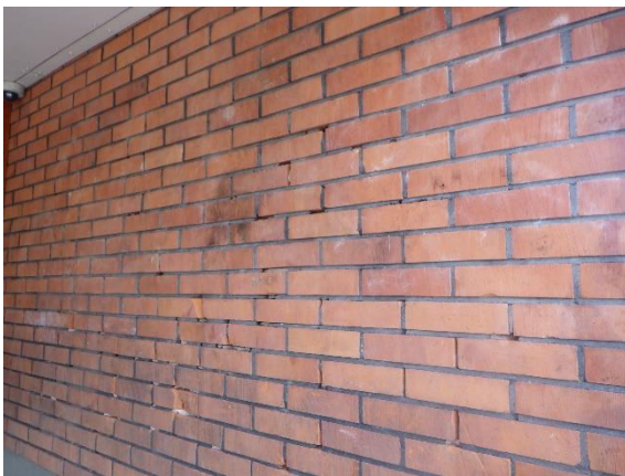
Kuva 41. B-osan muuraussaumoiissa havaittiin rapautumaa
