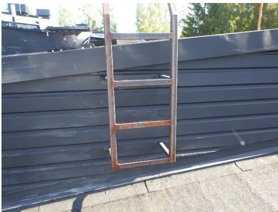
Kuva 110. A-osan katolle johtavien tikkaiden kiinnityskohta ei ollut tiivis
