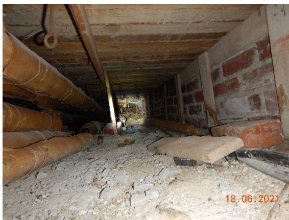
Kuva 30. Kanaalissa on muottilautoja ja putkieristeitä ym. roskaa.
