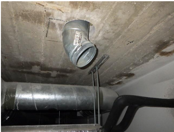
Kuva 100. Avoin putki, josta virtasi ilmaa, tilan 141 edustalla B-osalla
