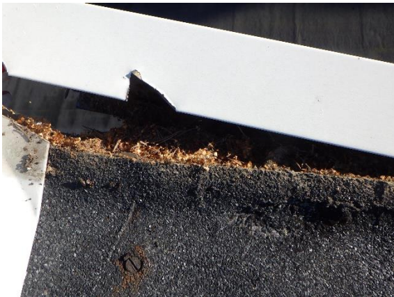
Kuva 105. Ruokalan katon reunapellin kiinnitys oli osin irti
