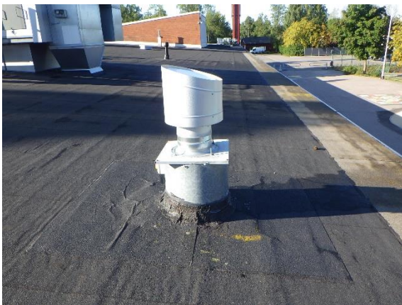
Kuva 106. B-osan katolla olevan huippumurin osalla huopa on nostettu peltiä vasten. Tiivistysmassassa havaittiin halkeamia, vuotoja ei yläpohjatilan puolelta havaittu
