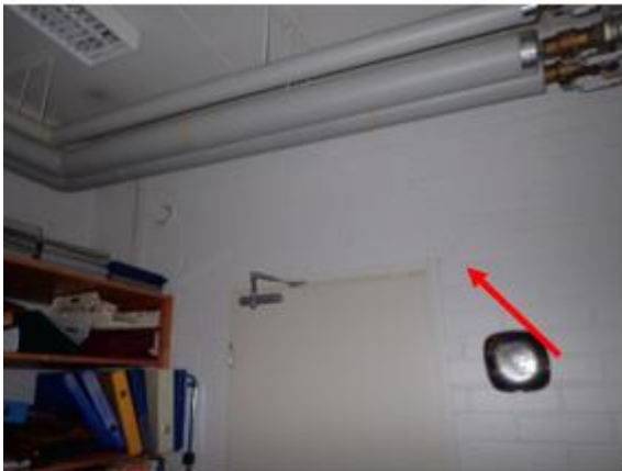
Kuva 73. Halkeama väliooven oikeasta yläkulmasta ylöspäin. Tila 223
