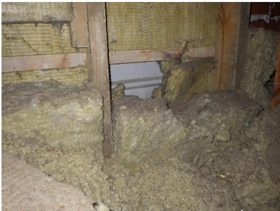
Kuva 90. Lämmöneristepuute yläpohjatilan puolella
