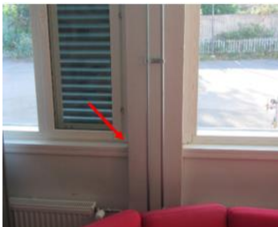
Kuva 57. Pistemäinen vuoto. Opetustila 195
