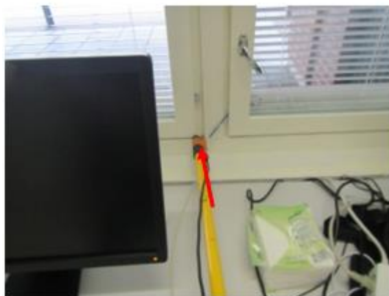
Kuva 50. Pistemäinen vuoto. Työhuone 106
