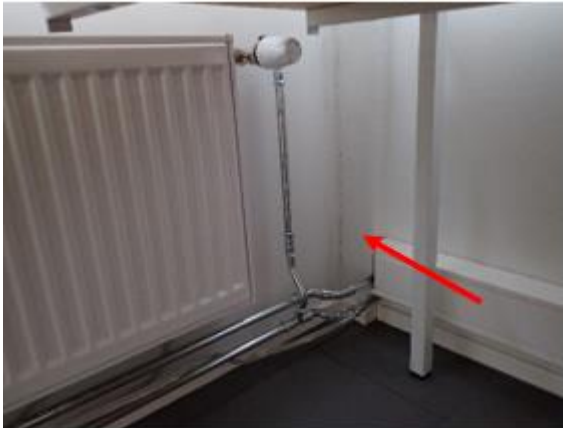
Kuva 48. Halkeamaa ulkoseinän ja pilarin rakenneliittymässä, kuva tilasta 160.
