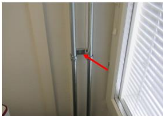
Kuva 53. Pistemäinen vuoto. Opetustila 157
