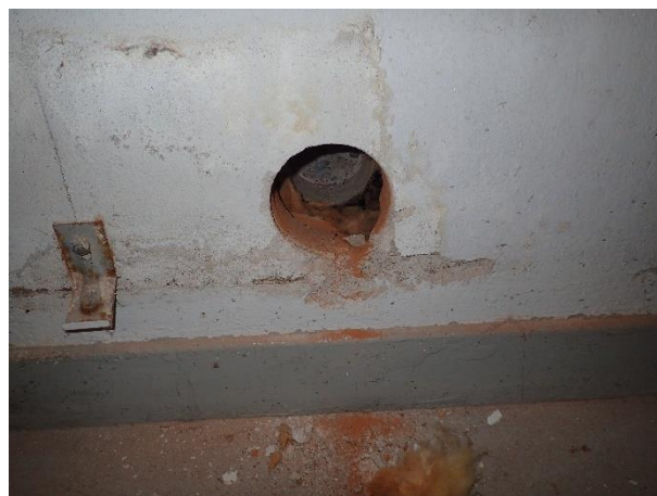
Kuva 2. Maalipinta hilseili rakenneavauskohdassa.
