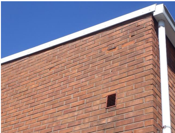
Kuva 40. B-osan tiiliverhoilussa havaittiin rapautumaa
