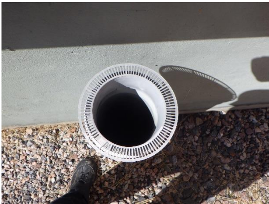
Kuva 10. Tilan 166 kohdalla tuuletusputken yläosa oli avoin
