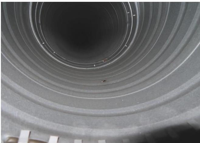
Kuva 15. Näkymä tavanomaiseen tutkittuun tuloilmakanavaan. Kyseessä on käytävällä tilan 1204 kohdalla oleva tuloilmakanava, jonka sisäpinnan pölykertymäarvio oli alle 1 g/m 2 (arviointipiste KP2).
