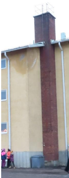
Kuva 10. Vesikatto siivouskomeron (3-kerros) yläpuolella, jonka läpiviennin liittymästä pääsee todennäköisesti vettä yläpohjaan. Vettä on valunut myös julkisivukulmaukseen
