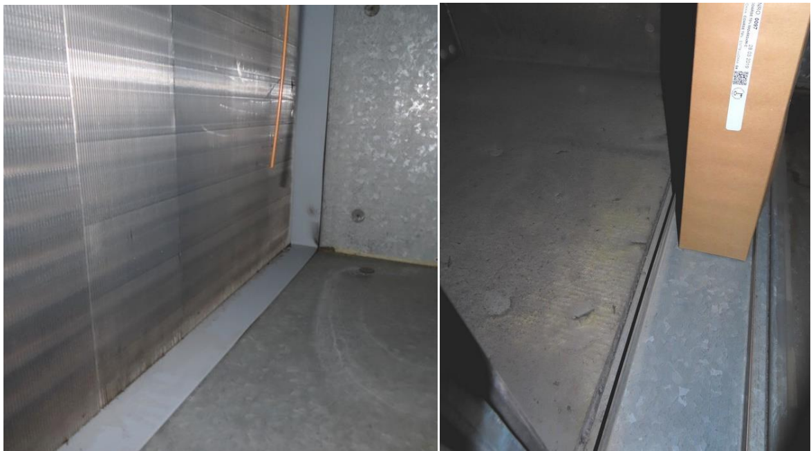
Kuva 25. Vasemmalla on lämmityspatteri, jonka lamellien pölyn määrä oli vähäinen. Konekotelon sisäpintojen pölyn määrä oli vähäinen. Oikealla on G4-tasoinen poistoilmasuodatin, jota ennen konekotelon sisäpinoilla on mineraalivillaa.
