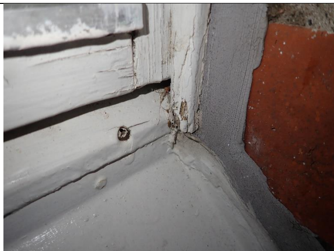
Havainto 21 Pääsääntöisesti ikkunakarmit ovat kohtuullisessa kunnossa. Paikallista maalin rapautumista.
