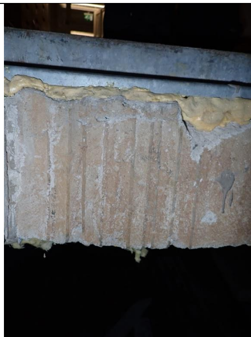
Havainto 8. Lattialuukku, alapohja rakenne. Luukun tiiviste puuttuu.
