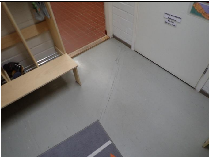
Havainto 1 Kohonneita kosteust lukemia kuvan alueella
