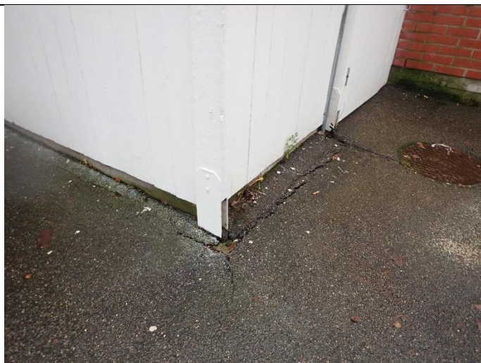
Havainto 23. Seinustalla oleva asfaltti on vaurioitunut. Koska katon sadevesikouru on vaurioitunut valuu vesi asfaltin halkeamaa ja roska-katoksen kylkeen.
