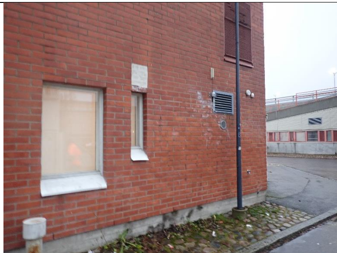
Havainto 17. Tiilissä näkyvillä suolahärmettä. Tuuletusritilän reuna on avoinna. Ikkunan yläpuolinen laastipaikka.
