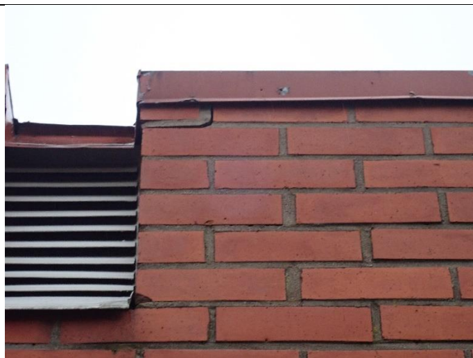
Havainto 19. Tuuletu ritilän kylkipellit eivät ole tiiviisti tiilimuurauksessa kiinni ja ovat tiivistämättä. Saumoissa vaurioita.
