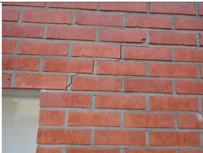
Havainto 20 Länsiseinällä porrasalkeamia.
