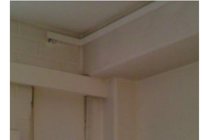
Palkin ja ulkoseinän liittymässä ilmavuutokohta, johtunee puutteellisesta lämmöneristyksestä.
