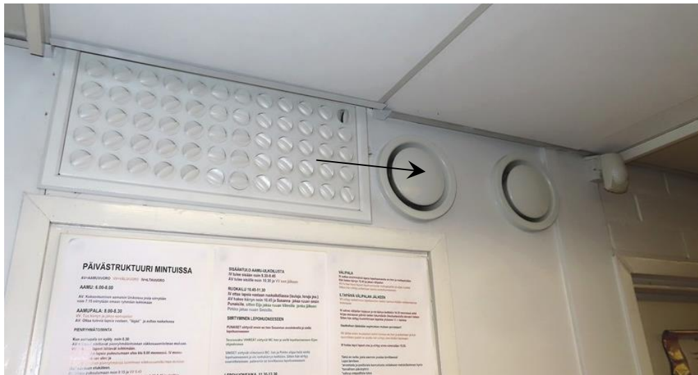
Kuva 36. Ryhmähuone 26. Osa tuloilmasta menee tuloilmalaitteesta suoraan viereisiin poistoilmaventtiileihin.
