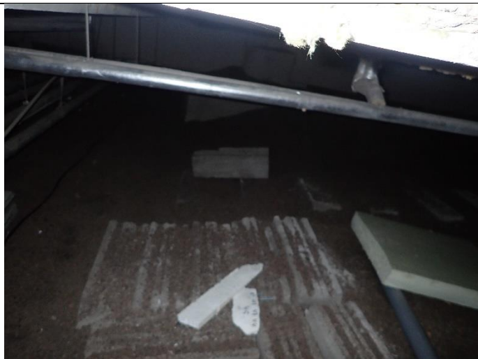
Havainto 9. Lattialuukku, ryömintätilassa irronneita eristeitä/jätettä. .
