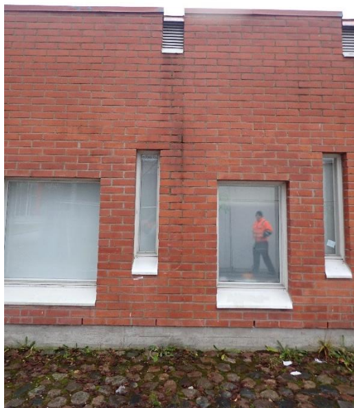
Havainto 16. Tuuletusritilöiden kohdalla sadevesi valuu seinustaa pitkin.
