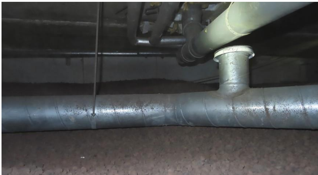
Kuva 31. Alustatila. Kuvassa on tuloilmakanava, jonka tuloilmaventtiileistä tulee tuloilmaa alustatilaan.
