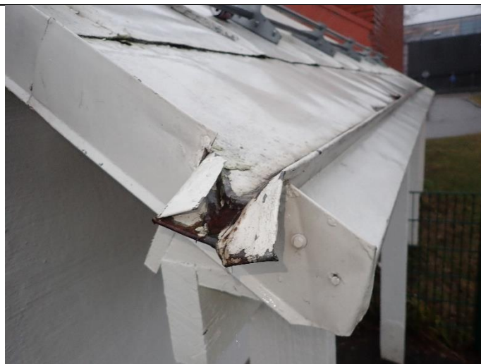
Havainto 15. Katon rännit ovat useassa kohdassa puutteelliset.
