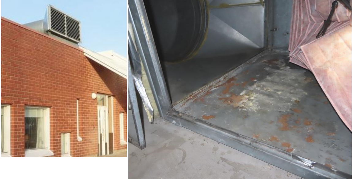
Kuva 24. Vasemmalla näkyy vesikatonle sijoitettu ulkoilmasäleikkö, jossa ei ole erillistä sääsuojaa. Oikealla on tuloilman suodatusosa, tuloilmasuodatin oli F7-tasoinen. Suodatusosan pohjalla on vanhoja kuivuneita kosteusjälkiä ja ruostetta.
