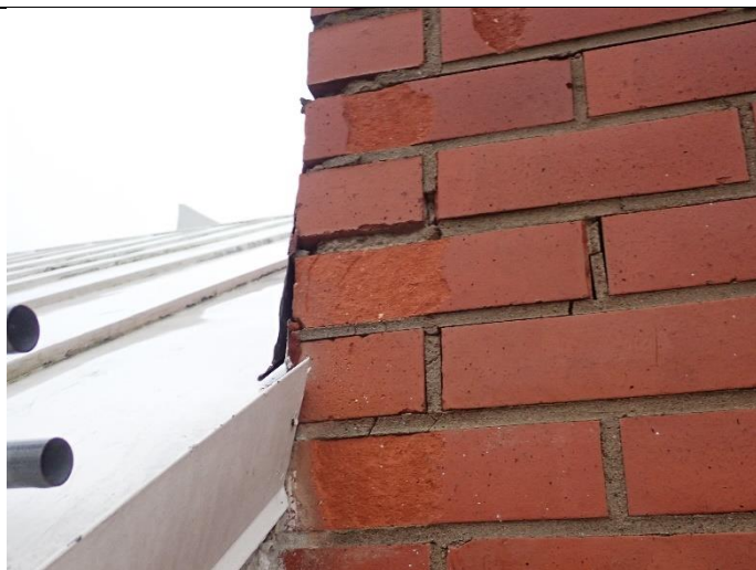
Havainto 14 Kulmassa pellitykset puutteelliset, tiilissä paikoin pakkasrapautumaa ja muuraukset huonossa kunnossa.
