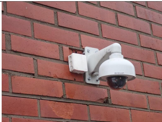
Havainto 13 Valvontakameroiden päällä, rako todennäköisesti tiivistämättä. Tiilissä/saumoissa vaurioita.
