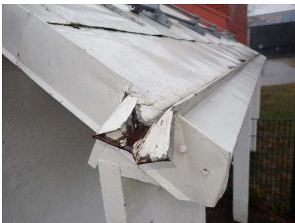
Kuva 22. Vinokatosten vedenohjain on vääntynyt
