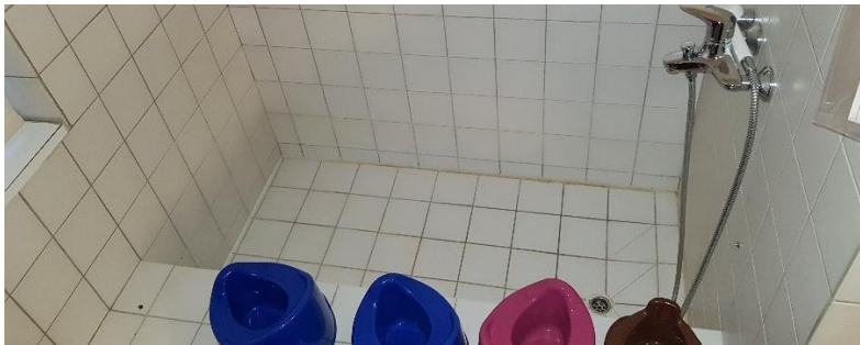
Kuva 11 Märkätilan 25 suihkuallas, josta pääsee vettä tilaan 30
