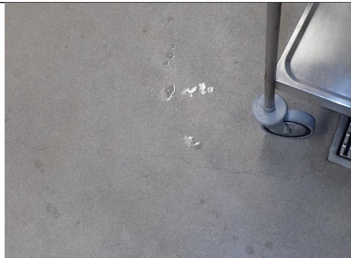
Havainto 2 Lattiassa halkeama, halkeaman ympärillä kohonneita kosteust lukemia.
