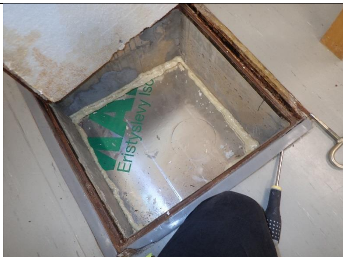
Havainto 7. Lattialuukku ummistettu PIR-levyllä ja uretaanilla.
