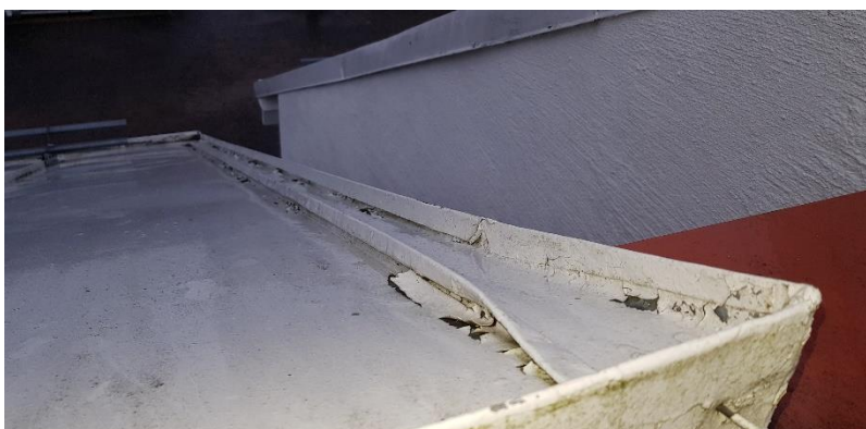
Kuva 18. Peltivesikatteen (YP2) saumojen maalipinta lohkeilee.
