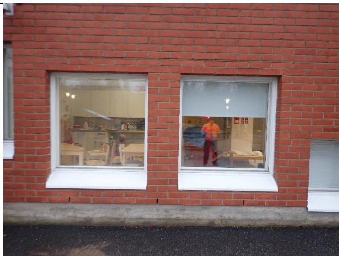
Havainto 11 Ikkunoiden yläpuolella saumoussa rakoja. Saumalaasti sinällään on hyväkuntoinen, epäily ruosteisesta aukonylityksestä raudoituksesta.
