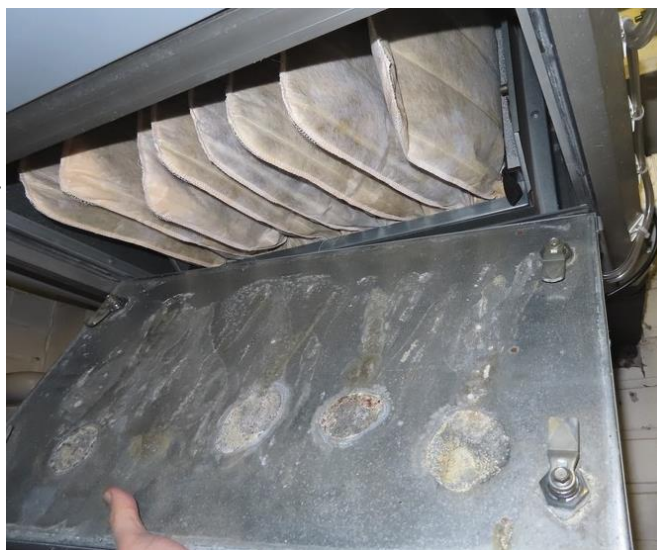
Kuva 29. Tuloilmasuodatin oli M6-tasoinen. Suodatusosan pohjalla oli vanhoja kuivuneita kosteusjälkiä.
