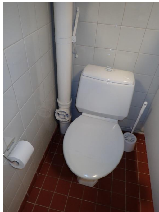
Havainto 4 Viemäriputken ympärillä, paikallisesti kohonneita kosteust lukemia.
