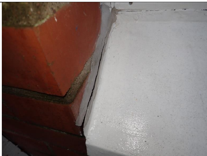
Havainto 10 Ikkunapelliysten reunat paikoin irti seinästä ja kittaukset, liituuntuneet ja hapertuneet.
