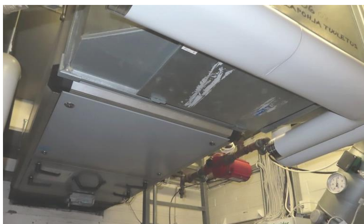
Kuva 27. Ilmanvaihtokone TK02 (tuloilmakone).
