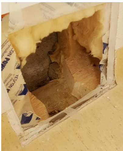
Kuva 14. Avaus 4, terveydenhoitajan tilassa 15. Ulkoseinän kosteusteknisessä kunnossa ei todettu poikkeavaa. Höyrynsulkua ei ole asennettu ilmatiiviisti.
