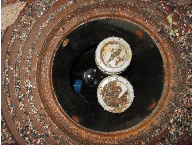
Padotusventtiilit salaojakaivossa SOK 9.
