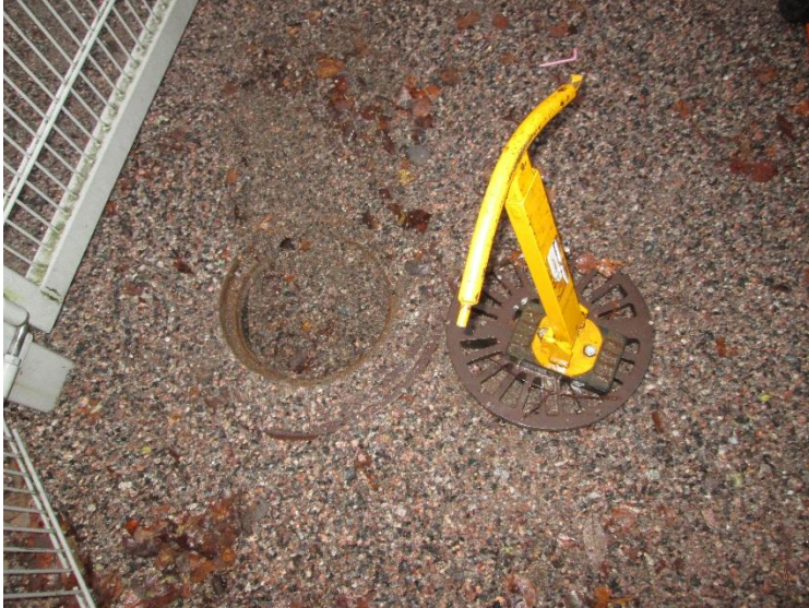
Salaojakaivo SOK 6 täynnä hiekkaa.
