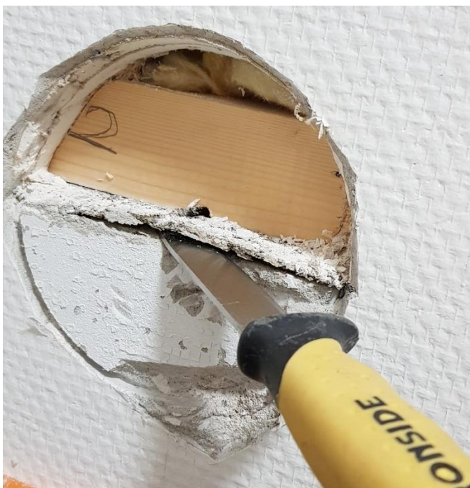
Kuva 23. Vesileikkihuoneen 10 väliseinän alaosassa on harkkomuurattu (avaus 3).
