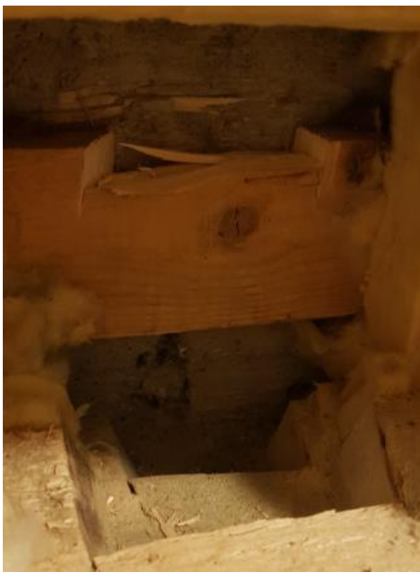
Kuva 15. Avaus 6, tilassa 41. Ulkoseinän kosteusteknisessä kunnossa ei todettu poikkeavaa. Höyrynsulkua ei ole asennettu ilmatiiviisti nykyisen ohjeistuksen mukaisesti. Sokkelia vasten on jätetty käsittelemätön muottipuulauta.
