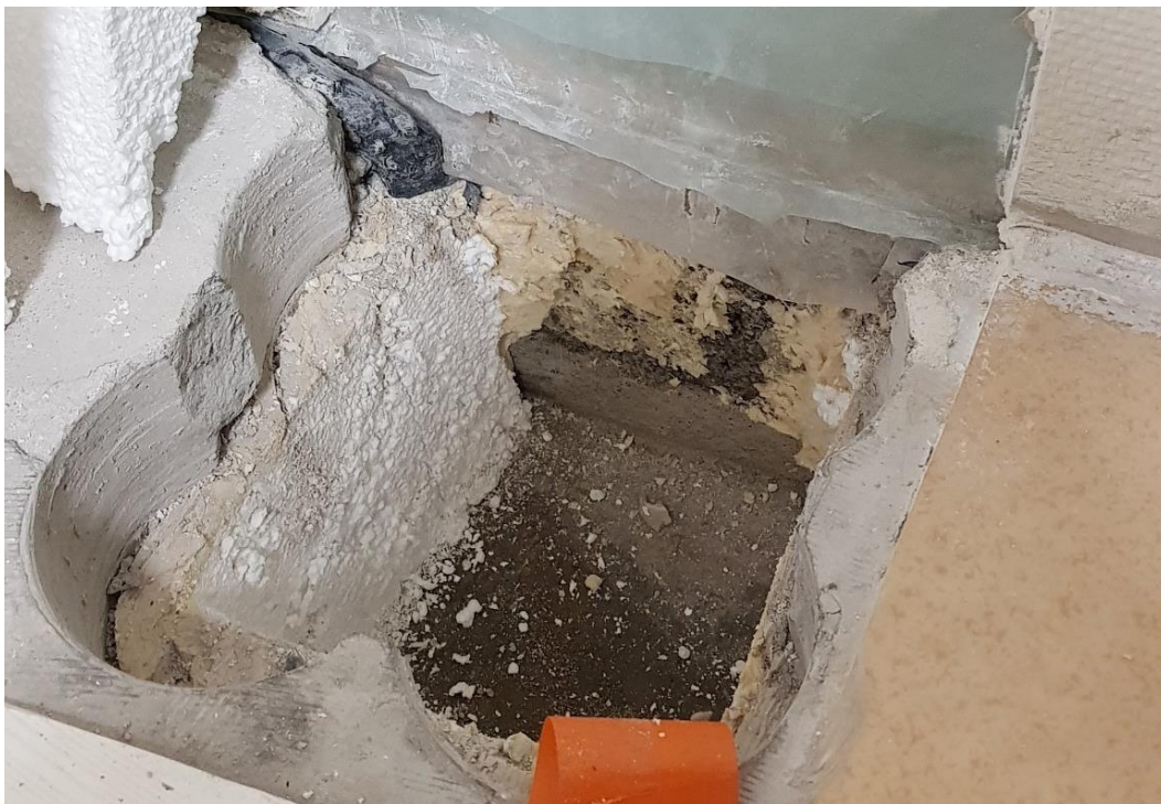
Kuva 6. Avaus 2, kantavan alapohjan AP2 avaus tilassa 11. Rakennetta avatessa ontelo-laatan pinnalle oli päässyt porauksesta aiheutunutta jäähdytysvettä. Rakenteen kosteusteknisessä kunnossa ei ole huomautettavaa.
