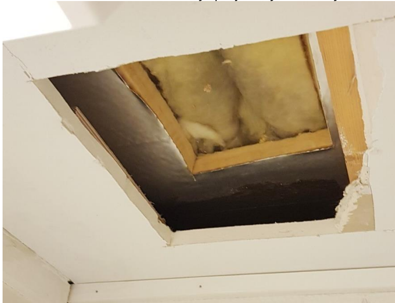
Kuva 28. Avaus 13, yläpohjan alumiinipintainen Termopol-levytys, jonka tarkoitus olisi olla rakenteen ilmatiivis kerros. Merkkiainetutkimusten perusteella rakenne ei ole ilmatiivis. Yläpohjan lämmöneristeissä oli havaittavissa nokisia ilmavuotojälkiä.
