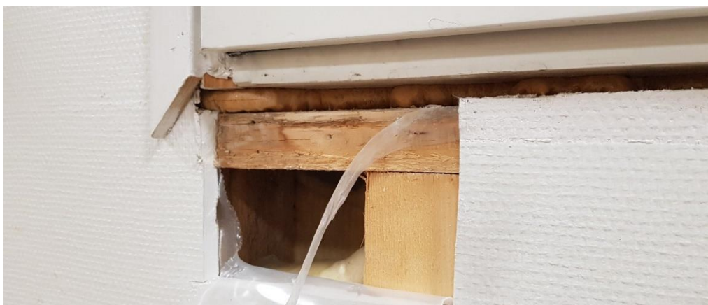
Kuva 18. Tilan 11 ulkoseinään ikkunan alle tehtiin rakenneavaus 9. Runkopuussa oli nähtävillä kosteusjälkiä. Runkopuussa ja sitä vasten olevassa mineraalivillassa todettiin poikkeavaa mikrobikasvustoa. Höyrynsulkumuovia ei ole myöskään asennettu ilmatiiviisti.
