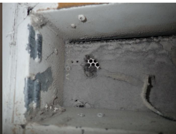
Kuva 29. Reikäpelti tukkeutunut pölystä
