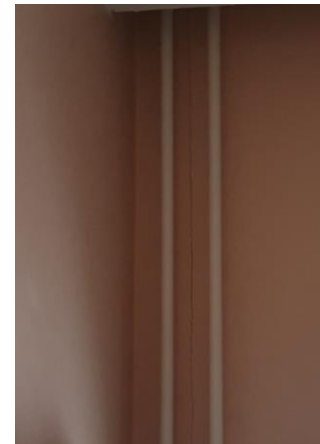
Kuva 9. Halkeama lattiasta kattoon.
