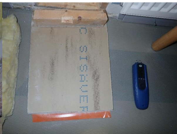
Kuva 14. Valumajälkiä tuulensuojalevyn sisäpinnalla
