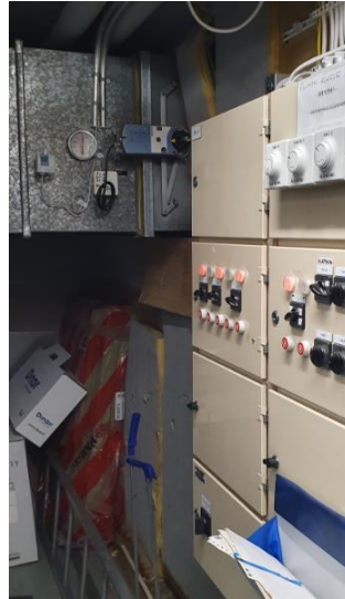
Kuva 7. Eristelevyt irti seinästä.
