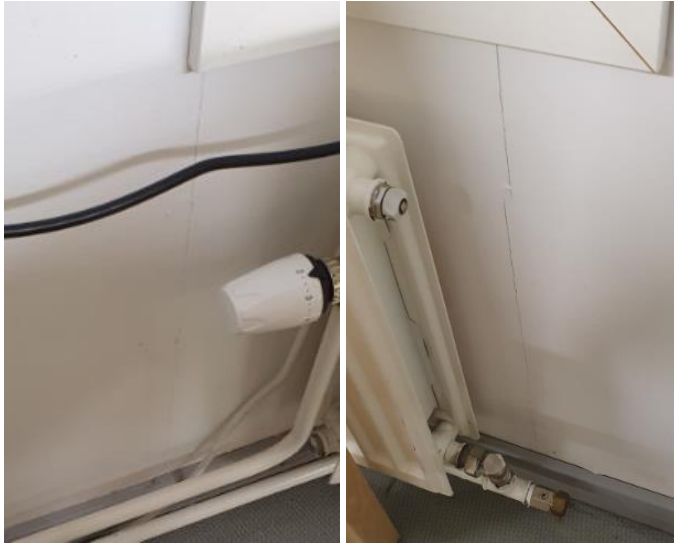
Kuva 6. Halkeamia ikkunan alapuolella kummallakin sivulla.
