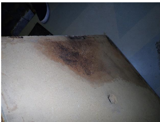
Kuva 4. Alustatilan luukussa mikrobivaurioita.
