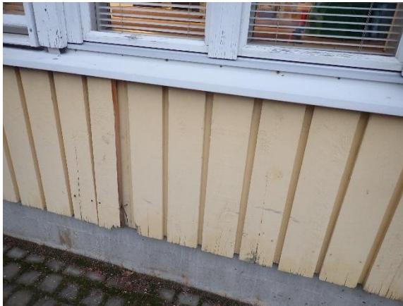
Kuva 19. Ulkoverhouksessa maalin hilseilyä ja laudoituksen halkeilua
