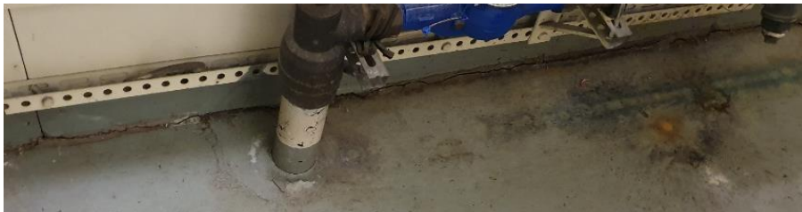
Kuva 8. Halkeama lattian ja seinän liittymäkohdassa koko seinälinjan pituudelta.
