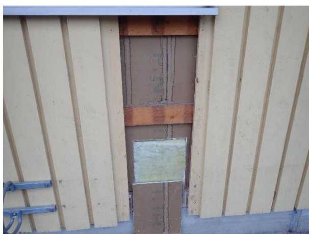
Kuva 15. Valumajälkiä tuulensuojalevyn ulkopinnalla
