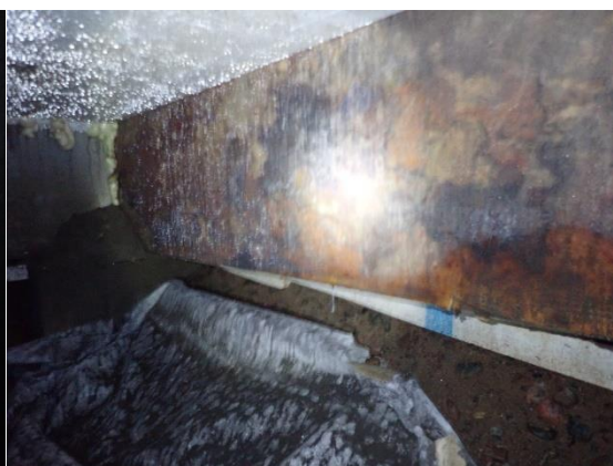
Kuva 7. Kondenssia ja mikrobivaurioitunut muottivaneri
