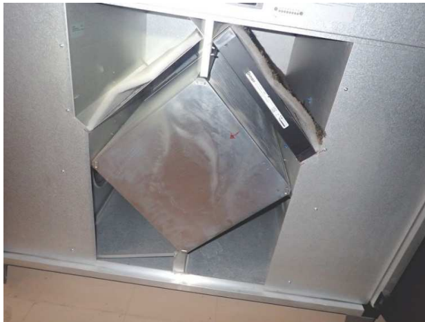
Kuva 79. Koneessa on levylämmöntalteenottolaite. Tuloilmapuolella oli esisuodattimena karkea suodatinmatto ja suodattimena F7-tasoinen kasettsuodatin. Poistoilmapuolella oli karkea suodatinmatto.
