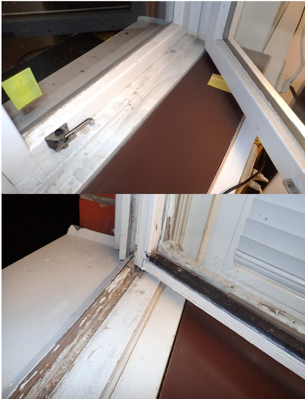
Kuvat 27 ja 28. Rakennuksen ikkunat ovat pääasiassa MSE-ikkunoita eli sisään aukeavia kaksipuitteisia, kolmelasisia (sisäpuiteessa eristyslasi) puuikkunoita. Ikkunakarmeissa ja -pokissa oli useissa tiloissa havaittavissa vanhoja vesivuotojälkiä sekä maalin irtoamista. Vauriot olivat suurimmat kaakkoisjulkisivuilla.
