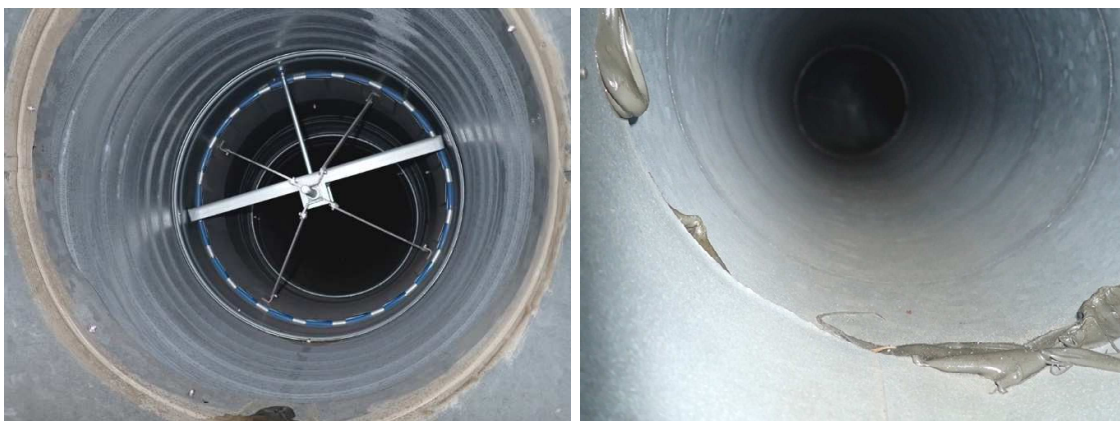
Kuvat 80 ja 81. Koneen 1TK tuloilmakanavia: Vasemmalla arviointipiste KP1, tuloilmakanava IV-konehuoneessa koneen 1TK jälkeen, sisäpinnan pölykertymäarvio alle 1 g/m 2 . Oikealla arviointipiste KP2, tuloilmakanava tilassa 117, sisäpinnan pölykertymäarvio 1-2 g/m 2 .
