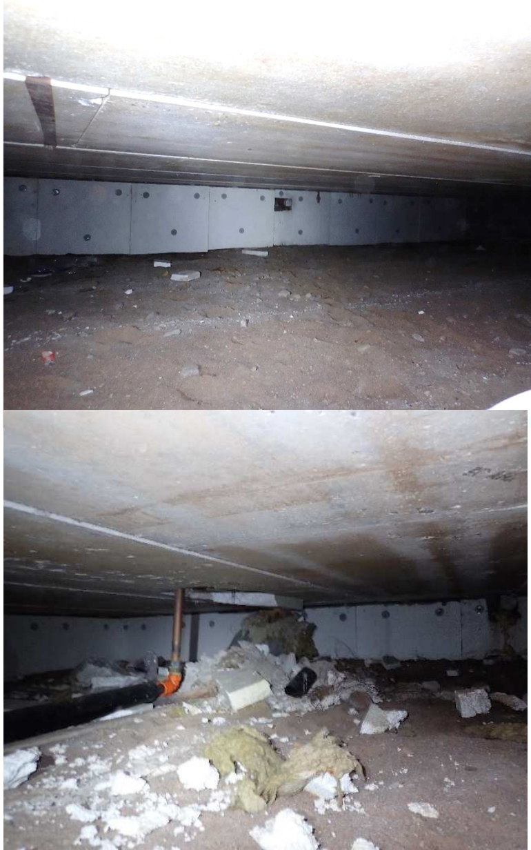
Kuvat 8 ja 9. Ryömintätila oli pääasiassa siisti (vas.). Puu- ja lämmöneristekappaleita oli siellä täällä. Tilan 145 alla oli paikallisesti paljon rakennusjätettä (oik.).
