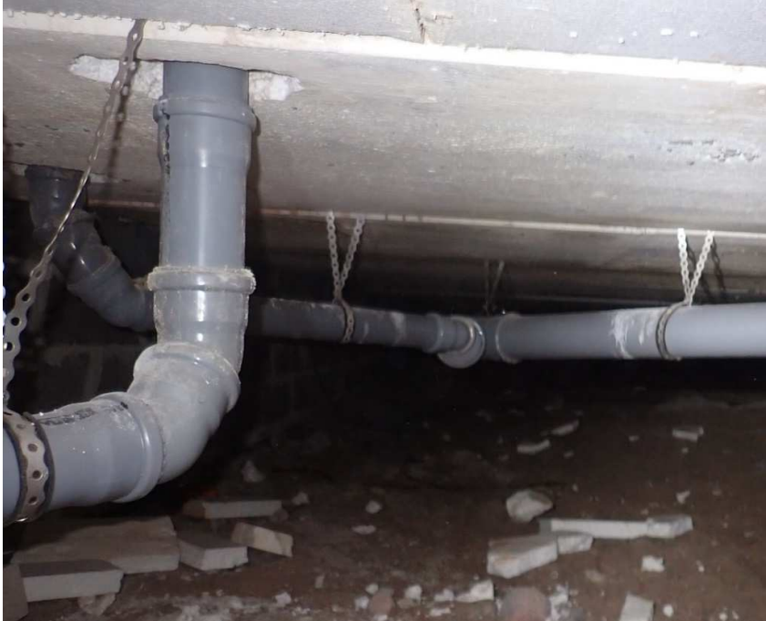
Kuva 10. Alkuperäinen talotekniikka on kannakoitu ontelolaatastoon peltinauhoilla. Viemäriputkien pinnoilla havaittiin paljon vanhoja vesivuotojälkiä
