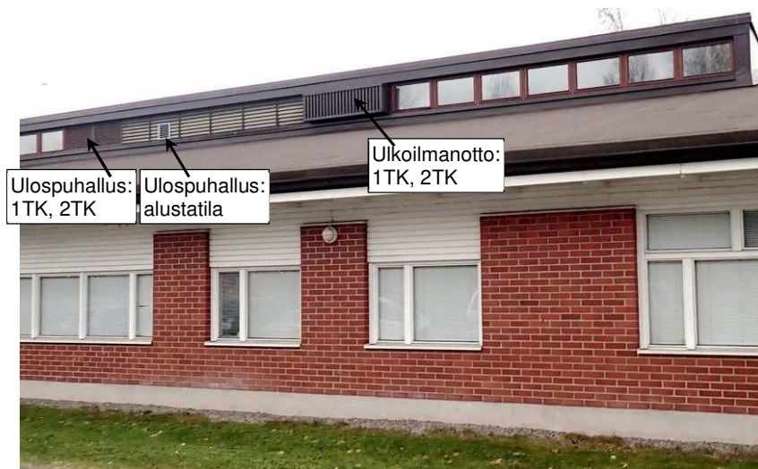
Kuva 95. Koneiden 1TK ja 2TK ulkoilmanoton ja ulospuhalluksen sekä alustatilan ulospuhalluksen sijainti vesikatolla.
