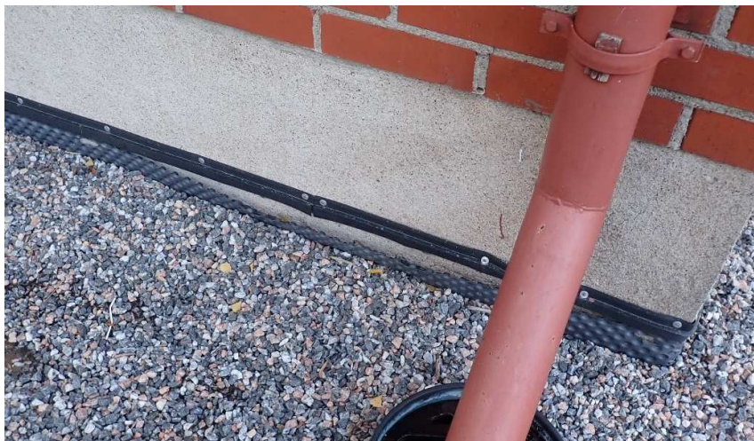
Kuvat 23 ja 24. Sokkelin patolevy on paikoin kiinnitetty sokkelin rappauksen ulkopintaan ja paikoin rappauksen alle. Patolevy on paikoin rikkoutunut ja sen taakse voi kulkeutua vettä.
