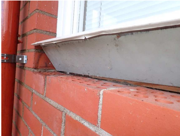
Kuva 29. Kohdekierroksella havaittiin muutamia heiluvia ja lähes irtoavia vesipellityksiä. Paikoin vesipellin kaato poispäin rakennuksesta arvioitiin vähäiseksi.
