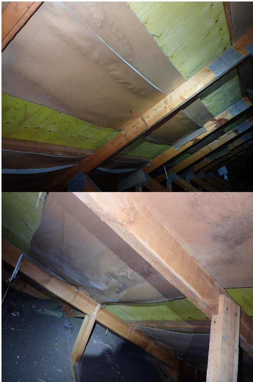
Kuvat 51 ja 52. Vesikaton vanhaa kartonkialuskatetta on poistettu osittain. Nykyään aluskatteena toimii vanerilevy (Wisa-kate). Kartongissa oli havaittavissa tummentumia ja rypistymiä, jotka johtuivat aiemmasta kastumisesta.
