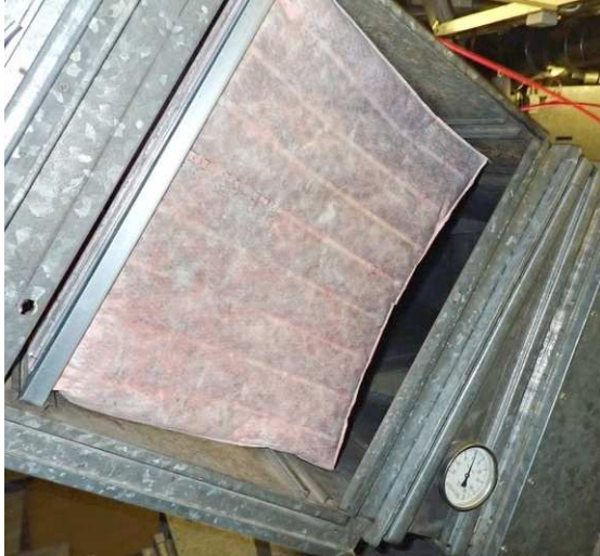
Kuva 72. Tuloilmasuodattimena oli F7-tasoinen pussisuodatin.
