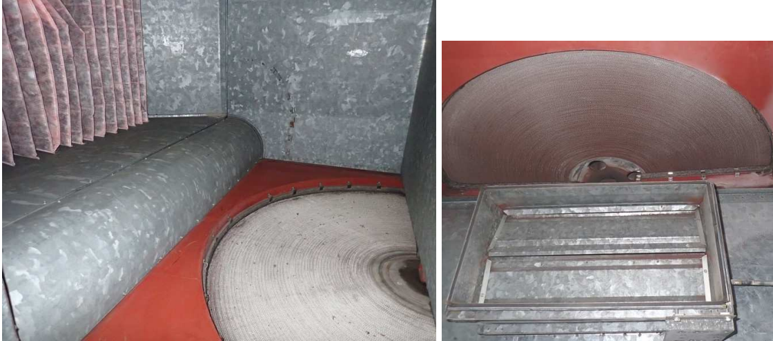
Kuvat 67 ja 68. Tuloilmasuodattimena oli F7-tasoinen pussisuodatin. Koneessa on pyörivä lämmöntalteenottolaite, joka ei pyörinyt (ei toiminut), vaikka ulkolämpötila oli 0 °C. Puhaltimien pyöriessä todettiin koneen sisällä tuloilmapuolella lämmöntalteenottolaitteen jälkeen poikkeavaa hajua (imelä/maakea tms.). Koneen ulkoilmakanavassa tai poistoilmapuolella ei ollut vastaavaa hajua. Oikealla näkyy tuloilmapuolella kiinni oleva tulo- ja poistoilman sekoituspelti.
