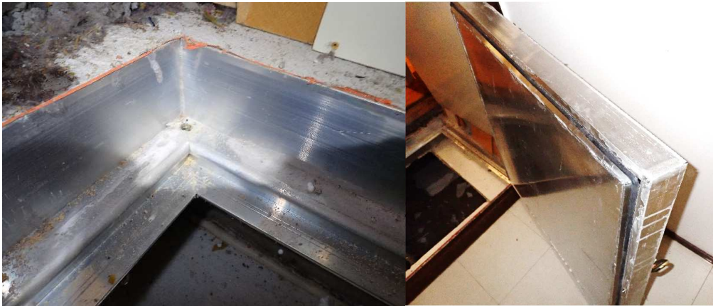
Kuvat 6 ja 7. Liikuntasalin alapohjassa on kaasutiivis, metallirakenteiden luukku ryömintätilaan. Luukussa on kumitiivisteet.
