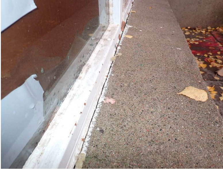
Kuva 21. Liikuntasalin koillisjulkisivun ikkunarakenteessa ei vesipeltiä. Ikkuna- ja sokkelirakenteen liittymän tiivistyksessä on halkeama, josta vuotaneet vettä ulkoseinärakenteeseen. Vastakkaisella ulkoseinällä ikkunarakenteessa on vesipelti.
