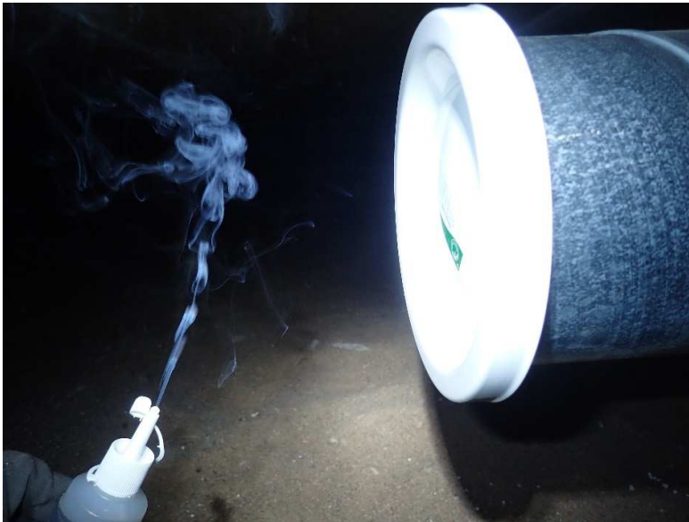
Kuva 11. Uusittu poistoilmanvaihto ei ollut tarkastetuilla kohdin toiminnassa tutkimuskäynnillä 27.10.2020 noin klo 19:30. Alkuperäisissä raitisilmaputkissa havaittiin tavanomaista ilman liikettä.
