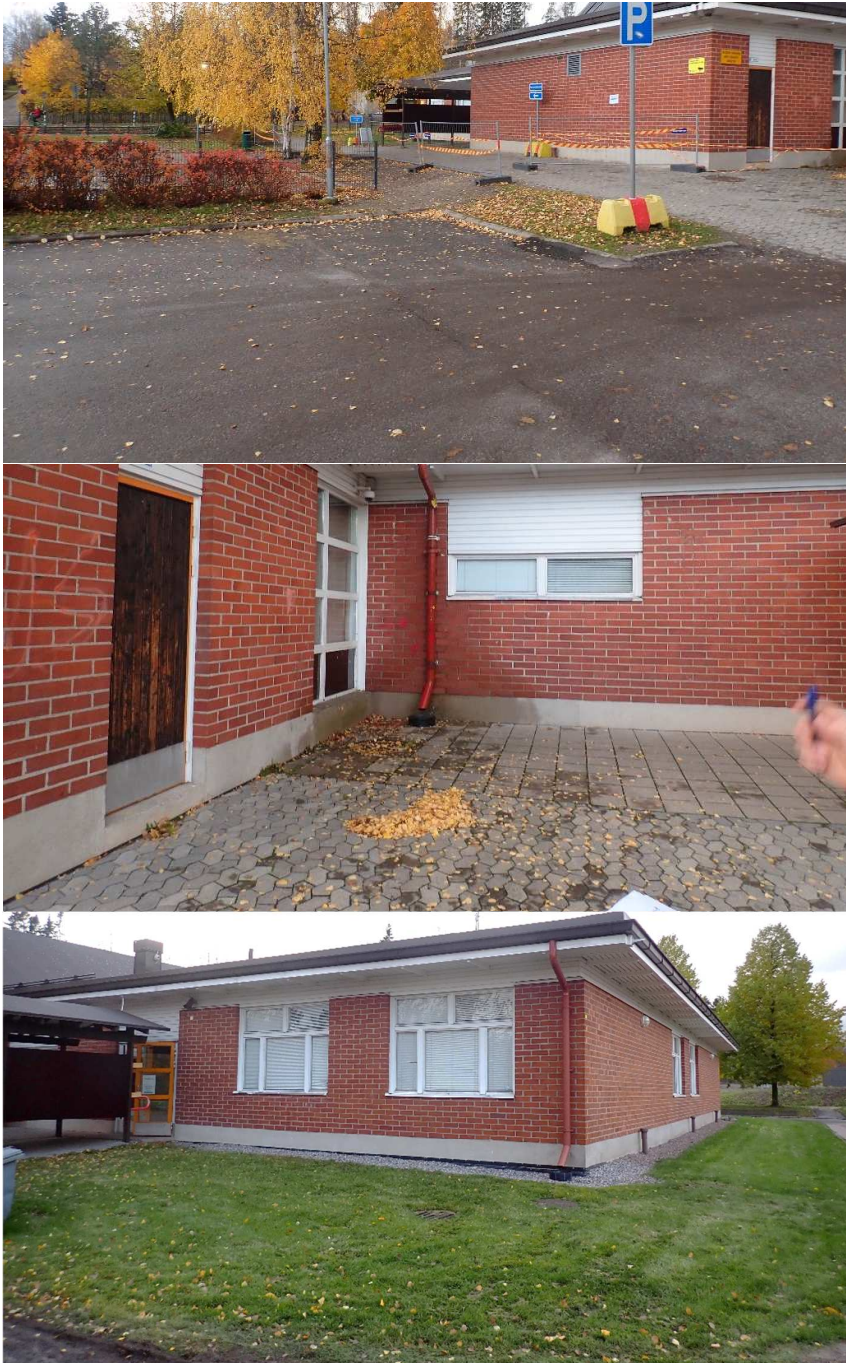
Kuvat 62, 63 ja 64. Julkisivu kaakkoon. Maan pinta viettää poispäin rakennuksesta. Lähellä liikuntasalin sisänurkkaa kiveyksen kaadon suunta vaihtelee. Nurkan vieressä on sadevesikaivo.
