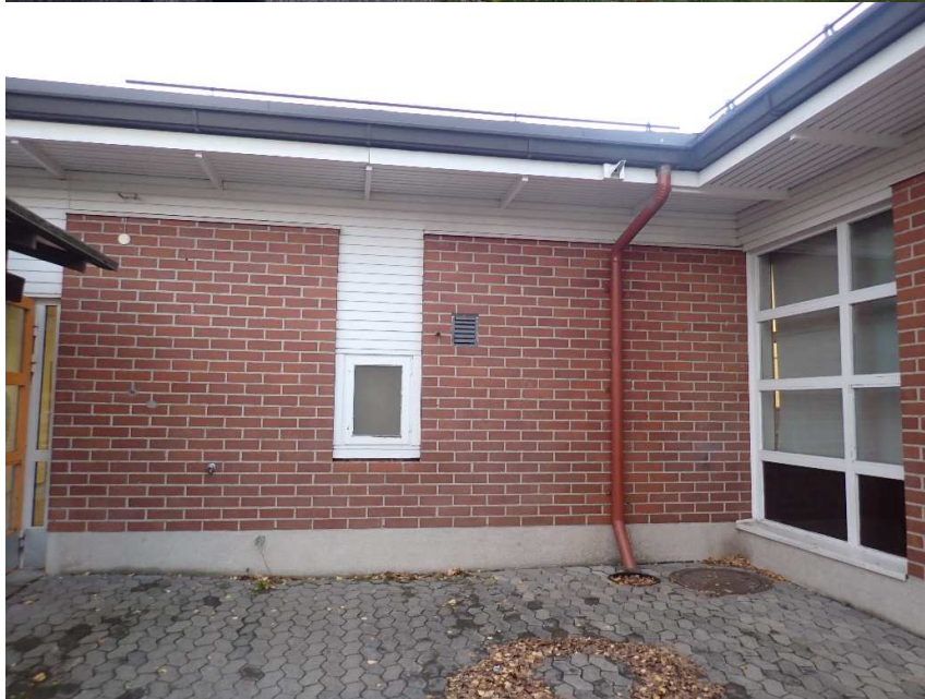
Kuvat 60 ja 61. Julkisivu kaakkoon. Maan pinta viettää pois päin rakennuksesta. Lähellä liikuntasa- lin sisänurkkaa kiveyksen kaadon suunta vaihtelee. Nurkan vieressä on sadevesikaivo.
