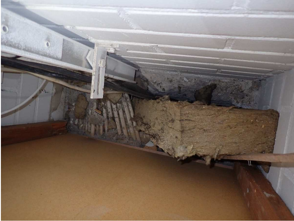
Kuva 5. Tilan 126 lattian läpivienti tekniikkakoteloissa (porrashuoneen vieressä). Kotelon sisällä havaittiin ilman liikettä ryömintätilasta sisätiloihin ja tunkkaista hajua.
