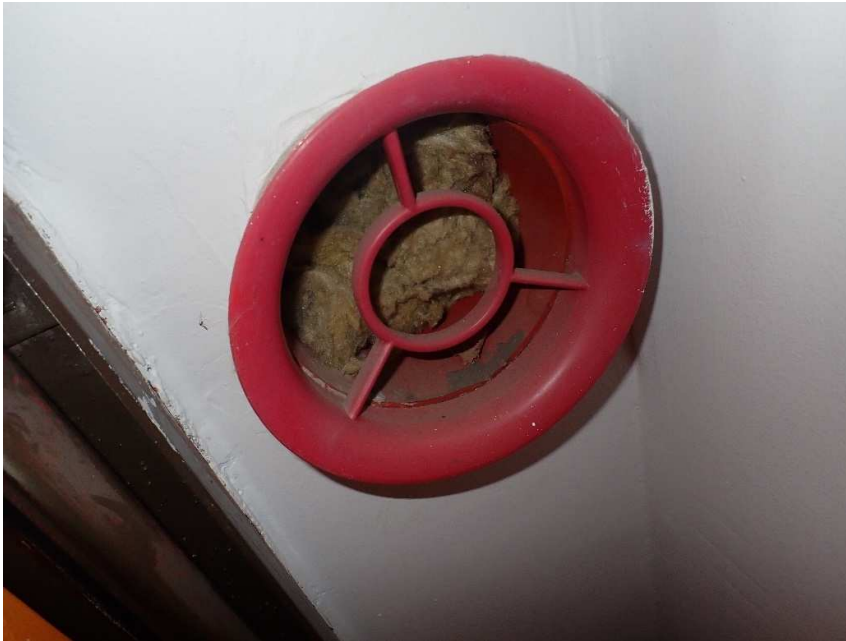
Kuva 44. Väestönsuojan ja käytävän 136 väliseinässä on ilmakeinava, joka on tulpattu pinnoittamattomalla mineraalivillalla.
