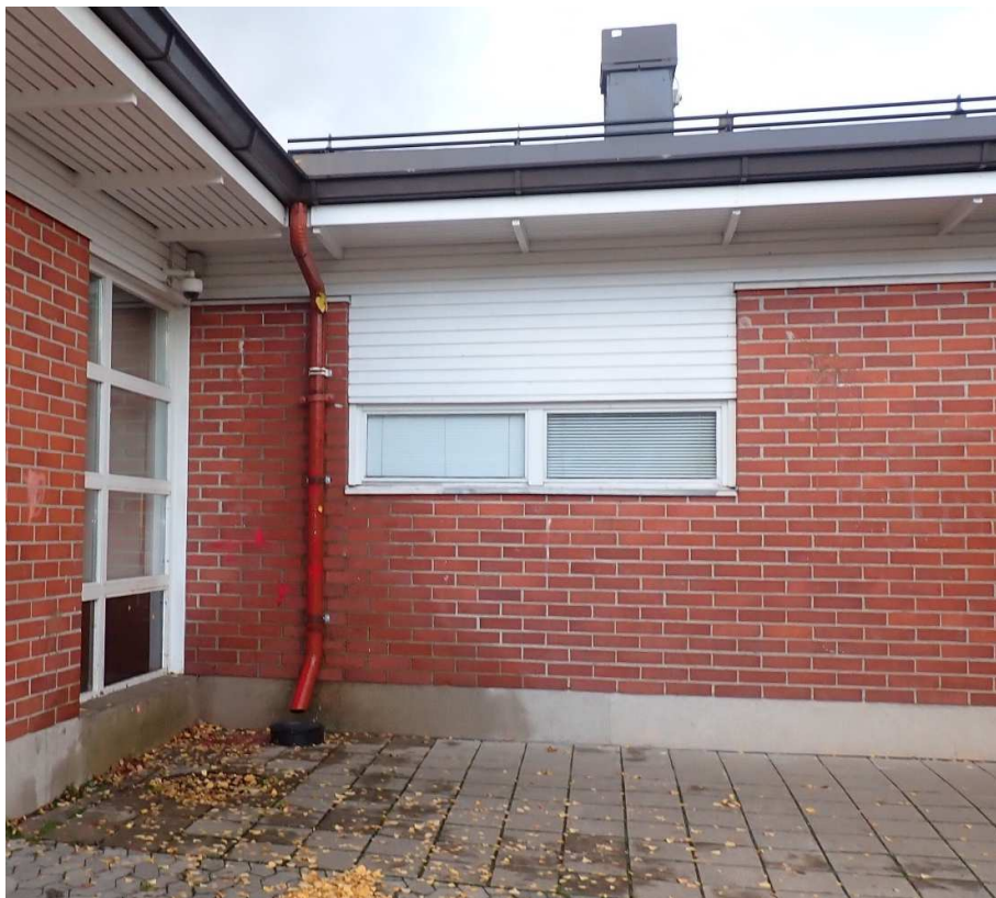
Kuva 20. Syökytorven kastelema ulkoseinä liikuntasalin vieressä.
