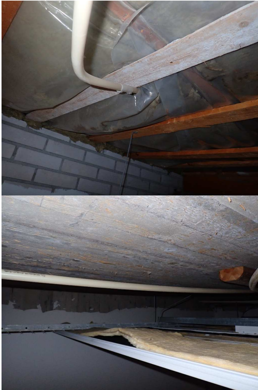
Kuvat 49 ja 50. Eteistilassa 159 yläpohjan epätiiviyksiä ja vanhoja vesivuotojälkiä. Alemmassa kuvassa on eteistilan 136 betoniseen yläpohjaan kiinnittynyttä puuainesta sekä alakattosäleikön päällä pinnoittamatonta mineraalivillaa.
