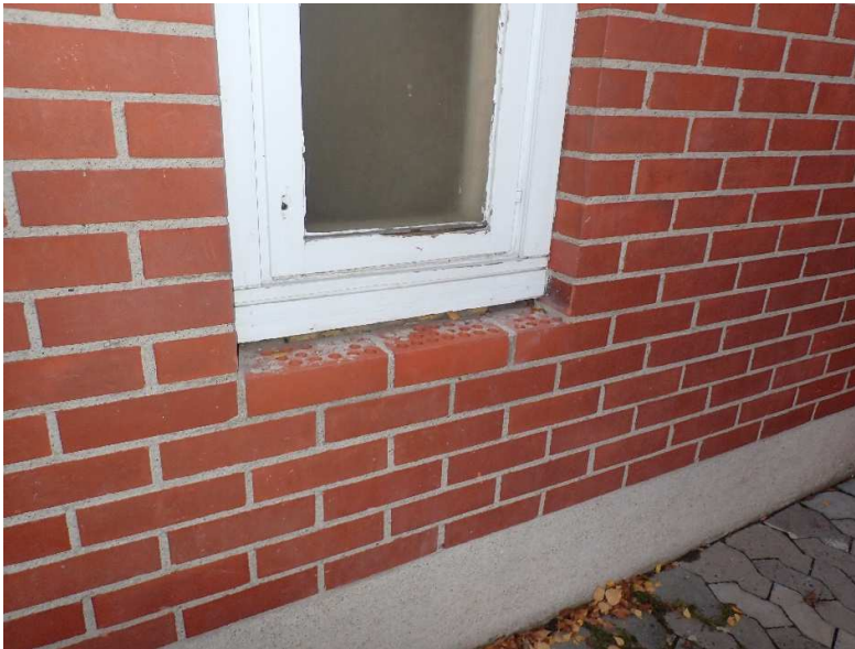
Kuva 22. Väestönsuojan ulkoseinässä on sisältä päin ummistettu vanha ikkuna, josta puuttuu vesipelti.
