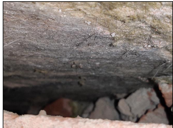
Kuva 73. Ilmarako on ainakin osittain täytynyt laastipurseista. Ilmarakoon on myös ajautunut avauksen seurauksena tiilen kappaleita.
