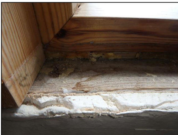
Kuva 86. Alakarmissa on viitteitä vanhoista vesivuodoista.
