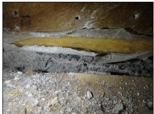
Kuva 46. Alaohjauspuun ja sokkelin väliin on asennettu muovilla päällystettyä villaa tilkkeeksi.
