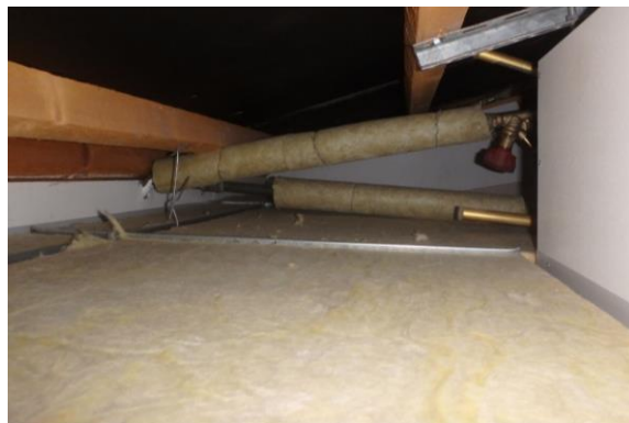
Kuva 114. Vanhat alaslasketut katot ovat pinnoittamattomia mineraalivillaisia levyjä. Lisäksi alaslaskutilassa oli havaittavissa mineraalivillalla eristettyjä putkia.
