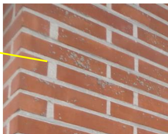
Kuva 25. Tiilen pinnassa oli hieman jäkälä kasvua.
