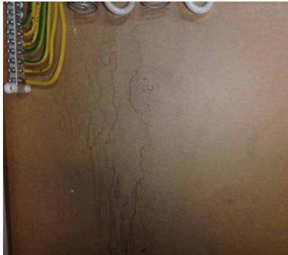
Kuva 32. Ilmanvaihtokonehuoneen seinässä kosteusjälkiä, jotka ovat todennäköisesti vanhoja. Tutkimushetkellä ei havaittu kohonneita kosteuspitoisuuksia.
