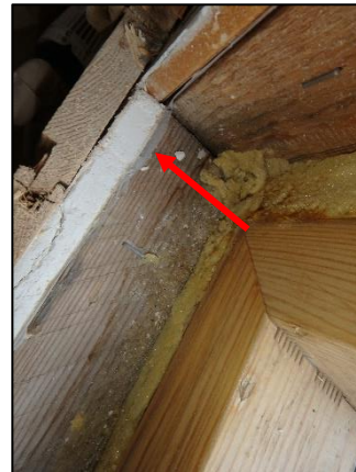
Kuva 83. Alakarmin sekä pystykarmin kohdalla seinärakenteessa oleva muovikalvo on näkyvissä.
