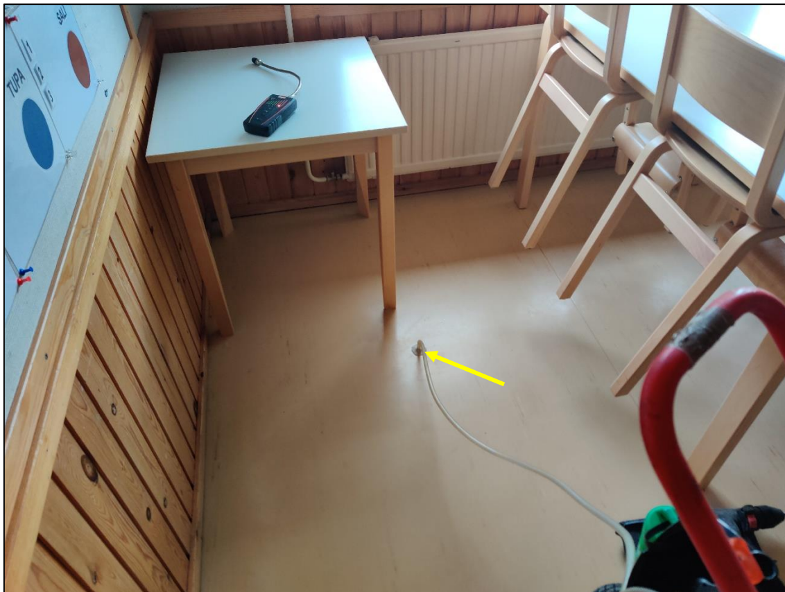
Kuva 19. Merkkiainekoe tilassa 43. Vuotokohtia ei havaittu. Kaasun syöttöreikä on merkattu keltaisella nuolella.
