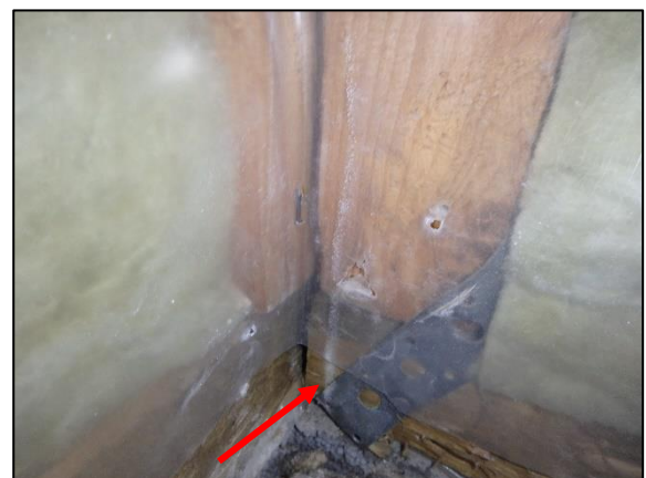
Kuva 52. Muovikalvo on tuotu nurkan yli yhtenäisenä. Kalvoa ei ole kiinnitetty tiiviisti seinän alaosaan.
