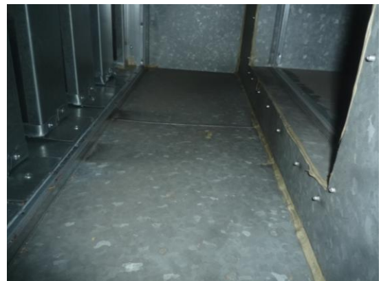
Kuva 104. Tuloilmakanavassa tavanomaista pölyntymistä.
