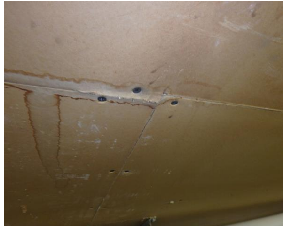
Kuva 93. Ilmanvaihtokonehuoneen katossa kosteusjälkiä.
