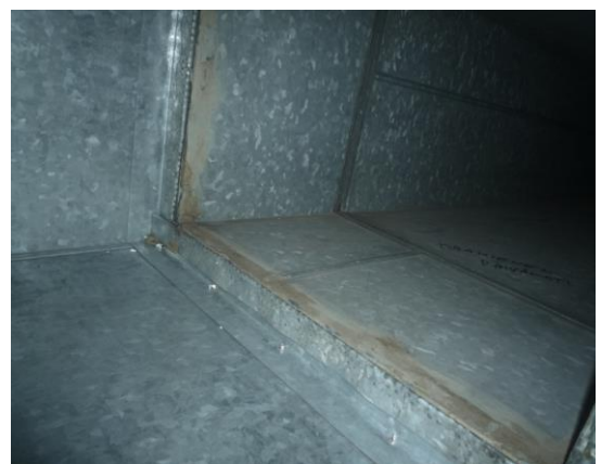
Kuva 106. Tuloilmakanavassa tavanomaista pölyntymistä.
