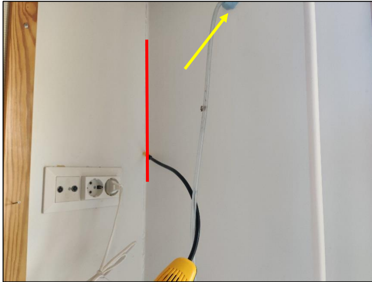
Kuva 90. Merkkiainekoe tilassa 43. Vuotokohdat on merkattu kuvaan punaisella viivalla ja kaasun syöttöreikä keltaisella nuolella.
