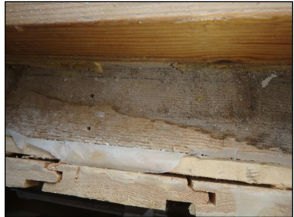
Kuva 77. Alakarmissa on näkyvissä jälkiä voimakkaista vesivuodoista. Tutkimushetkellä puurakenteissa ei havaittu kohonneita kosteuspitoisuuksia.
