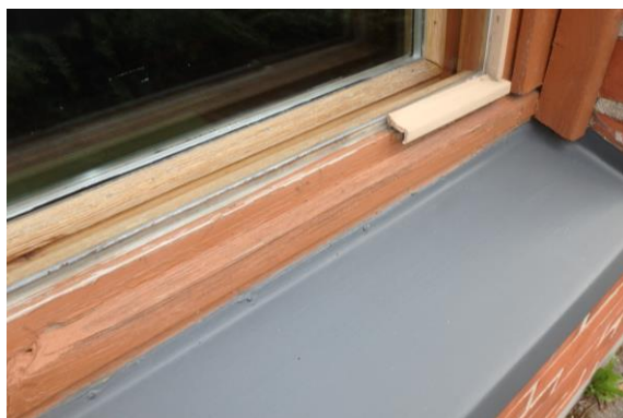
Kuva 30. Ikkunan listasta puuttuu pala.
