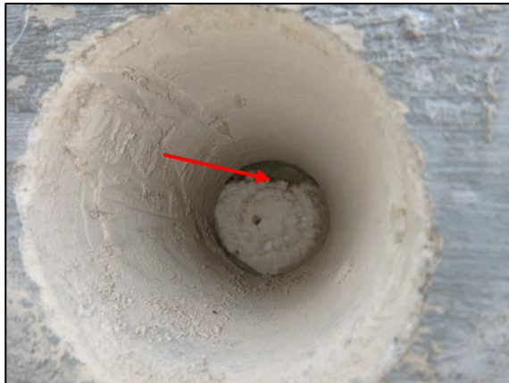
Kuva 40. Rakenneavaus 2. Ulkoseinän alaohjauspuun ja maanpinnan välinen korkoero on avauskohdalla noin 70 mm. Ulkoseinän alaosa on maanpinnan yläpuolella.
