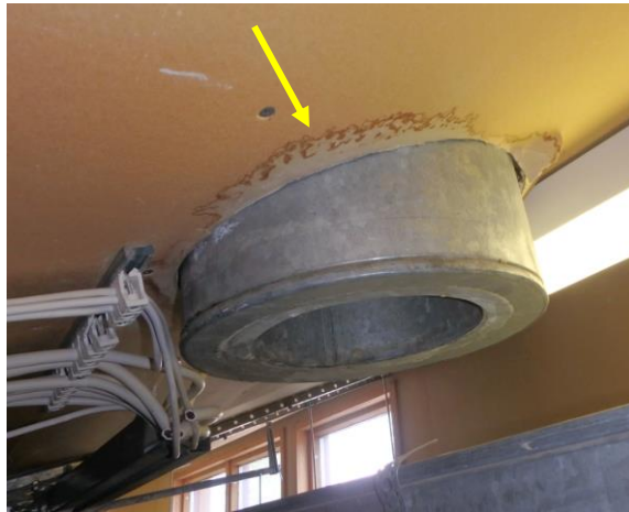
Kuva 92. Ilmanvaihtokonehuoneen katossa kosteusjälkiä.
