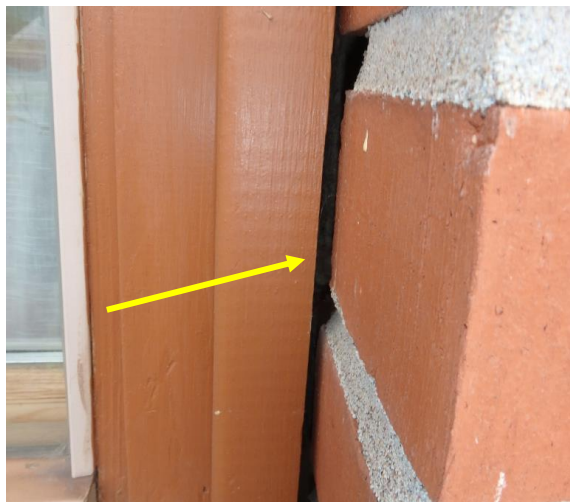
Kuva 28. Ikkunan ja seinän välinen liitos epätiivis.
