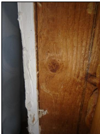
Kuva 78. Muovikalvoa ei ole liitetty tiiviisti ikkunarakenteeseen.
