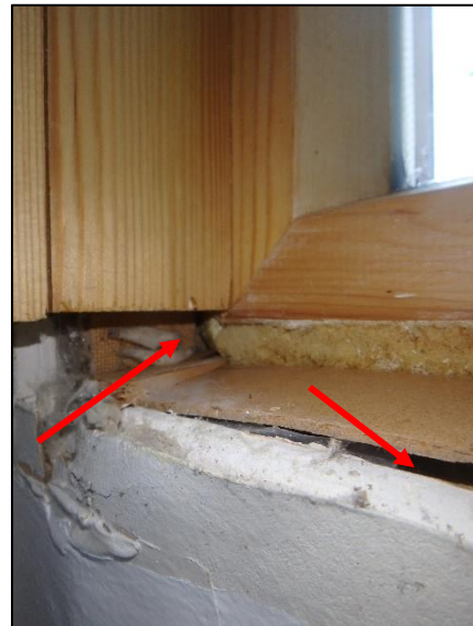
Kuva 89. Uretaanivaahdotuksessa on rako ylänurkassa. Myös karmissa on pystysuuntainen rako.
