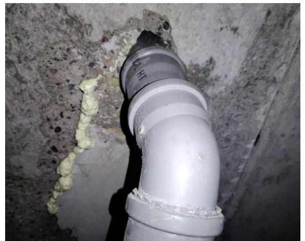
Kuva 8. Alapohjan läpivienti tiivistämätön.
