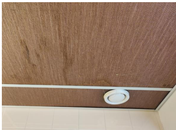
Kuva 94. Vessan 29 alaslasketussa katossa valumajälkiä.
