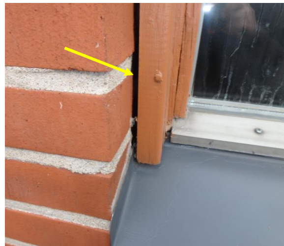
Kuva 29. Ikkunan ja seinän välinen liitos epätiivis.
