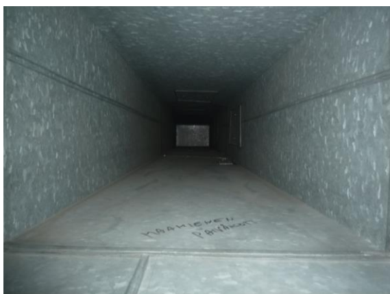
Kuva 105. Tuloilmakanavassa tavanomaista pölyntymistä.
