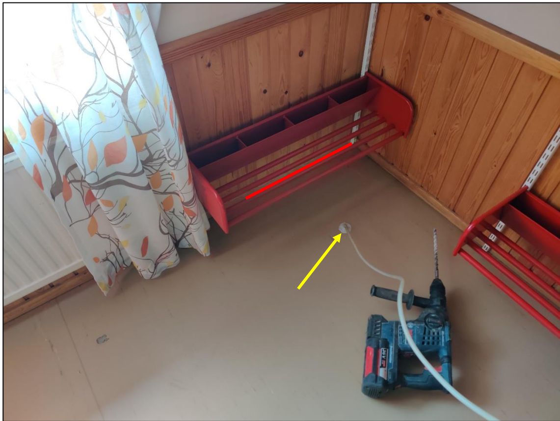
Kuva 18. Merkkiainekoe tilassa 04. Vuotokohdat on merkattu kuvaan punaisella viivalla ja kaasun syöttöreikä keltaisella nuolella.
