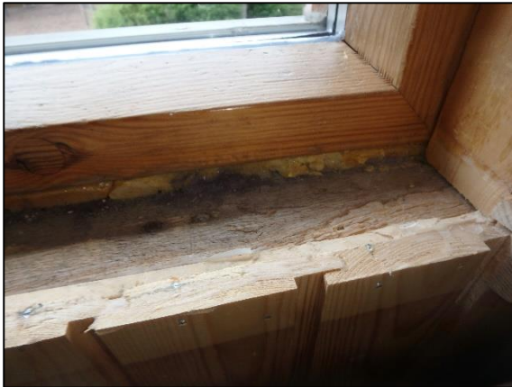
Kuva 76. Ikkunatilkkeenä on käytetty polyuretaanivaahtoa.
