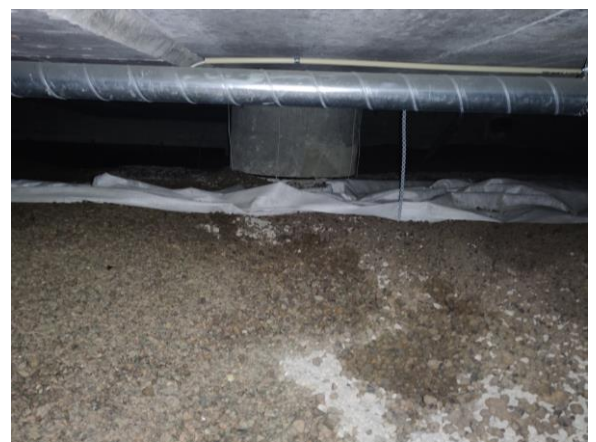
Kuva 4. Ryömintätilan maapohjan päällä paikoitellen muovia.
