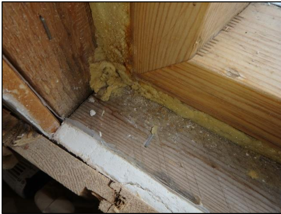
Kuva 80. Ikkunatilkkeenä on käytetty polyuretaanivaahtoa.
