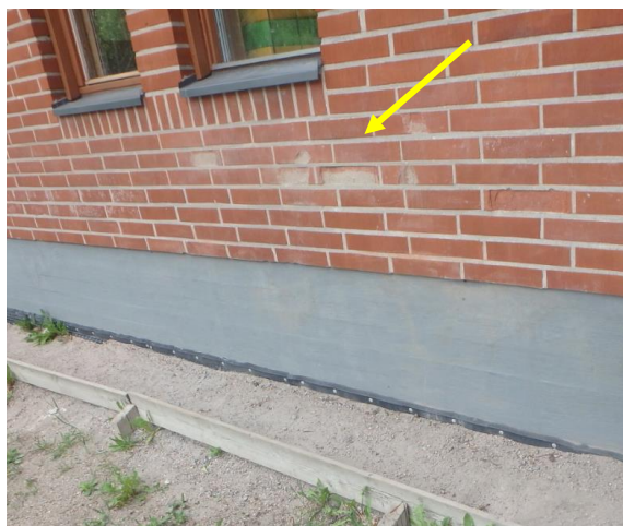
Kuva 26. Lounaan puoleisen päädyn tiilissä paikoitellen rapautumaa.
