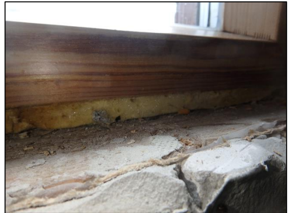
Kuva 85. Rakenteiden liitoksissa (kipsilevyt ja karmit) sekä uretaanivaahdossa on aistinvaraisesti havaittavissa epätiiveyden kohtia.
