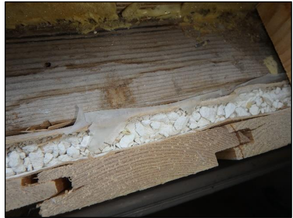
Kuva 81. Alakarmissa on näkyvissä jälkiä voimakkaista vesivuodoista. Tutkimushetkellä puurakenteissa ei havaittu kohonneita kosteuspitoisuuksia.
