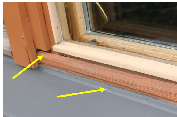
Kuva 31. Vasemmalla rako. Ikkunanpellityksen ylös-nosto on kiinnitetty joissain ikkunoissa nauiloilla kiinni listan päälle (ajan myötä irttoilee ja syntyy rako).
