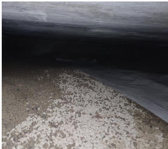
Kuva 5. Ryömintätilan maapohjan päällä paikoitellen muovia.
