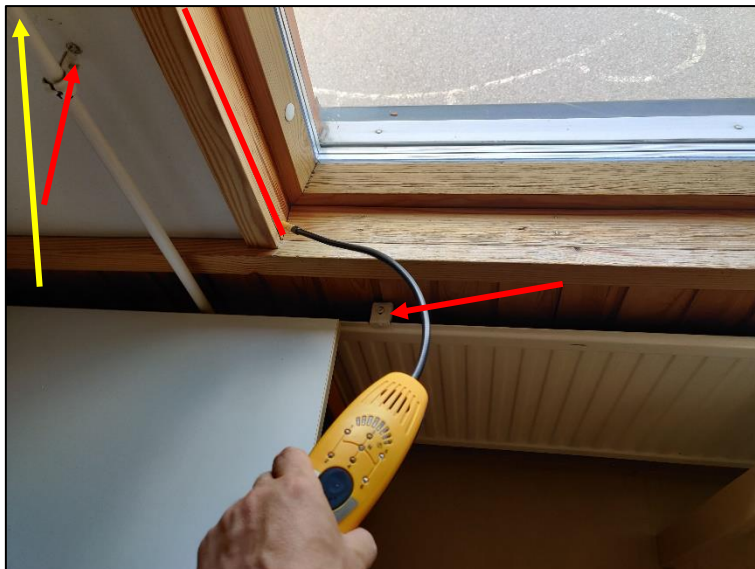
Kuva 91. Merkkiainekoe tilassa 43. Vuotokohdat on merkattu kuvaan punaisella viivalla ja kaasun syöttöreikä keltaisella nuolella.
