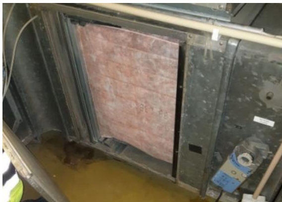
Kuva 103. Tuloilmasuodatin oli puhdas ja oikein asennettu.
