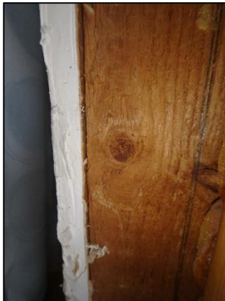
Kuva 82. Muovikalvoa ei ole liitetty tiiviisti ikkunarakenteeseen.
