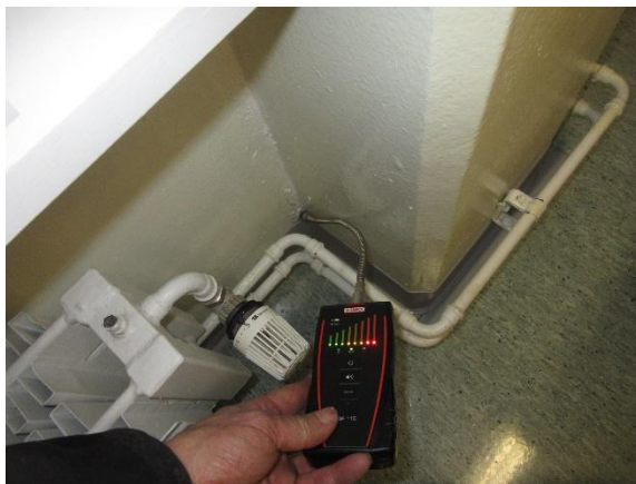
Ilmavuotoa ikkunaelementin ja pilarin liittymästä muovimaton ylösnoston kohdalla (tila 101)
