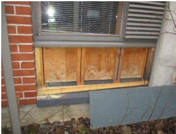
Kuva 6.12. RA.06-US. Ikkunaelementin runko- puissa todettiin tummentumaa alaosassa.
