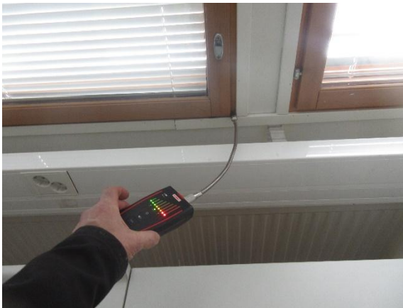
Ilmavuotoa ikkunakarmin kohdalla (tila 208)
