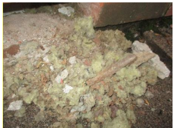
Kuva 6.5. RA.09 ja RA.10 todettiin eristeessä jyrsijän pesä ja ulostetta.
