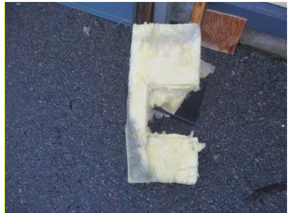
Kuva 6.13. RA.05-US. Ikkunaelementtien kohdalla mineraalivillan nurkissa todettiin tummentumaa, joka viittaa ilman liikkumiseen rakenteessa.
