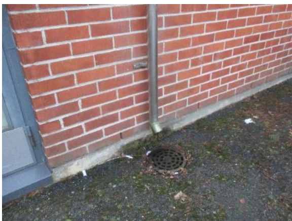
Kuva 4.9. Sadevedet on ohjattu osittain syöksytorvilla sadevesijärjestelmään. Syöksytorvista tuleva roiskevesi on aiheuttanut paikoin kosteusrasitusta sokkeli-/perustusrakenteisiin.
