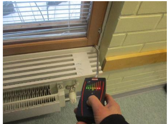
Ilmavuotoa ikkunan karmista (153)
