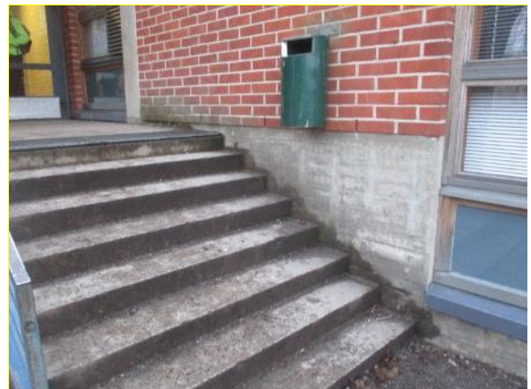
Kuva 4.4. Lännen puoleinen sisäänkäynti. Betoninen porrastasanne ohjaa vettä sokkeli- ja ulkoseinärakenteisiin.
