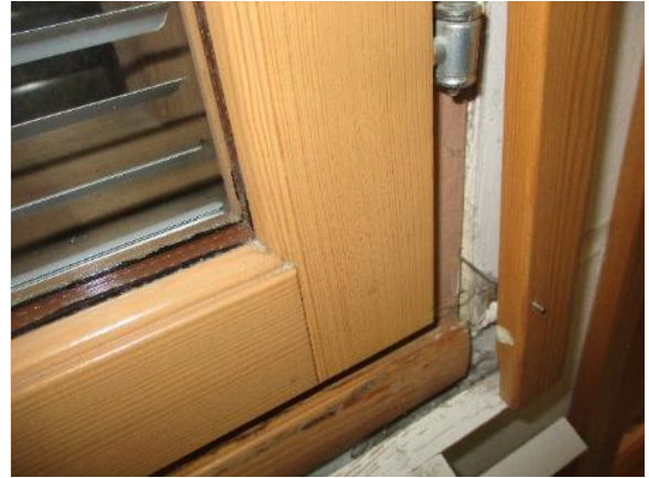
Kuva 6.15. Toisen sisäpihan oven viereisessä ik- kunassa on sisäpuolella kosteusvauriojälkiä.
