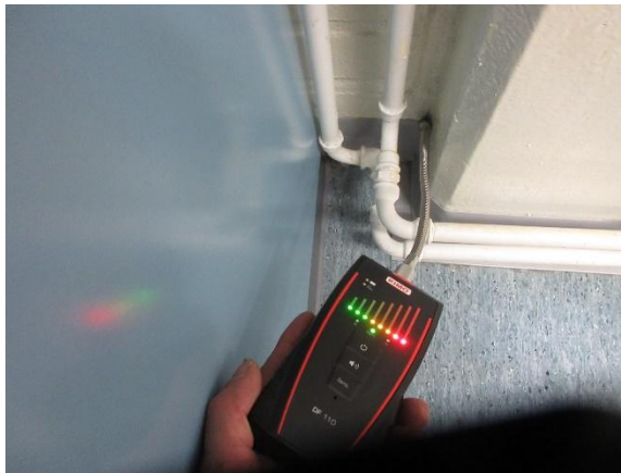
Ilmavuotoa ikkunasivulla pilarin kohdalla ulkoseinän ja alapohjan liittymässä (tila 238)
