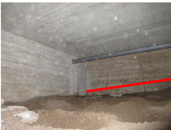
Kuva 5.14. Ryömintätilassa todettiin kaksi lievää putkivuotoa.
