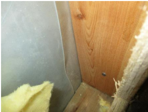
Kuva 6.10. RA.05-US. Rakenneavauskohdassa höyrynsulkumuovi ei ylety runkopuun ja sisäverhouslevyn väliin eikä sitä ole teipattu.
