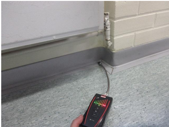
Pistemäinen Ilmavuoto ikkunaelementin ja ulkoseinän liittymästä (tila 135)
