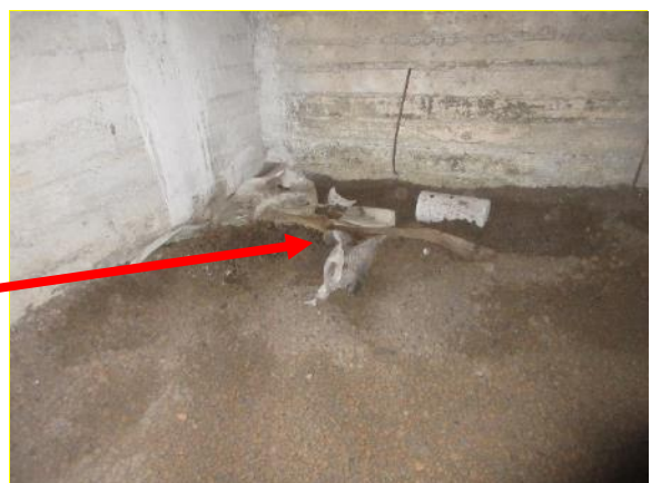
Kuva 5.15. Ryömintätilassa todettiin kaksi lievää putkivuotoa.
