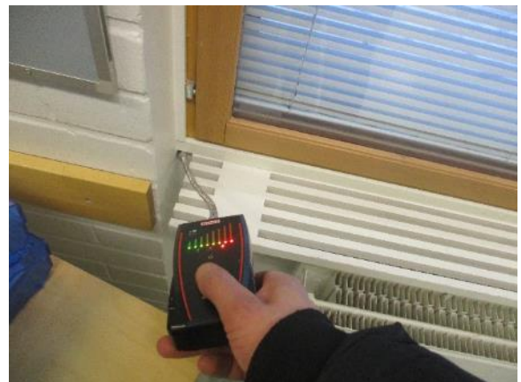
Lievä pistemäinen Ilmavuoto ikkunaelementin ja ulkoseinän liittymästä (tila 114)
