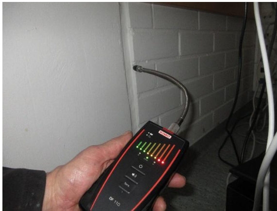
Ilmavuotoa tiiliseinän ja pilarin liittymästä (tila 167)
