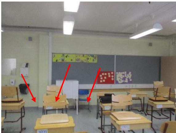
Ilmavuotokohdat luokan päätyseinustalla (tila 130)
