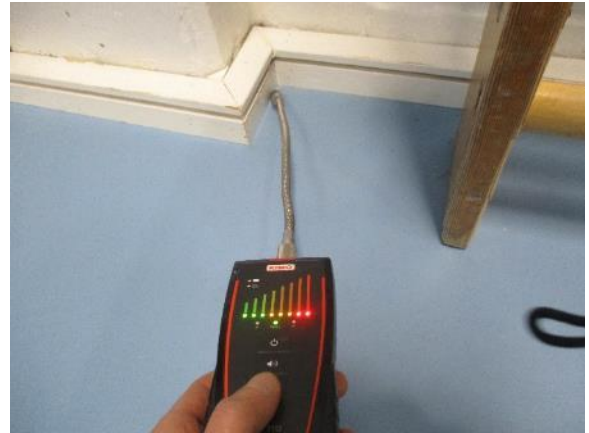
Ilmavuotoa AP-US-liittymästä (liikuntasali)
