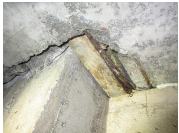
Kuva 5.13. Pilareiden kohdalla alapohjarakenteessa todettiin muottilautojen jäämiä.
