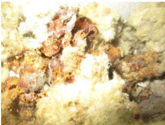
Kuva 6.6. RA.09 ja RA.10 todettiin eristeessä jyrsijän pesä ja ulostetta.
