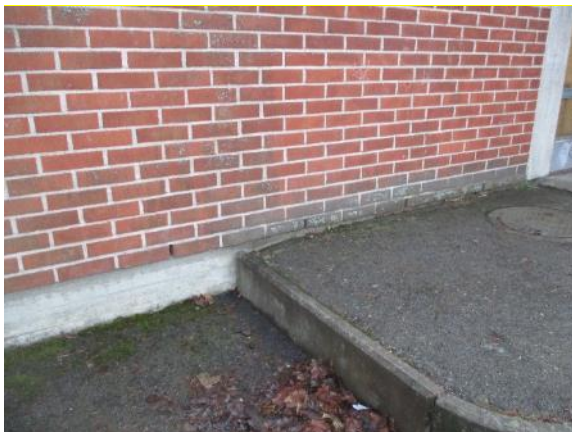
Kuva 4.3. Pohjoisen puoleinen sisäänkäynti. Betonitasanne ohjaa vettä sokkeli- ja ulkoseinärakenteisiin.
