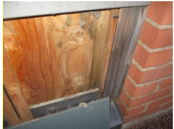
Kuva 6.11. RA.04-US. Tuulensuojalevyssä todettiin tummentumaa ulkopinnalla.
