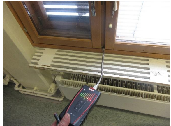
Pistemäinen Ilmavuoto ikkunakarmin kohdalla (tila 135)
