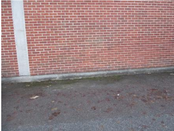
Kuva 4.1. Yleiskuva liikuntasalin päädyistä. Sokkelissa on havaittavissa tummentumaa (levä-ym. kasvustoa)
