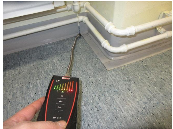
Ilmavuotoa ikkunaelementin ja pilarin liittymästä muovimaton ylösnoston kohdalla (tila 171)
