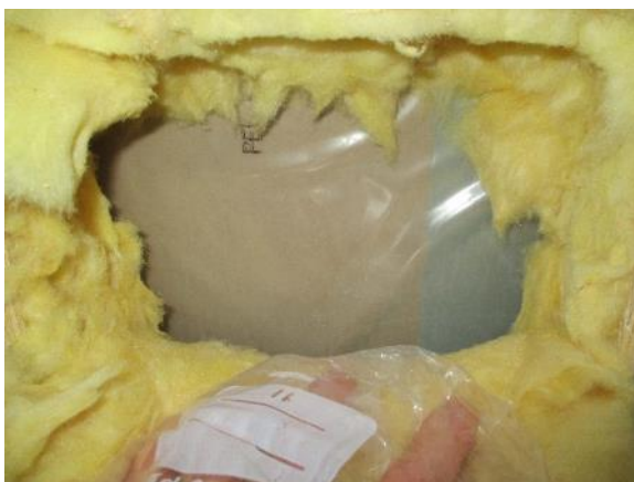
Kuva 6.8. RA.01-US. Ikkunoiden kohdalla todettiin rakenteessa höyrynsulkumuovi. Kohdassa muovit on limitetty, mutta ei ole teipattu.
