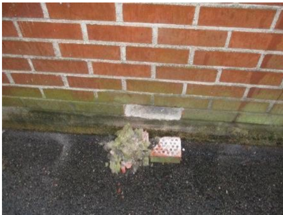
Kuva 6.2. RA.03-US. Liikuntasalin pääty. Kohdalla matala sokkeli ja tiilien ulkopinnassa leväkasvustoa.
