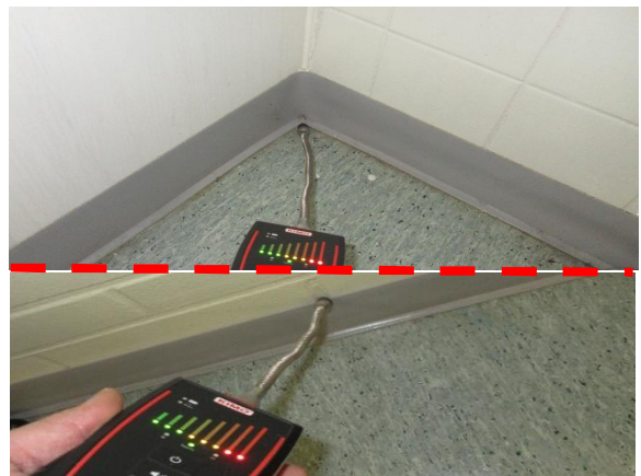
Pistemäisiä ilmavuotoja muovimaton ylösnoston kohdalla (tila 101)
