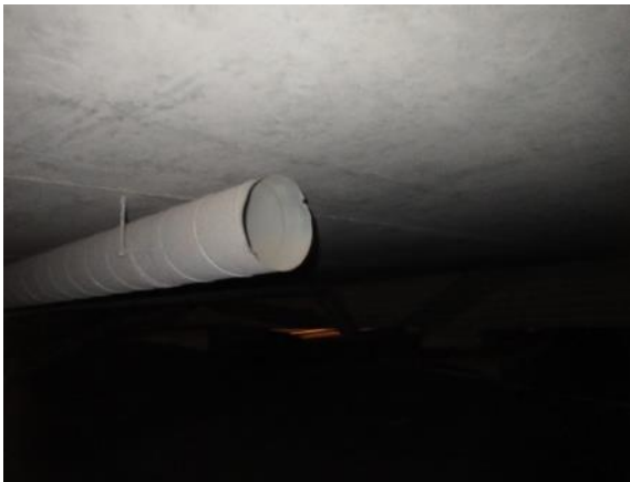
Kuva 5.10. Ryömintätiloissa on koneellinen poisto. Poistokanavassa ei ole päätelaitetta.
