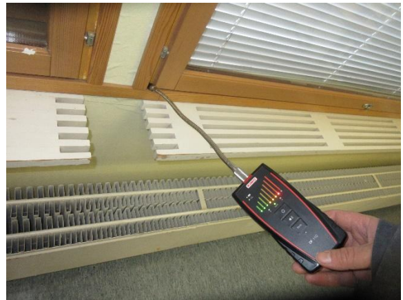
Pistemäinen Ilmavuoto ikkunakarmin kohdalla (tila 238)
