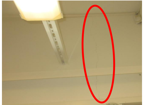
Kuva 6.15. Sisäpinnoissa todettiin halkeilua lähes kaikissa huoneissa. Arvion mukaan halkeilu rajoittuu maali ja tasoitekerrokseen.
