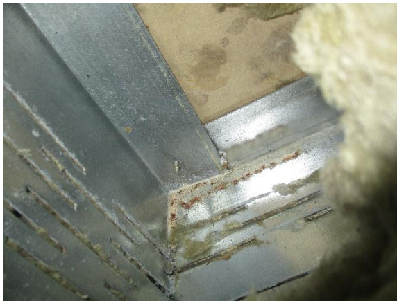
Kuva 6.8. RA.14-US. Metalliosissa ja tuulensuojalevyn sisäpinnassa todettiin kosteusjälkiä ja ruostetta.
