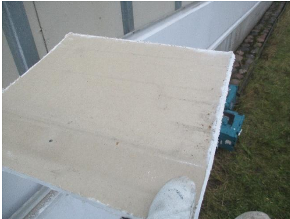
Kuva 6.6. RA.12-US. Tuulensuojalevyn sisäpin- nassa on kosteusjäkiä.
