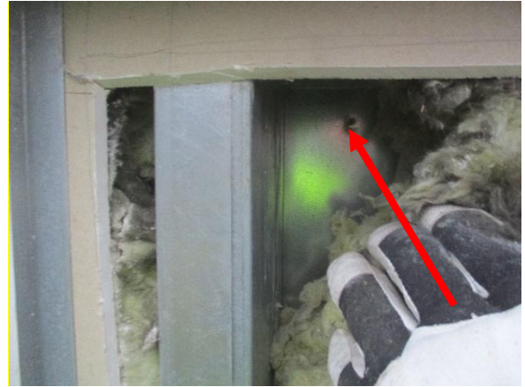
Kuva 6.3. RA.15-US. Mineraalivillan ja sisäverhouslevyn välissä on teräslevy höyrinsulkuna. Levyssä todettiin ruuvien reikä.
