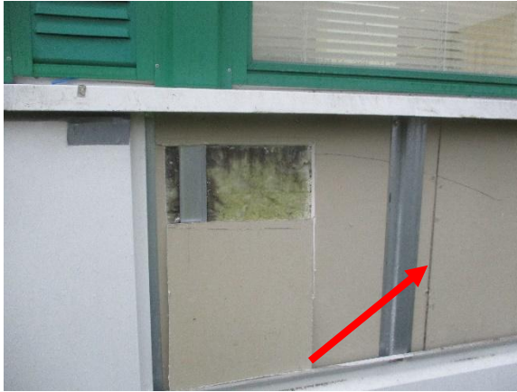
Kuva 6.2. RA.15-US. Mineraalivillassa näkyy tummentumia metallisen rungon molemmilla puolilla. Tuulensuojalevyjen saumoja ei ole teipattu.
