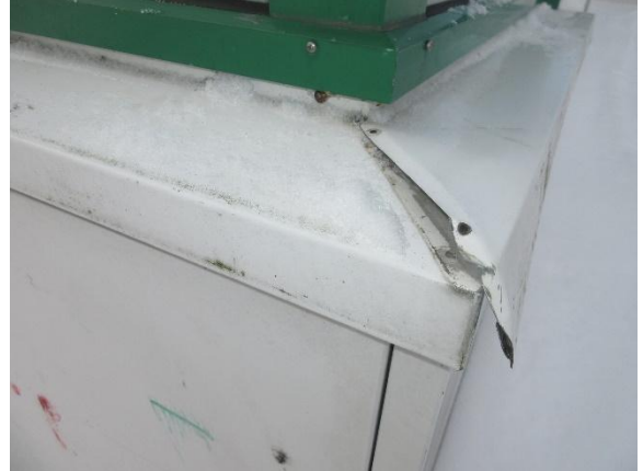
Kuva 6.13. Ikkunoiden vesipeltien jiiriliitos on auki hammashoitolan pohjoisen puoleisessa nurkassa.
