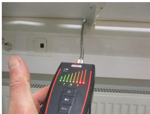
Ilmavuotoa Ikkunalaudan kiinnikkeen kohdalta.
