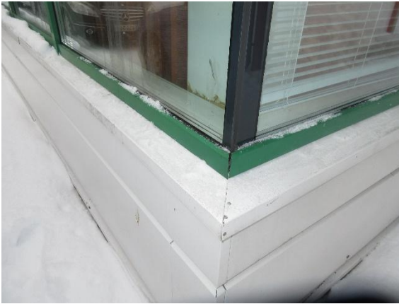
Kuva 6.12. Ikkunarakenteen listan nurkkaliitos on auki hammashoitolan idän puoleisessa nurkassa.
