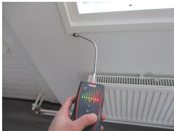
Ilmavuotoa ikkunan ja ulkoseinän liittymästä
