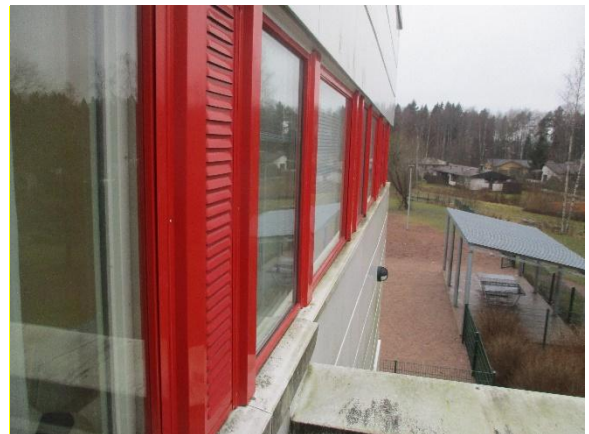
Kuva 6.11. Ikkunoiden vesipellit kaatavat paikoin rakennukseen päin.
