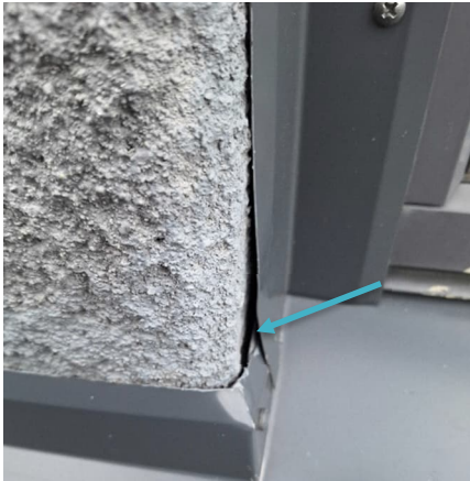
Kuva 87 Ikkunapellityksiä ei ole tiivistetty ulkopinnasta.
