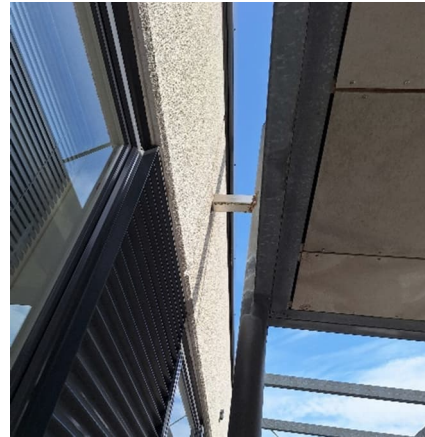
Kuva 15 Kate ei ole täysin kiinni ulkoseinässä.
