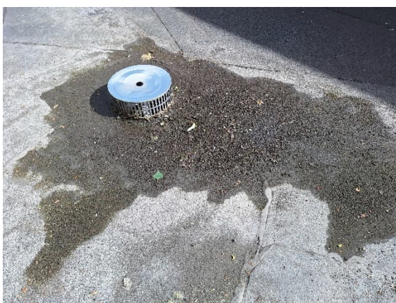
Kuva 111 A-osan yksi sadevesikaivon edusta on hieman likainen, johon vesi jää makamaan.
