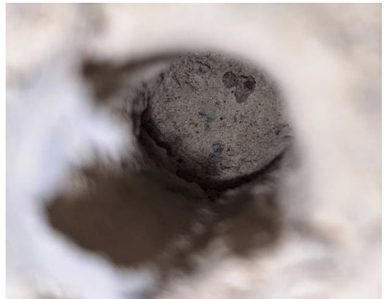
Kuva 45 Ensimmäinen poraus meni läpi 45 mm kohdalla. Betonien välissä oli hieman tyhjää tilaa.
