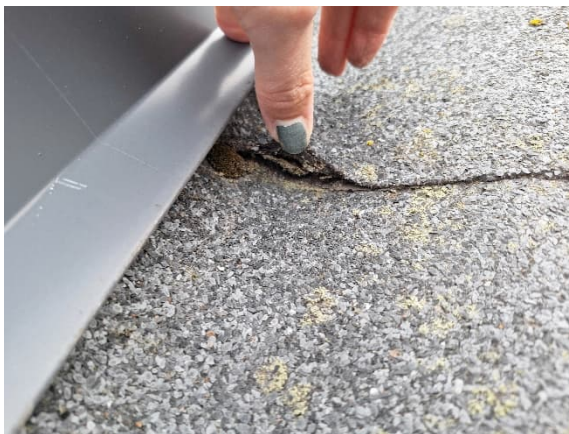
Kuva 109 A-osan IV-konehuoneen vieressä on bitumihuopa hieman irti alustaan.
