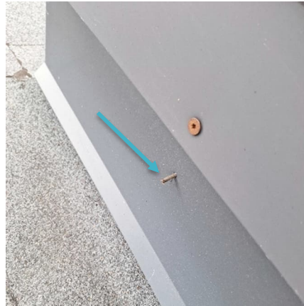
Kuva 102 Kannen ruuvi on katkennut.
