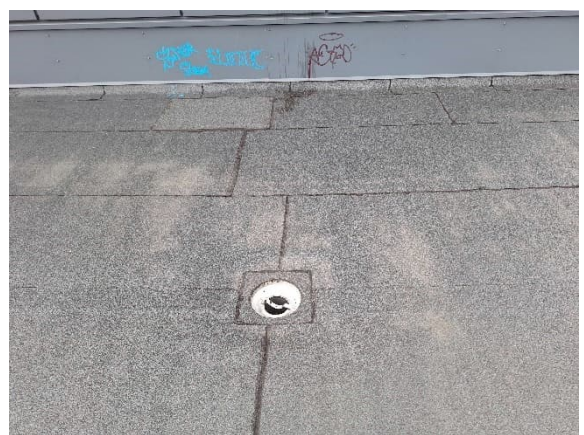
Kuva 112 A-osan yksi sadevesikaivon roskasihti puuttuu eteläpäädyssä.
