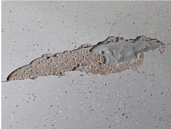
Kuva 24 Kotitalousluokan rikkoutunut epoksilaattia.
