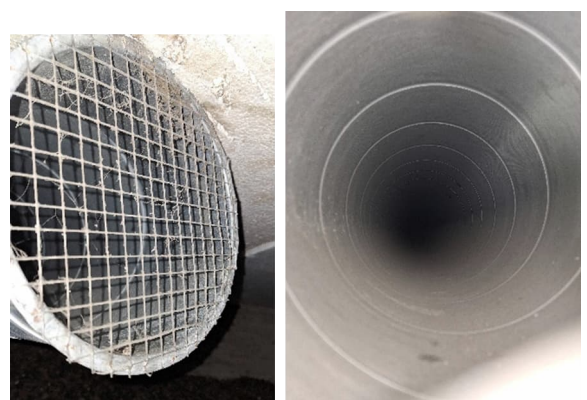
Kuva 71 Alustatilan poistoilmanvaihtokanava, jossa on jonkun verran pölykertymää.
