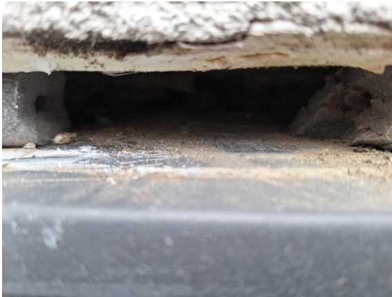
Kuva 75 US2, pellitys jatkuu alapuolisen betonin verran eli 90 mm.
