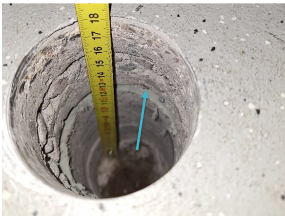
Kuva 42 Avauskohta kokonaisuudessaan on 180 mm syvä. Nuolen kohdalla on muovikerros.
