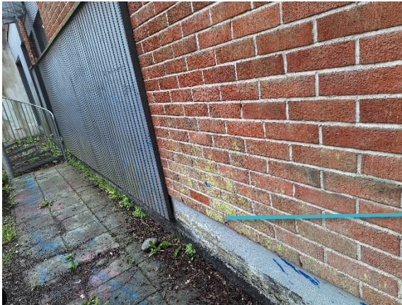
Kuva 89 Pohjoispäädyn ulkoseinää. Julkisivussa on nähtävissä leväkasvua.
