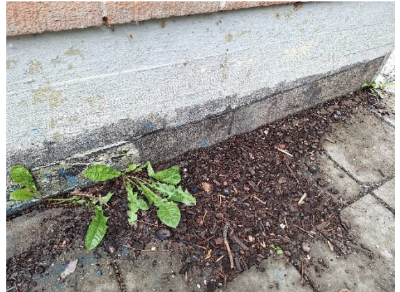
Kuva 21 A-osan pohjoispäädyssä on näkyvissä bitumikermiä.
