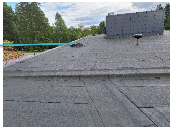
Kuva 100 A-osan laajennusosalla oleva avonainen kattoluukku, josta ilmoitettiin kaupungille heti havainnon jälkeen.
