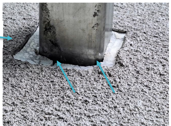
Kuva 80 US4:n yläpuolella oleva katoksen kiinnityskohta on epätiivis.
