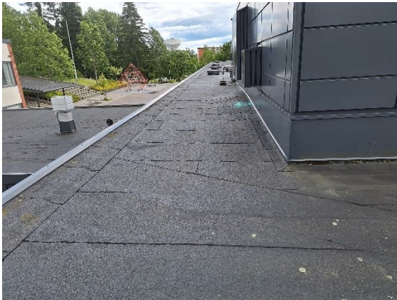
Kuva 103 A-osan vesikatolla on runsaasti paikkoja ja jonkin verran ilmakupruja.
