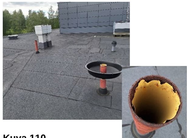
Kuva 110 A-osan puutteellisia viemärin tuuletusputkia, joista puuttuu hatut. Putkien sisäpinnoite on jo osin irti.
