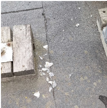
Kuva 107 Lasijätettä A-osan katolla.
