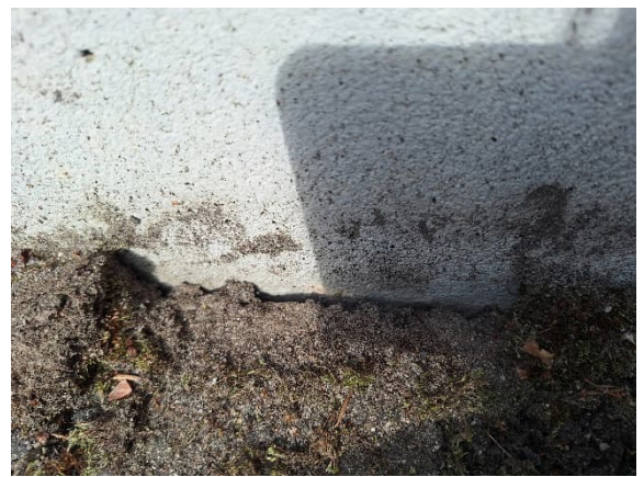
Kuva 11 Asfaltissa on ylösnostot rakennuksen sokkelissa, mutta ylösnosto on sisäpihalla irti seinästä.
