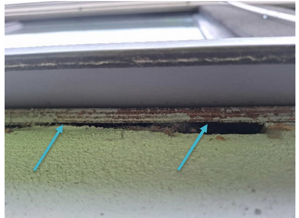
Kuva 88 Ikkunapellityksen alaosa. Peltien ylitys on riittävä.
