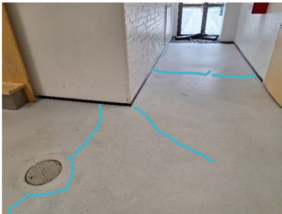
Kuva 26 Käytävän epoksissa on halkeamia (korostettu sinisellä).
