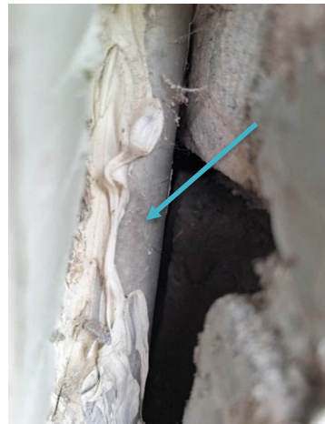
Kuva 86 US7, putki jatkuu sokkelirakenteessa.
