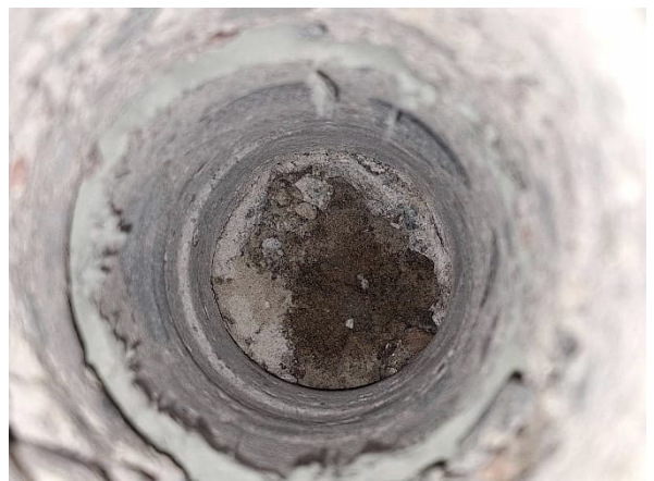
Kuva 43 Alapohjan alapuolella on hienojakoista hiekkaa.
