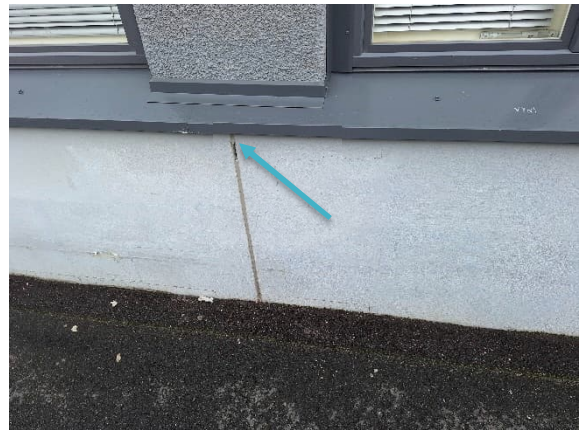
Kuva 82 US6, tilan 150 pilarin kohdalle, ikkunapeltien alapuolelle
