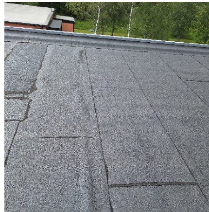
Kuva 108 A-osalla olevia ilmakupruja bitumin alla.
