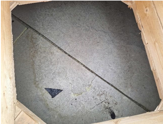
Kuva 101 Vettä on satanut eristeiden päälle katto- luukusta.
