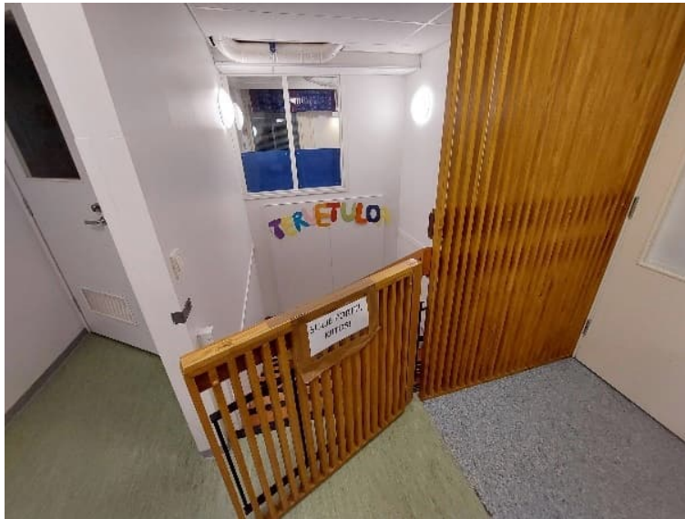
Kuva 26. Eteiseen on keittiön ja portaikon edustalle uusittu lattiapäällystettä edelliskesän vesivahingon jäljiltä (vihreä matto).
