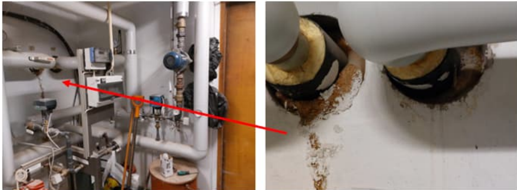
Kuva 16. Lämmönjakohuoneen maanvastaisen seinän kaksi läpivientä on tiivistetty polyuretaanimassalla. Pintakosteudenosoittimilla ei havaittu kohonneita kosteuspitoisuuksia.
