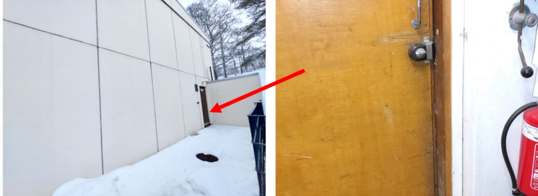
Kuva 40. Lämmönjakohuoneen oven tiiveydessä oli puutteita.
