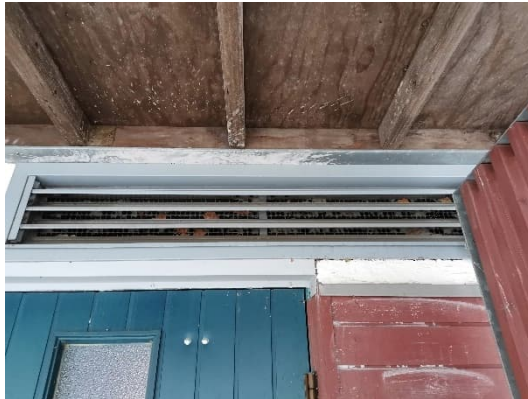
Kuva 73. Yleiskuva tuloilmakoneen ulkoilmasäleiköstä. Ulkoilmasäleiköissä havaittiin roska ja pölykertymää.
