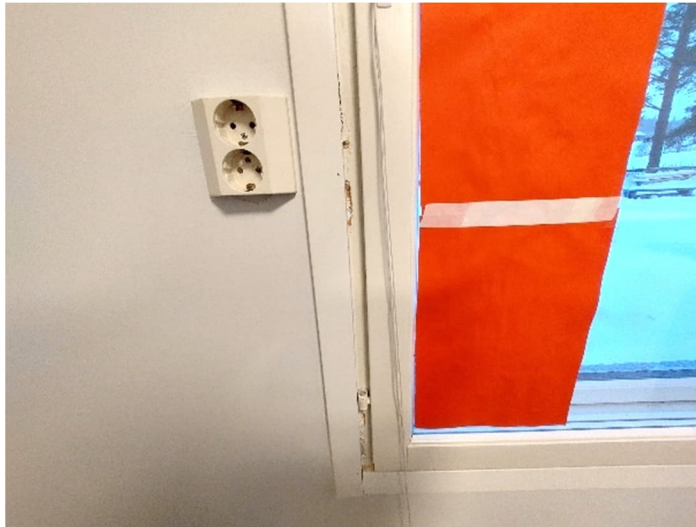
Kuva 46. Tilassa 015 ikkunakarmissa oli koloja, joita on yritetty paikata silikonimassalla.
