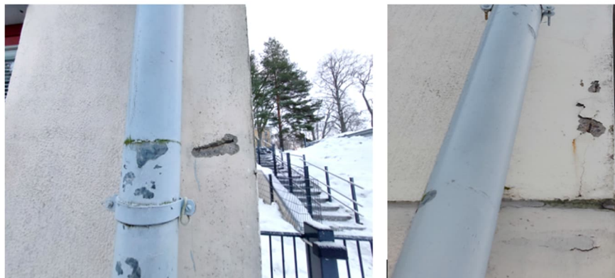
Kuva 41. Länsijulkisivulla havaittiin useammassa kohdassa vaurioita julkisivulla. Pinnoite oli lohkeillut ja länsisivun eteläpäädyssä oli paikoin teräkset pinnassa. Elementtisaumaus oli lohkeillut ja menettänyt elastisuutensa.
