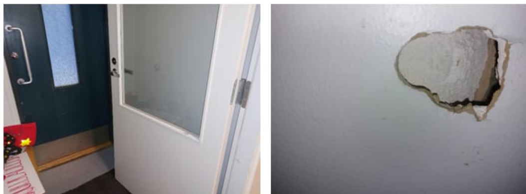
Kuva 57. Kellarikerroksen liikuntatilasta 004 on uloskäynti. Tuulikaapin seinässä on ovenkahvan aiheuttama reikä.
