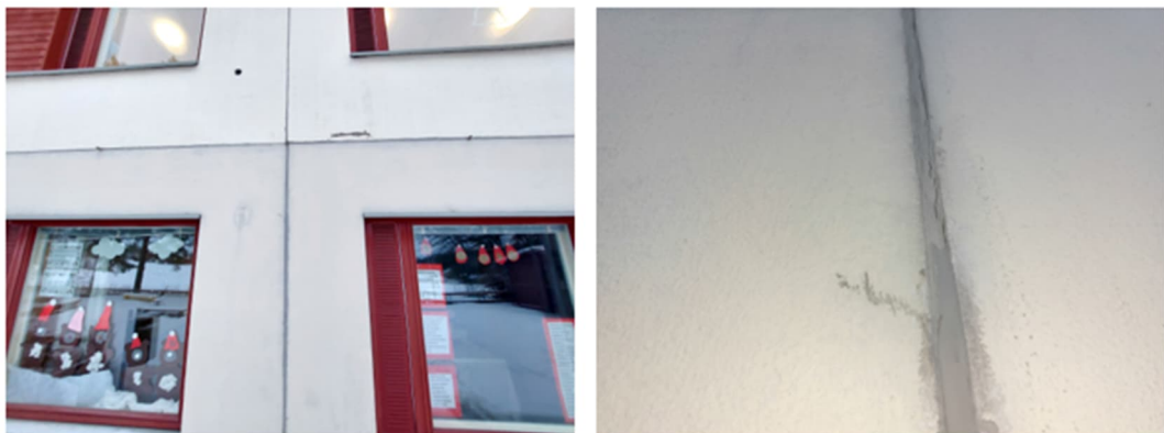
Kuva 43. Rakennuksen länsisivulla elementtisaumauksia on paikoin paranneltu, mutta vanhaat saumaukset ovat kovettuneet.
