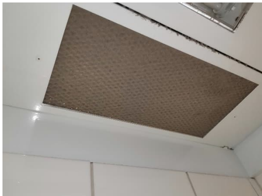
Kuva 74. Yleiskuva 035 pienkeittiön liesikuvusta. Liesikuvun rasvasuodatin on erittäin pölyinen.
