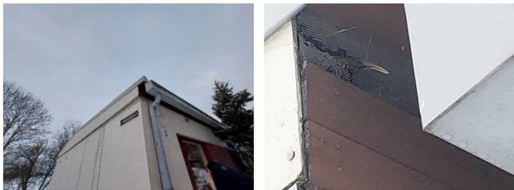
Kuva 64. Räystään alla oleva eläinverkko yläpohjatilaan on rikkoutunut.
