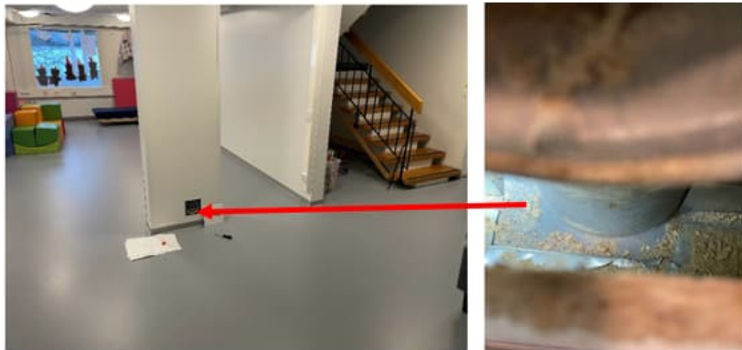
Kuva 14. Tilassa 004 avattiin kotelointia, josta havaittiin alapohjaläpiviennin olevan tiivistetty TKR-peruspinnoitteella. Koteloinnin pohjalla oli sahanpurua. Koteloinnin avaus on merkitty pohjakuvaliitteeseen tunnisteella K2.
