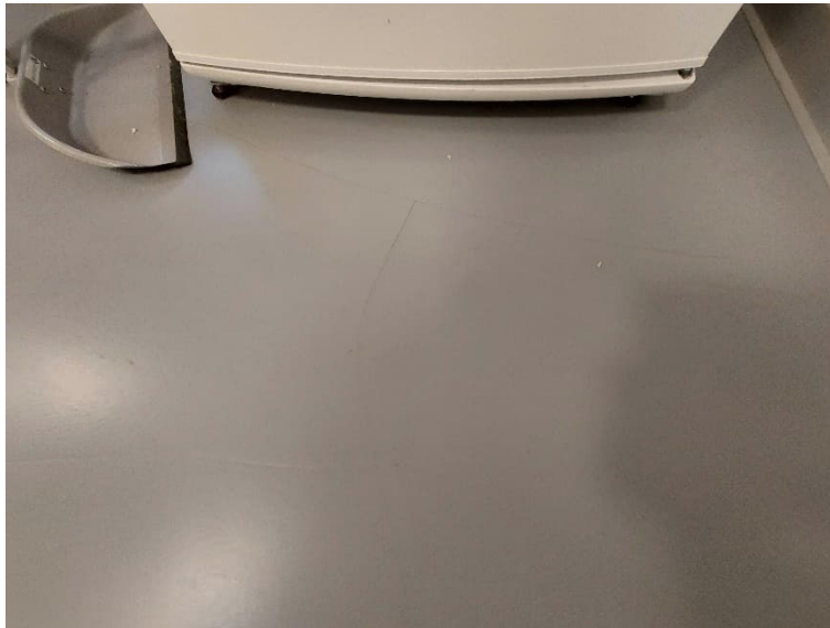
Kuva 12. Kellaritilojen polyuretaanipinnoitteessa oli useammissa kohdassa säröilyä, mikä vaikutti olevan pinnoitteen alla.
