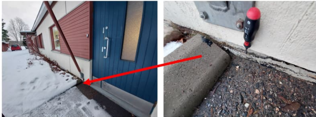
Kuva 6. Rakennuksen itäjulkisivulla perusmuurilevyn yläreunasta puuttuu reunalista.
