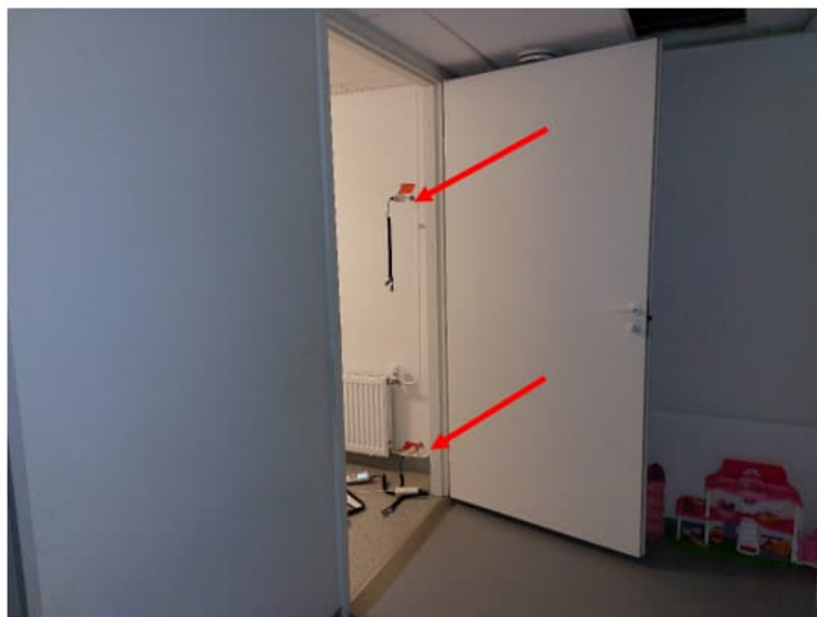
Kuva 18. WC-tilan 011 maanvastaisen seinän hetkelliset kosteusmittauspisteet eristetilassa. Mittapisteet tehtiin seinän alaosaan (H13: 95 %RH) ja keskivaiheille (H15: 51 %RH).
