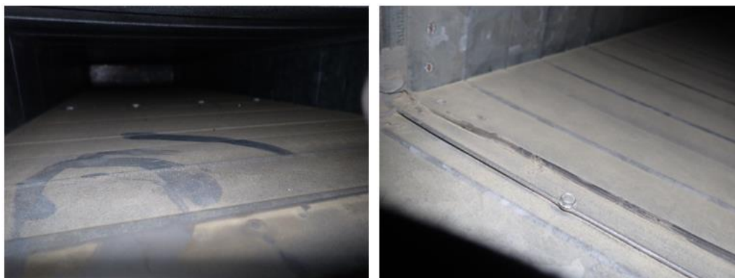
Kuva 71. Tuloilmakoneiden LIK-3 ja LIK-1 palvelualueiden tuloilmakanavissa on koh-talaisen runsasta, ulkoilmasta peräisin olevaa likakertymää.
