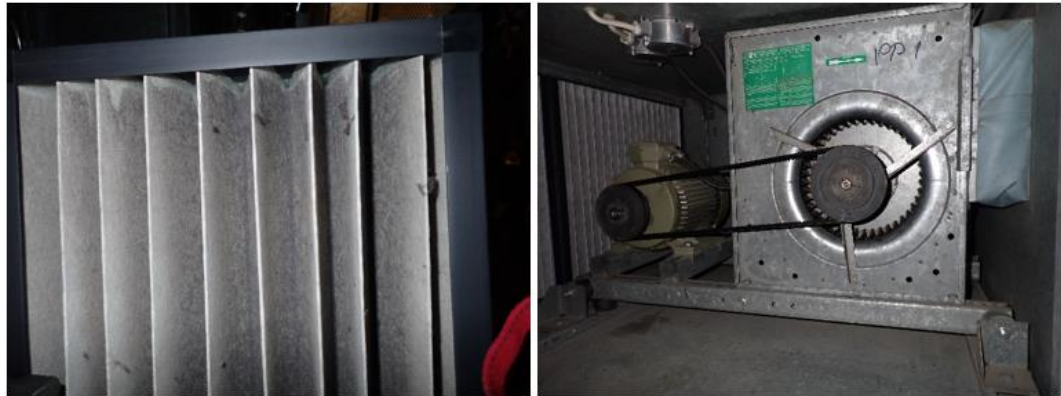
Kuva 56. Poistoilmasuodatin on likainen. Poistoilmapuhaltimen käyntiäänessä ei havaittu poikkeavia sivuääniä. Puhaltimen siivekkeissä havaittiin vähäistä pölykertymää.
