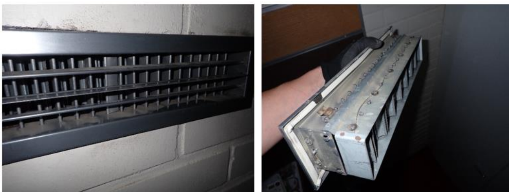
Kuva 73. Tuloilmasäleiköt oli tarkastetuilta osin säädetty puhaltamaan vaakatasossa sekä yläviistoon. Tuloilman päätelaitteissa oli ulkoilmapölyä. Tuloilman päätelaitteissa ei havaittu avoimia mineraalivillalähteitä.
