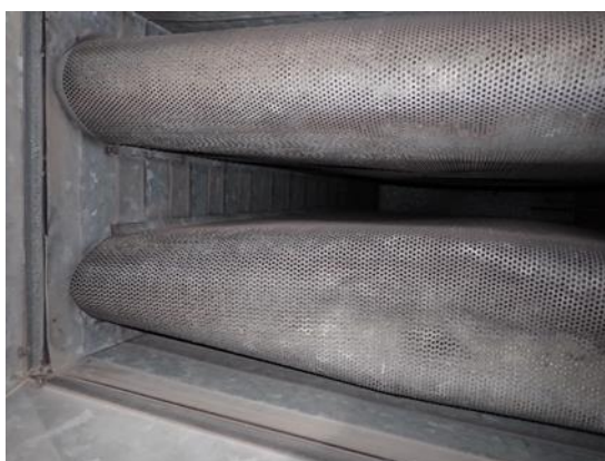
Kuva 66. Tuloilmakanavan reikäpellillä verhotun äänenvaimentimen materiaalista ei saatu täyttä varmuutta. Äänenvaimentimesta irtosi runsaasti pölymäistä epäpuhtautta.
