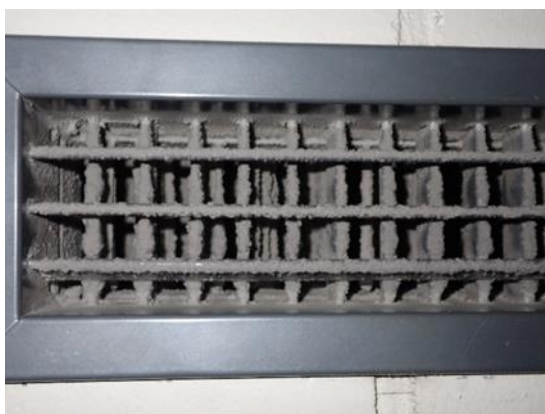
Kuva 74. Poistoilmasäleiköissä havaittiin yleisesti runsasta pölykertymää.
