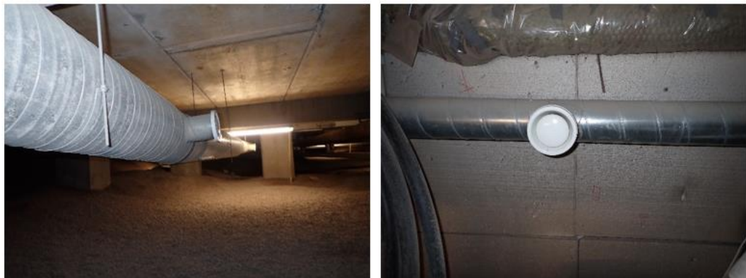
Kuva 13. Yleiskuvat ryömintätilan poistoilmakanavista sekä päätelaitteesta.
