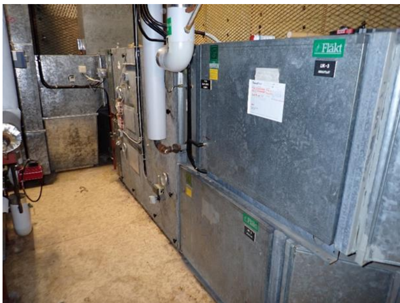
Kuva 60. Yleiskuva ilmanvaihtokoneesta LIK-3 / PP3. Poistoilmakone sijaitsee tuloilmakoneen alla.
