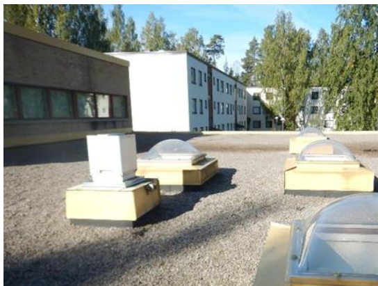
Kuva 69. Yleiskuva vesikatolla sijaitsevasta huippuimurista.
