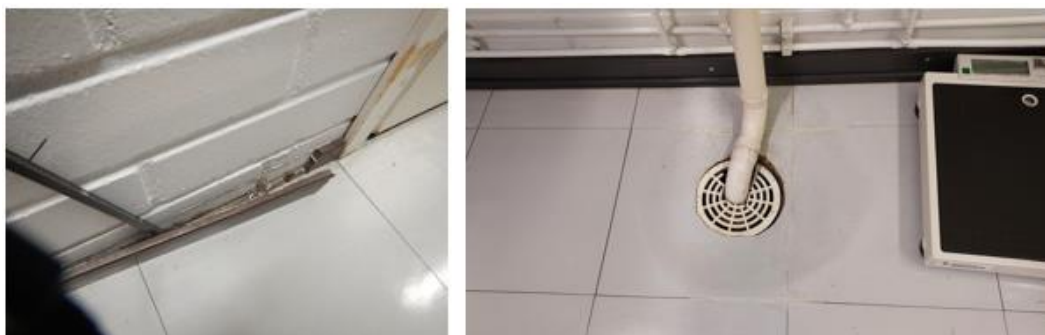
Kuva 31. Ulkoseinäliittymät alapohjaan ja väliseinäliittymät kellarin kohdalla välipohjaan on tiivistetty. Tiivistetyissä kohdissa on leveämpi jalkalista kuin tiivistämättömissä kohdassa.
