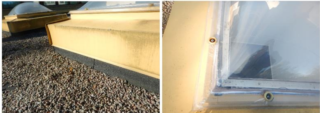
Kuva 49. Yhdessä kattoikkunan kuvassa oli halkeama ja lasin sisäpuolelle oli kondensoitunut kosteutta. Ikkunakupujen kiinnitysruuviin suojatulpat puuttuivat lähes joka kohdasta. Kattoikkunoiden ylösnostokermi olivat hyväkuntoiset.
