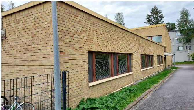
Kuva 9. Länsijulkisivun puolella on asfaltoitu kulkutie. Sokkelin vierustalla on kasvillisuutta ja maanpinnassa painauma. Liikuntasalin kohdalla on sepelikerros sokkelin vierellä.
