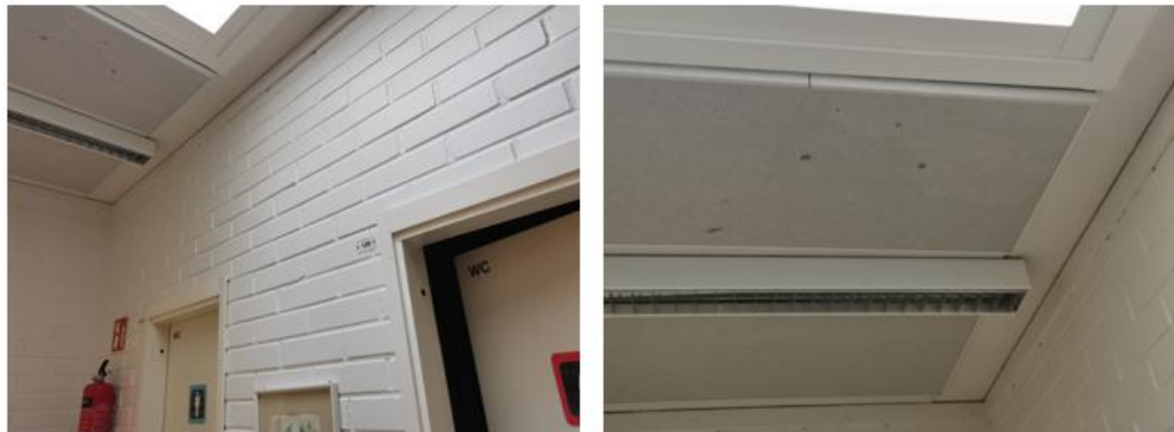
Kuva 42. Käytävän 1.05 kattoikkunan kohdalla havaittiin vanhaa kosteusjälkeä akustolevyn pinnassa.
