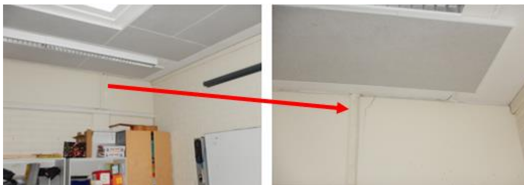
Kuva 30. Tilan 1.26 väliseinän yläosassa olevassa elementissä on halkeama elementtisauman vieressä.
