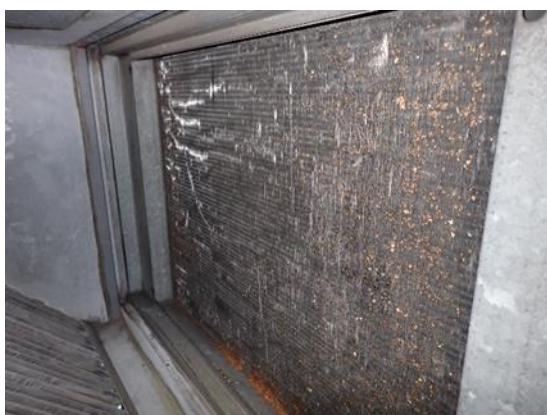
Kuva 64. Lämmityspatterin painepuoli on hyvin likainen ja kolhiintunut.
