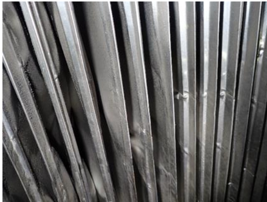
Kuva 68. LTO-kuution pinnoilla on runsasta pölykertymää.
