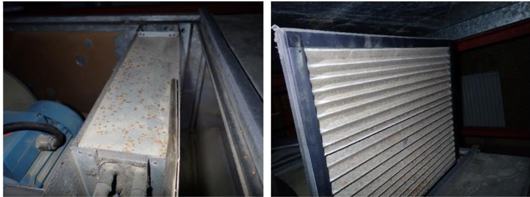
Kuva 58. Ilmanvaihtokoneen sisäpuolella on runsaasti ulkoilmasta peräisin olevaa epäpuhtautta. Tuloilmasuodatin on likainen ja suodattimen ja koneen rungon väliset tiivisteet ovat osin huonokuntoiset.
