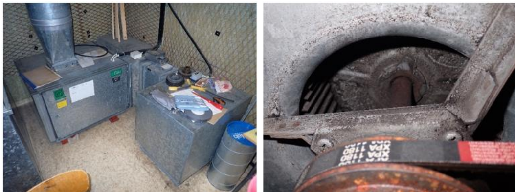
Kuva 59. Yleiskuva keittiön poistoilmakoneesta. Koneessa ei ole poistoilman suodattusta. Poistoilmapuhallin on hyvin likainen.
