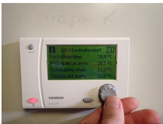
Kuva 61. Yleiskuva tuloilmakoneen säätölaitteen hallintapaneelistä. Tuloilman lämpötilan asetusarvo on 22 °C.
