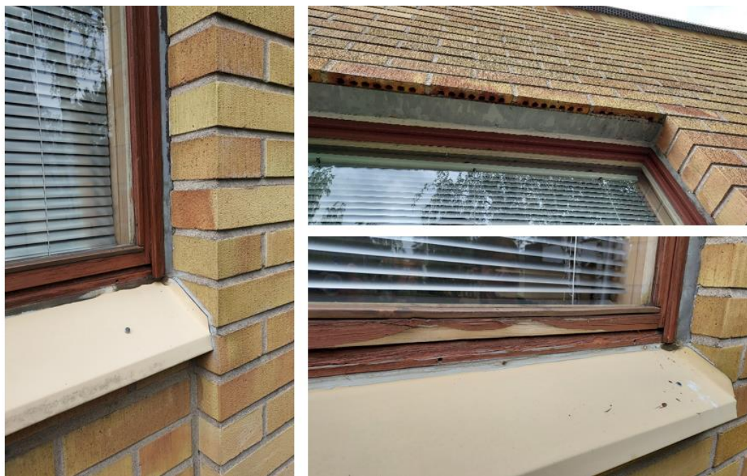
Kuva 34. Ikkunoiden vesipelleissä on riittävä kallistus. Ikkunaliittymät ja vesipellin liittymät on tiivistetty joustavalla massalla. Itäjulkisivun ikkunapuitteiden maalipinta on rapistunut.
