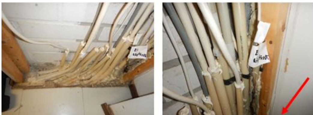
Kuva 16. Vahtimestarin kopissa 1.33 olevassa koteloinnissa on sähköputkiasennuksia, joita on tiivistetty joustavalla massalla. Yksi sähköputki oli jäänyt tiivistämättä.
