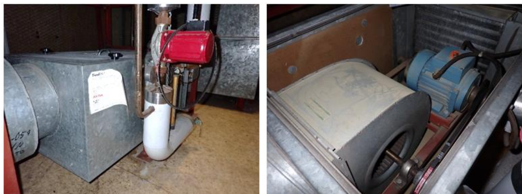
Kuva 57. Ulkoilmapeltiä ohjaava toimilaite on todennäköisesti alkuperäinen. Raitisilmapelti ei sulkeutunut koneen sammuaessa (turvakytkimeltä).
