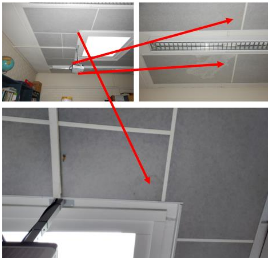
Kuva 43. Tilassa 1.26 havaittiin akustolevyjen pinnalla kosteusjälkeä. Kosteusjäljet olivat lähinnä ontelolaatan sauman kohdalla ja kattoikkunaliittymän kohdalla.
