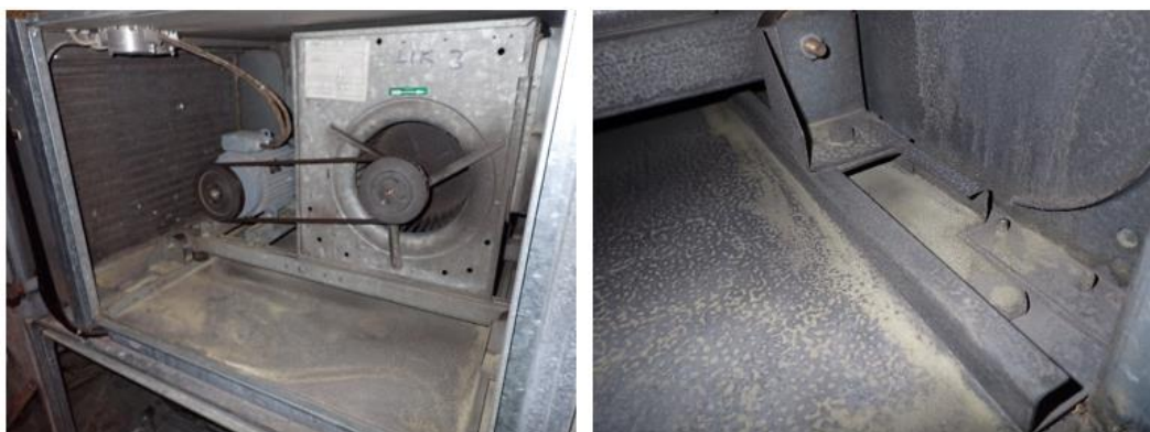
Kuva 65. Yleiskuva hihnavetoisesta tuloilmapuhaltimesta. Tuloilmapuhallinkammiossa on runsaasti hienojakoista ulkoilmapölyä.
