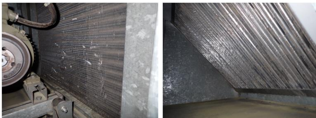
Kuva 53. Lämmityspatteri on likainen ja lamelleissa on kolhuja. LTO-kuution lämmön-siirtopinnoilla on runsasta likakertymää ja kammion pohjalla on runsaasti ulkoilmasta peräisin olevia epäpuhtauksia.
