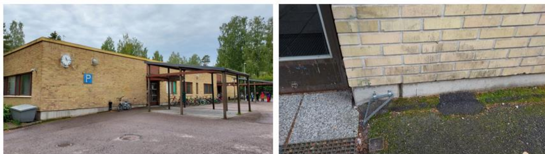
Kuva 8. Rakennuksen pohjoispäädyn piha-alue on asfaltoitu. Piha viettää loivasti itään päin, mutta sokkelinvierustalla on monin paikoin sammalta, mikä viittaa kosteuden kertymiseen sokkelin vierelle.
