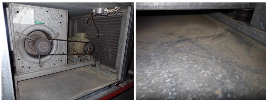
Kuva 54. Tuloilmapuhallin on alkuperäinen hihnavetoinen kammiopuhallin. Puhallin-moottorin laakerissa havaittiin poikkeava sivuääni. Puhallinkammiossa on melko runsaasti hienojakoista epäpuhtautta.
