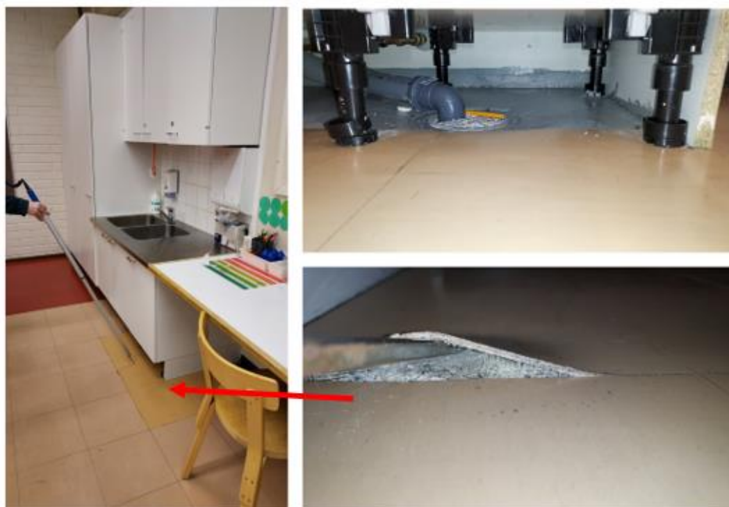
Kuva 25. Tilassa 1.20 on korjattu vesipisteen ympäristöä. Allaskaapin alla takaosassa lattiapinta on käsitelty epoksilla tai muulla vastaavalla pinnoitteella ja etuosassa on kvartsivinyylilaatoitus, jonka alla alusta oli jäänyt kosteaksi. Liimakerros kvartsivinyyli-laatan alla oli venyvä.
