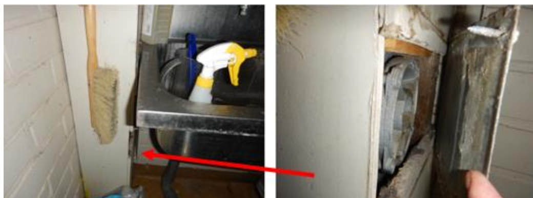
Kuva 22. Siivouskomeron 1.32 koteloinnin tarkastusluukku on huoltotöiden kannalta hankalassa paikassa vesipisteen vieressä. Luukku ei ole tiivis ja koteloinnista oli tarkasteluhetkellä selkeä ilmavirta sisälle päin. Koteloinnin ulkopinnassa havaittiin roiskevesiä.
