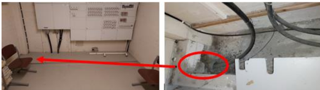
Kuva 14. Kellarikerroksen sähköpääkeskuksen alapohjassa on maaperään avoimia läpivientejä. Sähköpääkeskuksessa ja sen lähistöllä oli maakellarimainen haju.
