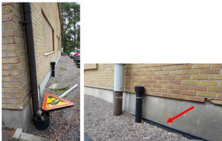
Kuva 6. Rakennuksen eteläpäädyssä liikuntasalin kohdalla on sepelikaistale sokkelin vierellä. Sepelöinnin takaa havaittiin patolevy sokkelia vasten (punainen nuoli). Sepeli, patolevy ja mustat ryömintätilan tuuletusputket on asennettu vuoden 2003 korjauksissa.
