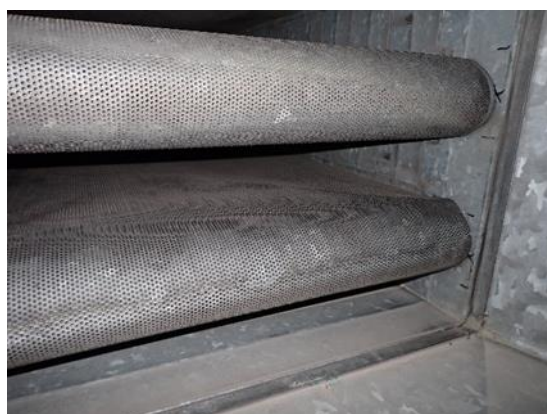
Kuva 55. Tuloilmakanavan äänenvaimennusyksikkö on hyvin pölyinen.
