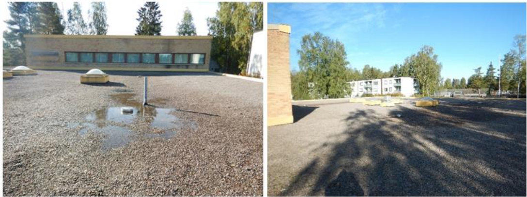
Kuva 48. Yleiskuvia vesikatolta. Vesikatolla oli sateen jäljiltä vesi lammikoitunut katto-kaivon kohdalle. Lehtisihti oli roskainen. Huoltomies puhdisti lehtisihdin tutkimuspäivänä.
