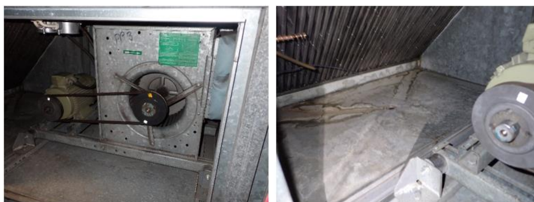
Kuva 67. Yleiskuva hihnavetoisesta poistoilmapuhaltimesta. Puhaltimen käyttöhihna on hyväkuntoinen. Koneen pohjalevyllä on vähäisiä kosteusjälkiä LTO-kuution kohdalla.
