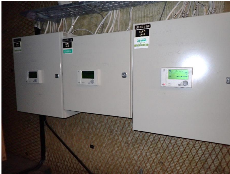
Kuva 50. Yleiskuva ilmanvaihtokoneiden paikallissäätimistä. Ilmanvaihtokonehuoneen seinäpinnoilla on pinnoittamatonta mineraalivillaa.
