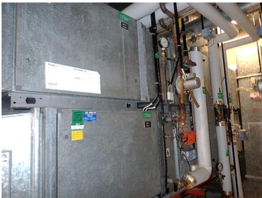
Kuva 51. Yleiskuva ilmanvaihtokoneesta TIK-1/PP1 Huoltoluukkujen lukitusmekanismeissa on puutteita. Poistoilmakone sijaitsee tuloilmakoneen päällä.
