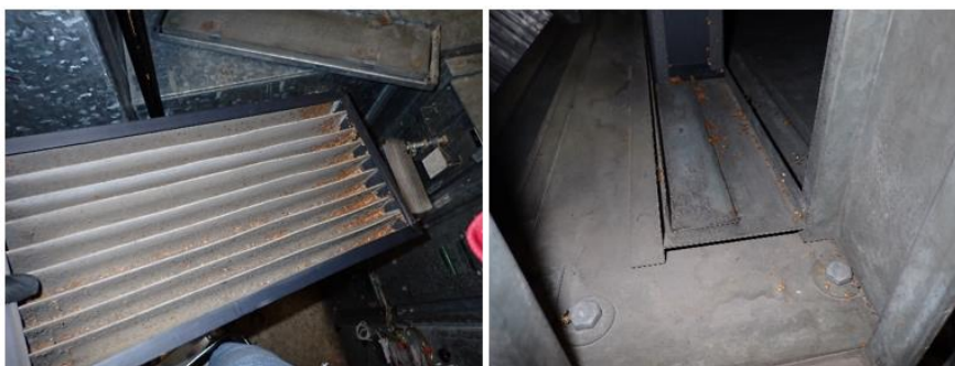
Kuva 52. Tuloilmasuodatin on likainen. Tuloilmasuodatin ei tiivisty kunnolla suodatinkehikkoon.
