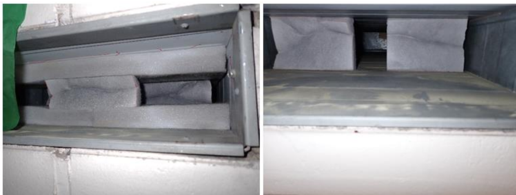
Kuva 72. Yleiskuvat luokkatilojen tuloilmanakanavista päätelaite poistettuna. Osassa tuloilmanakanavia havaittiin ilmeisesti äänenvaimennukseen tarkoitettuja polyesterin pa-loja, joissa havaittiin voimakasta tuloilmaan irtoavaa pölymäistä kertymää.
