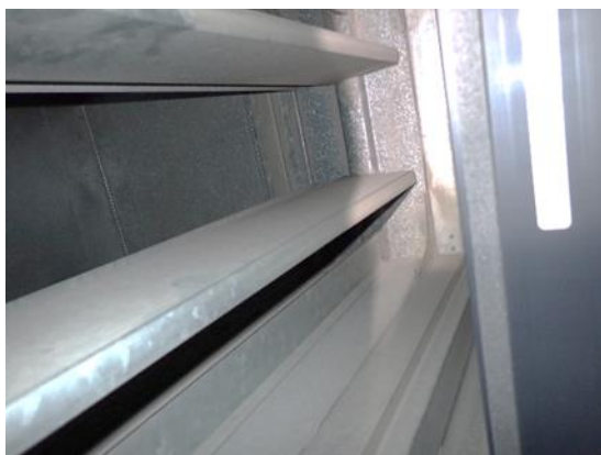
Kuva 62. Raitisilman sulkupellit eivät sulkeutuneet koneen sammuesssa (koneet sammutettiin turvakytkimiltä). Ulkoilmakammion reikäpellityksen alla on todennäköisesti suojaamaton mineraalivilla.
