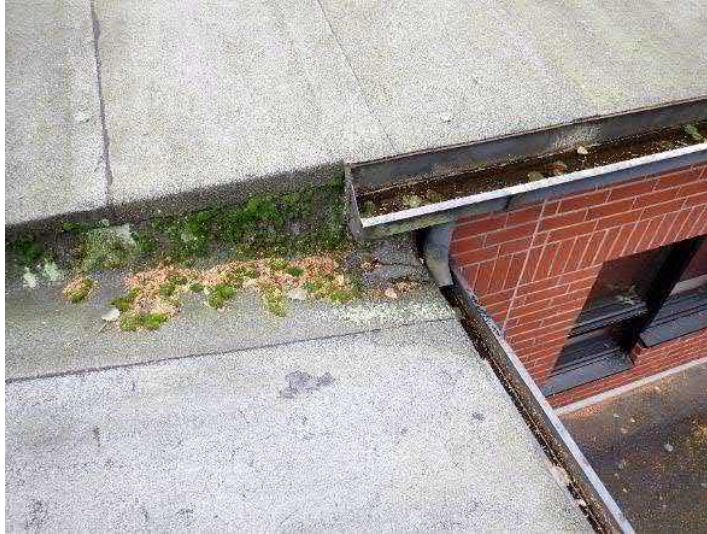
Kuva 44. Räystäät olivat laajalti tukossa ja täynnä vettä. Vesikatolla oli paljon sammalta ja jäkälää.
