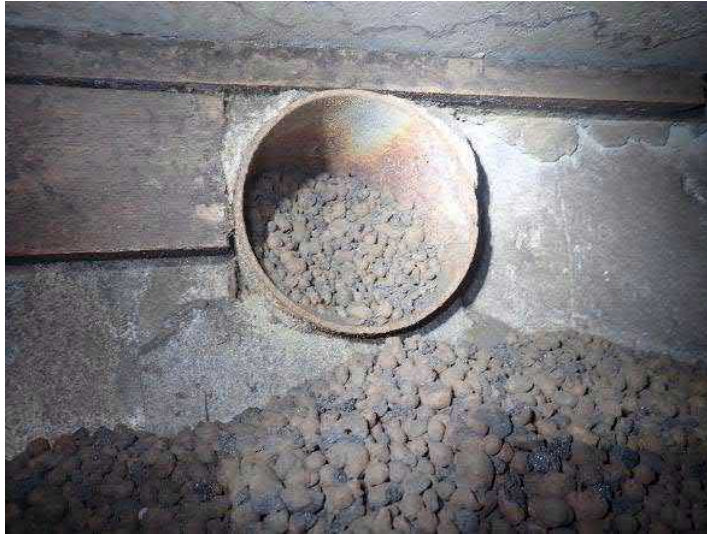
Kuva 12. Ryömintätilan tuloilmaputket olivat yhtä lukuun ottamatta avoimet. Yksi oli tukittu kevytsoralla.
