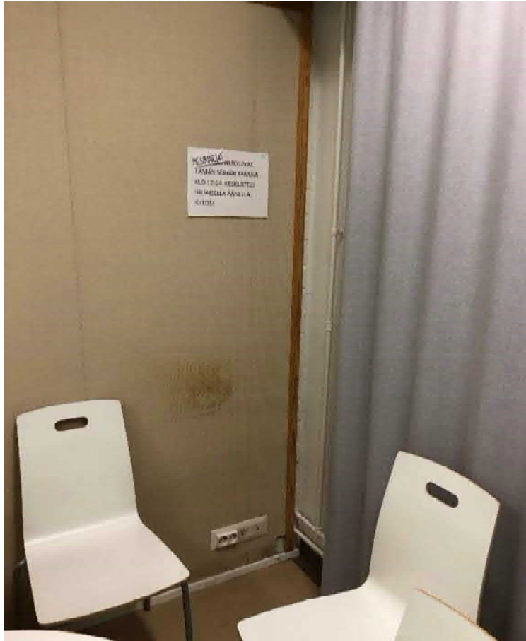
Kuva 33 . Tilassa 33 on vanha ilmoitustaulu. Taulu on tekstiilipintainen ja siitä epäillään emittoituvan tunkkaista hajua tilaan. Taulussa etenkin alaosissa havaittiin tummentumia.
