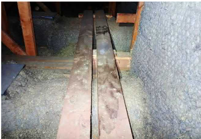
Kuvat 46 ja 47. Vesikaton vanerissa ja käyntilankkujen pinnalla tuuletusputkien kohdalla havaittiin vesivuotojälkiä.
