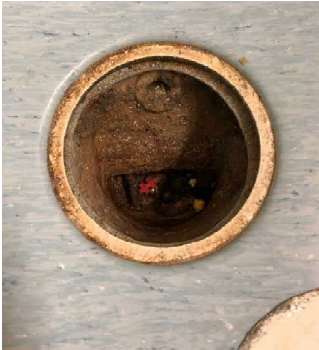
Kuva 8. Tilan 15 vanha lattiakaivo oli peitetty pellinpalalla. Kaivosta havaittiin ilmavirtaus sisätilaan.
