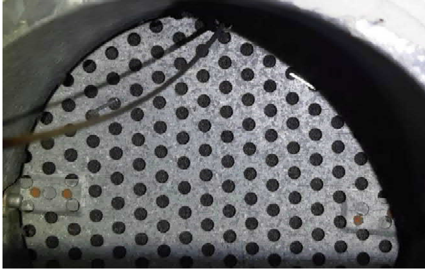
Kuva 54. Alkuperäisissä tuloilmakanavissa havaittiin sulkupelti, jossa saat- taa olla mineraalivillaa.
