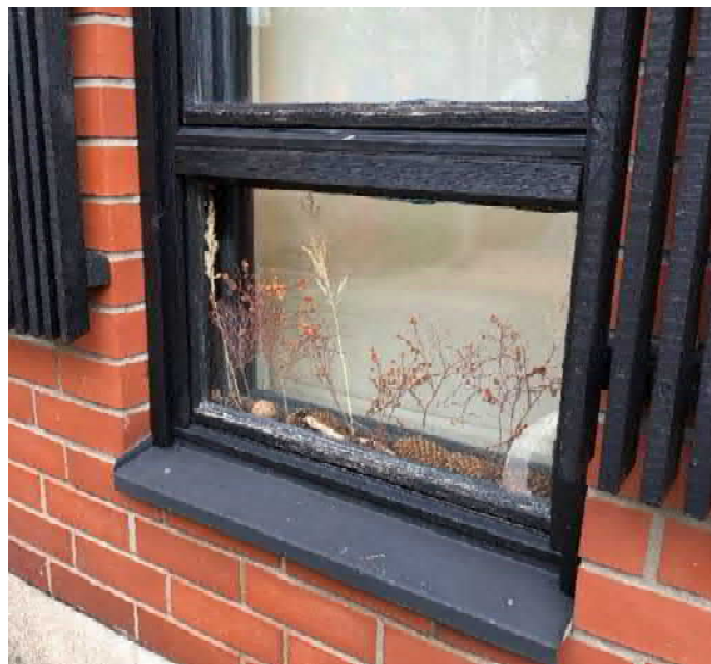
Kuvat 23 ja 24. Rakennuksen ikkunoiden ulkopinnat ovat kuluneet.
