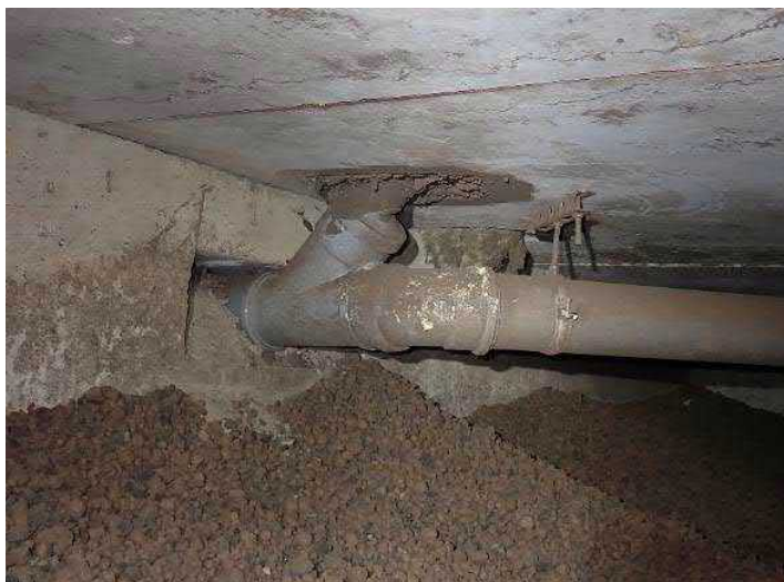
Kuva 11. Alapohjan läpiviennit olivat pääasiassa tiiviin näköisiä. Kuvassa taustalla on kuitenkin yksi mineraalivillalla tulpattu vanha läpivienti.
