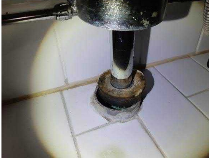
Kuva 6. Tilan 26 lavuaarin viemäritiivisteet olivat irronneet. Tiivisteiden kohdalla havaittiin ilmavirtaus.
