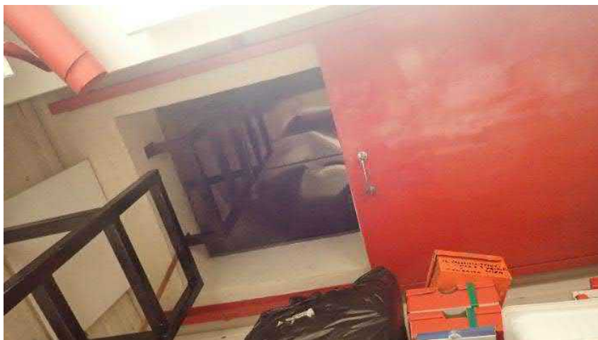
Kuva 34 . Tilassa 46 on kattoluukku, joka johtaa ilmanvaihtokonehuoneeseen. Luukku liikkuu kiskoilla ja ei ole ilmatiivis. Ilmanvaihtokonehuoneesta kulkeutuu mineraalivillan hajua käytävälle 49 ja varastotilaan.
