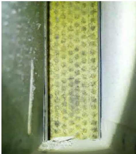
Kuva 55. Märkätilojen yhteydessä olevissa siirtoilmaventtiileissä on pin- noittamatonta mineraalivillaa.
