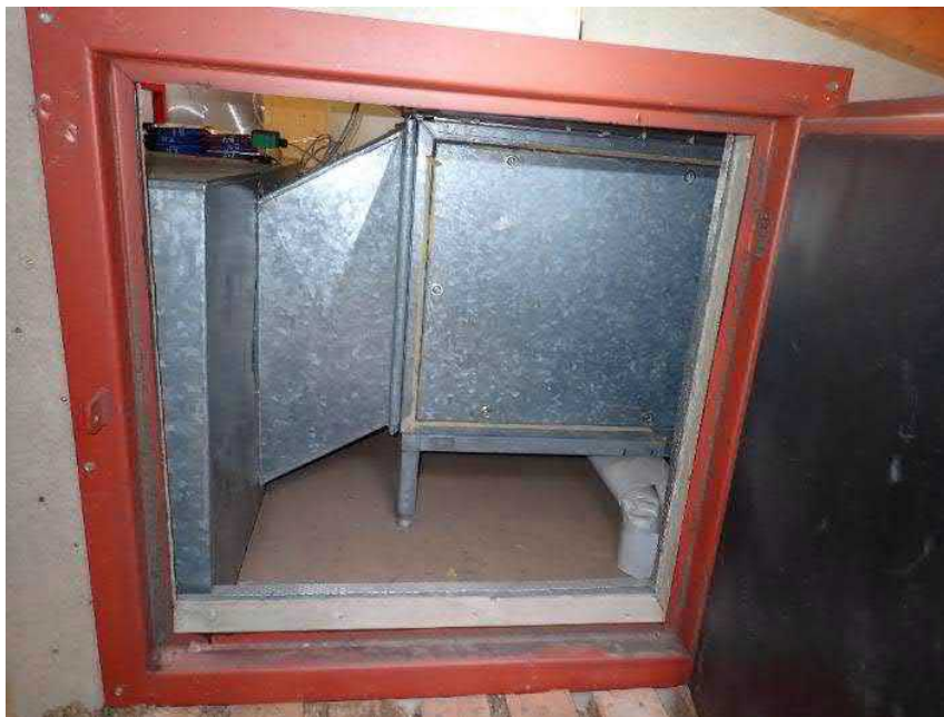
Kuva 27. Ilmanvaihtokoneen takana on käyntiluukku, jossa ei ole tiivisteitä. Luukun ohi voi kulkeutua epäpuhtauksia ilmanvaihtokonehuoneeseen ja sen kautta muualle sisäilmaan.
