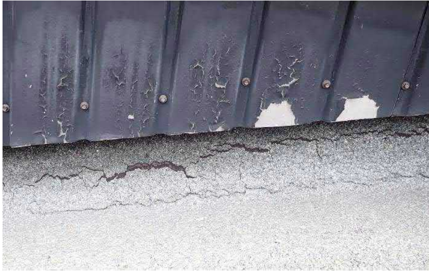
Kuva 42. Vesikatekermin ylösnostossa IV-konehuoneen kohdalla havaittiin merkittävää kermin kulumista.
