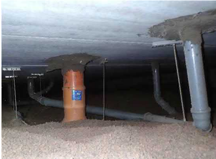
Kuva 14. Ryömintätilassa alapohjan läpiviennit vaikuttavat siltä, että niihin on tehty lisätiivistyksiä vedeneristemassalla.
