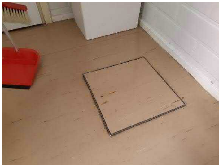
Kuva 16. Tilassa 35 oli myös viemärin (LVI-suunnitelmien mukaan) tarkastusluukku, jota ei saatu auki. Luukun reiästä havaittiin ilmavirtausta huone-tilaan päin.
