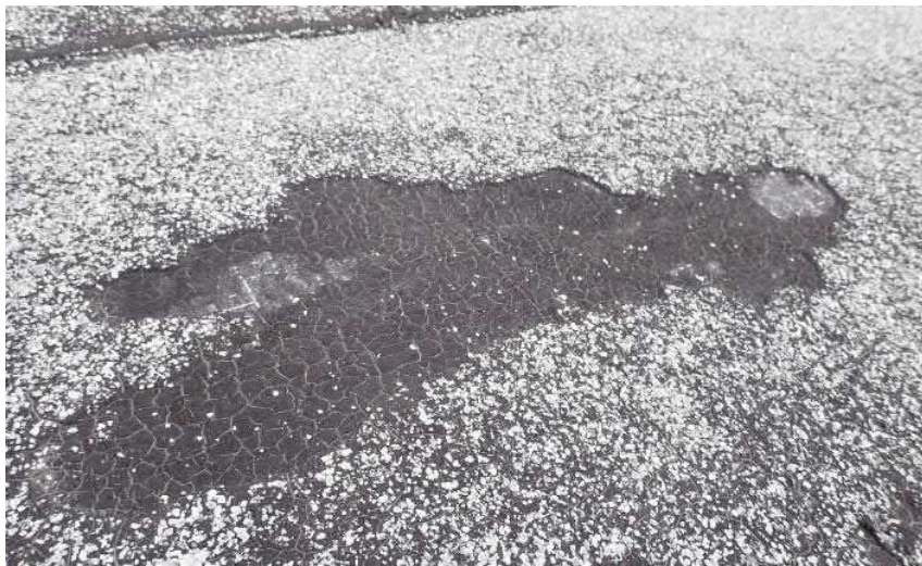
Kuva 41. Vesikatteessa on paikoin merkittävää kulumista. Kermin kuidut ovat paikoin nähtävissä. Kermi on laajalti sirotteen alla verkottunut.
