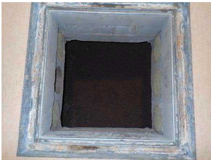
Kuva 9. Ryömintätilan tarkastusluukussa ei ollut kunnollisia tiivisteitä.
