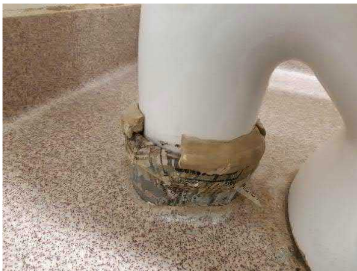
Kuva 5. Tilan 34 WC-istuimen viemäritiivisteet olivat kovettuneet ja lohkeileet. Lohkeaman kohdalla havaittiin ilmavirtaus.
