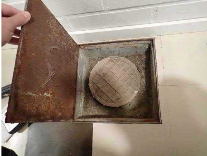
Kuva 15. Käytävällä 49 viemärin tarkastusluukussa ei ollut tiivisteitä, muttei myöskään ilmavirtauksia tai hajuja.
