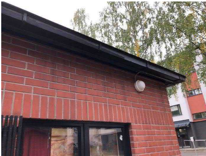
Kuva 21. Julkisivulla ulkoseinien yläosissa havaittiin tummia viuruja säännöllisesti. Nämä johtuvat todennäköisesti yläpohjan ja räystäiden mahdollisista vesivuodoista.
