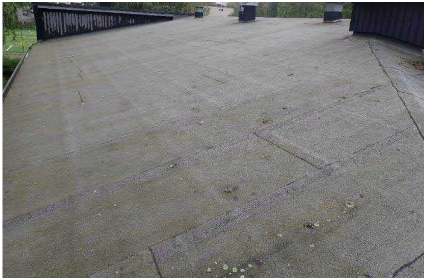
Kuva 43. Vesikatekermissä oli havaittavissa aaltoilua, jonka epäillään olevan seurausta aluskermin osittaisesta irtoamisesta alustastaan.
