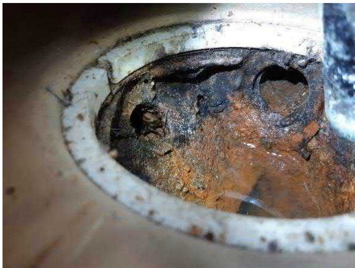
Kuva 7. Tilan 34 WC-istuimen viemäritiivisteet olivat kovettuneet ja lohkeileet. Lohkeaman kohdassa havaittiin ilmavirtaus.
