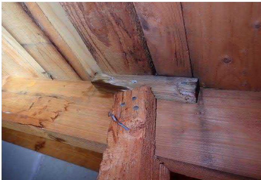
Kuvat 48 ja 49. Vesikatteessa havaittiin kahdessa kohdassa mahdollinen vesivuotokohta (IV-konehuoneen käyntiluukku yläpohjaan). Näissä ei havaittu kohdekäynnillä aktiivista vesivuotoa.
