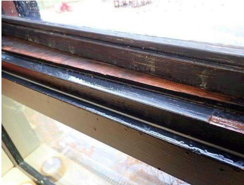
Kuva 22. Tilassa 20 havaittiin, että sateella räystäskourujen täyttyessä vettä roiskuu yli ulkoseinille ja se kulkeutuu osittain ikkunapokan ohi ikkunakarmin päälle näkyville.
