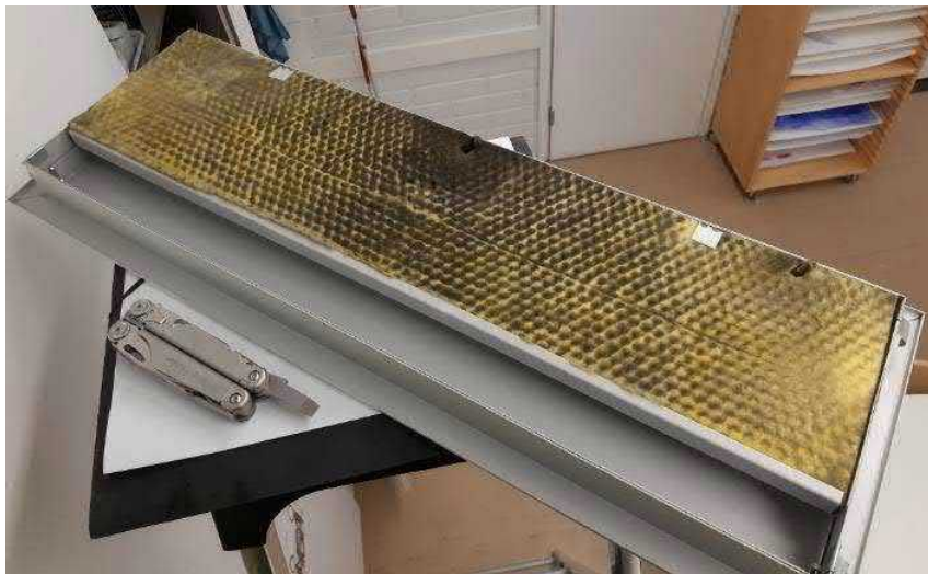
Kuva 53. Alkuperäisissä tuloilmapäätteissä oli äänenvaimentimia, joissa on pinnoittamatonta mineraalivillaa.
