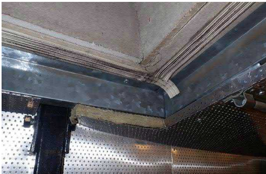
Kuva 38. Yläpohjan käyntiluukun tiivisteet ovat kuluneet ilmanvaihtokonehuoneessa.
