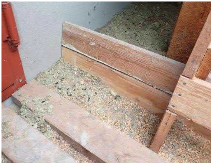
Kuva 45. Yläpohjan eristetilassa havaittiin useissa kohdin pieneläimen jätöksiä.
