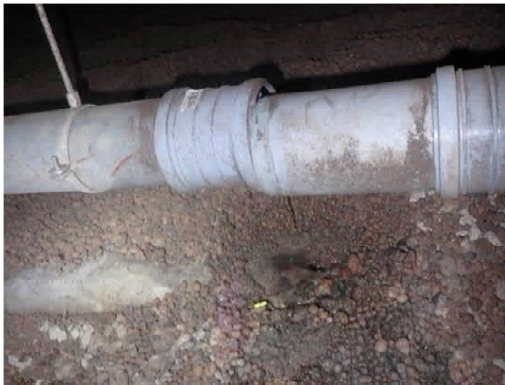
Kuva 13. Ryömintätilassa havaittiin katkennut viemäriputki. Tästä ilmoitettiin tilaajalle välittömästi.
