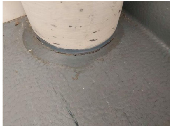
Kuva 5.6. WC-tila (tila 7) olevan viemärin tuuletusputken juuren tiivistyksessä rakoa.
