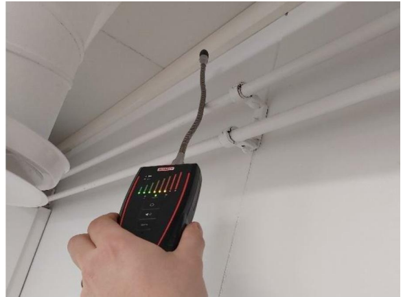
Kuva 7.16. Seinän ja yläpohjan liittymässä vuotokohta tilassa 6.
