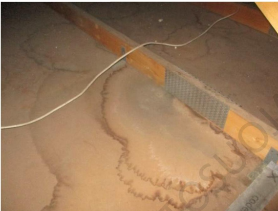
Kuva 7.5. Kosteusjälkiä yläpohjaelementin yläpinnalla
