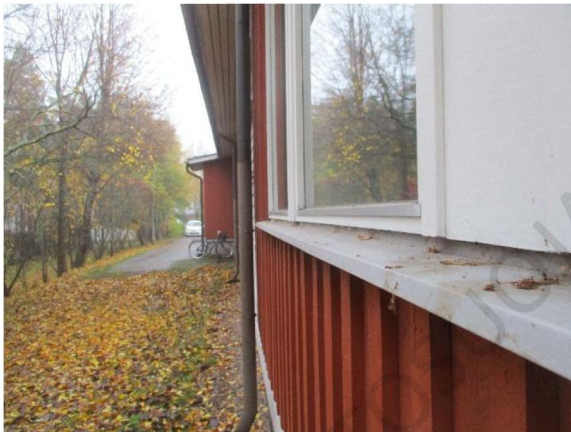
Kuva 4.7. Ikkunoiden vesipeltien kallistukset ja tuuletusaukot olivat puutteelliset.
