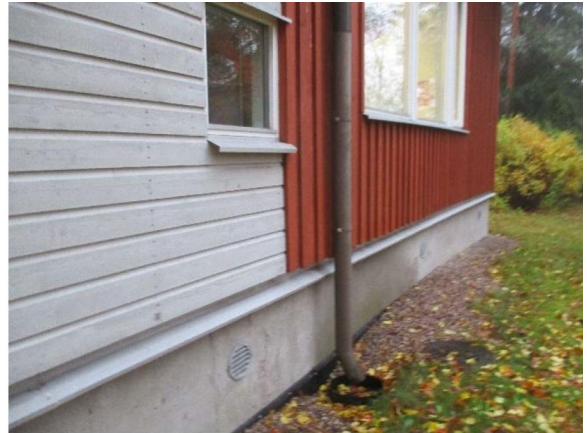
Kuva 4.6. Sokkelissa kosteusjälkiä ja rännikaivo lehtien täyttämä rakennuksen pohjoispuolella.
