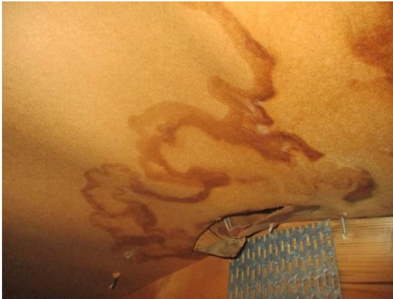
Kuva 7.3. Aluskatteessa on lähes kauttaaltaan kosteusjälkiä. Varsinkin läpivientien läheisyydessä.
