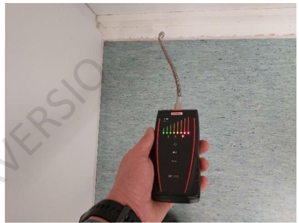
Lattian ja seinän liittymässä oleva ilmavuoto tilassa 4 (ME.01-AP)
