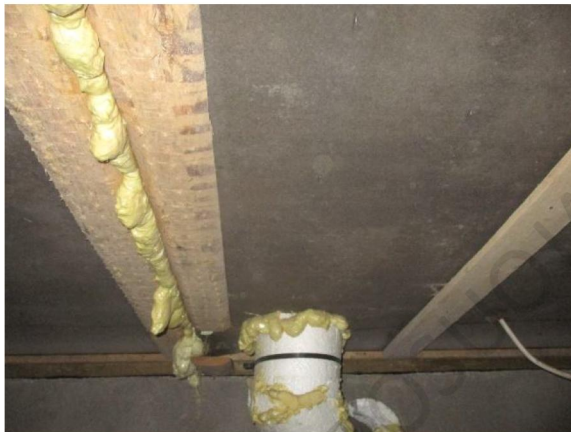
Kuva 5.19. Ryömintätilasta tehtyjen havaintojen perusteella on alapohjaelementtien saumat tiivistetty uretaanivaahdolla.
