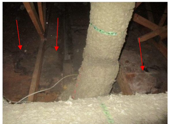
Kuva 7.8. Alakaton päällä runsaasti jälkiä kosteusrasituksesta, mahdollisesti vanhasta kattovuodosta jääneitä jälkiä.
