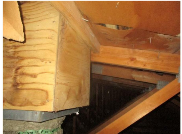
Kuva 7.4. Kosteusjälkiä ilmanvaihtokoneen koteloinnissa ja aluskatteessa. Kosteusjäljet mahdollisesti vanhoja.
