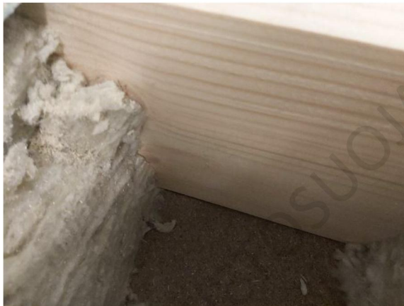
Kuva 5.7 Alapohjan bitumikyllästetty puukuitulevy oli irti alapohjanpalkista. Palkin ja puukuitulevyn välissä oli n. 1 cm rako (RA.02-AP/VS)
