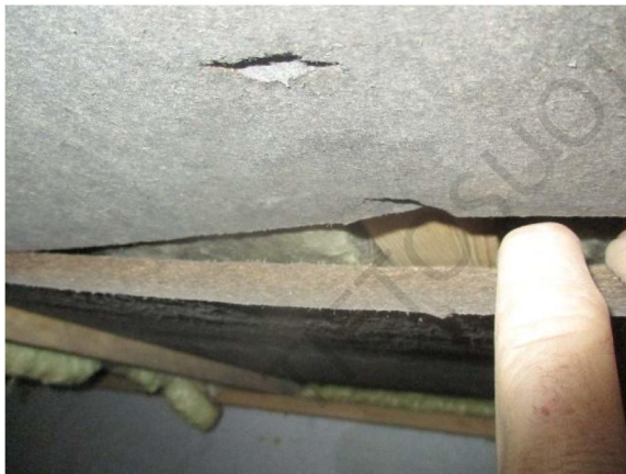
Kuva 5.15. Alapohjan puukuitulevyjä oli irti puupalkeista,
