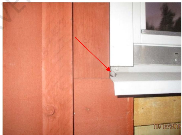
Kuva 6.4. Ikkunapellityksessä rako, josta viistosateella mahdollisuus kastella julkisivurakennetta (RA.09-US).
