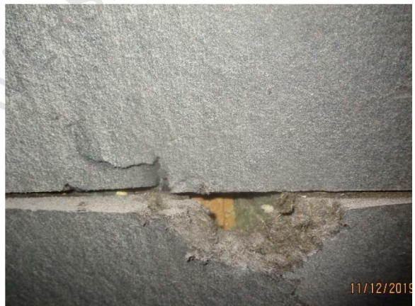
Kuva 5.12. Alapohjan puukuitulevyssä oli reikiä, jotka voivat aiheuttaa ilmavuotoja eristetiäan. Reikiä ei ollut yleisesti alapohjan levyissä.
