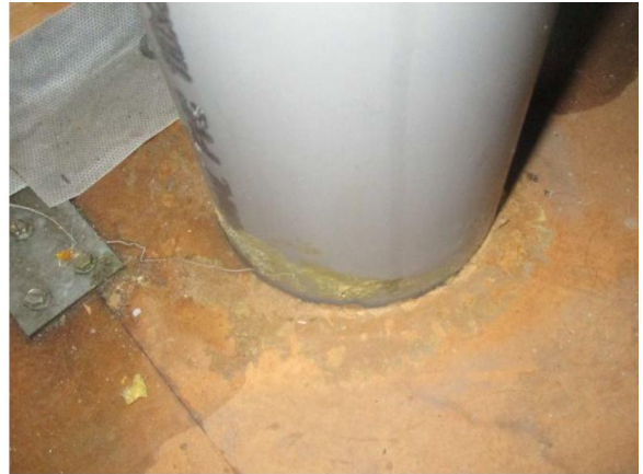
Kuva 7.10. Viemärintuuletusputken läpivienttiä ei ole tiivistetty.
