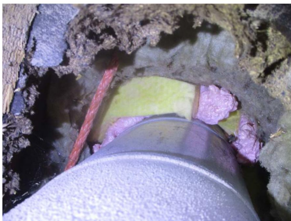
Kuva 5.21. Yksittäisiä puutteellisesti tiivistettyjä putkiläpivientejä.
