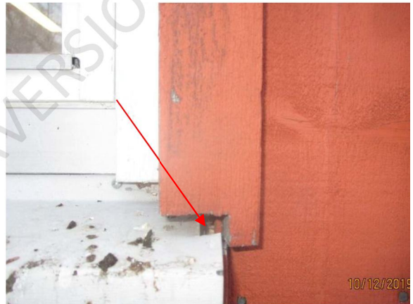
Kuva 4.8. Ikkunapellityksessä rako julkisivura-kenteeseen. Rakoja havaittiin paikallisesti.
