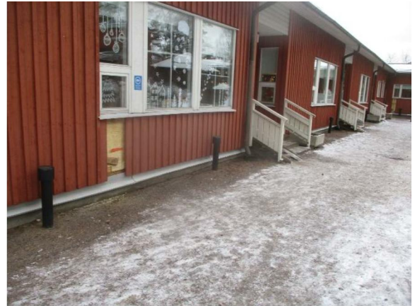
Kuva 5.14. Sisäpihalla on ryömintätilan korvausilman saanti toteutettu rakennuksen seinustalle noin 4 metrin välein asennettujen tuuletuspaalujen ( \varnothing 110 mm) avulla. Ilmavirtojen säätämiseksi on kanavien ryömintätilaan rajoittuvaan päähän asennettu lisäksi lautasventtiilit.
