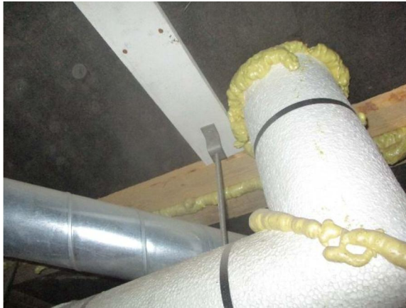
Kuva 5.13. Ryömintätilan alapohjan läpiviennit oli tiivistetty uretaanivaahdolla.
