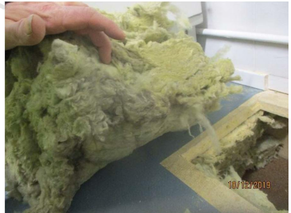
Kuva 5.4. Rakenneavauksessa (RA.06-AP) oli alapohjan alemman mineraalivillalevyn alapinnassa havaittavissa tummentumaa, joka viittaa ilmavirtauksiin eristekerroksessa.
