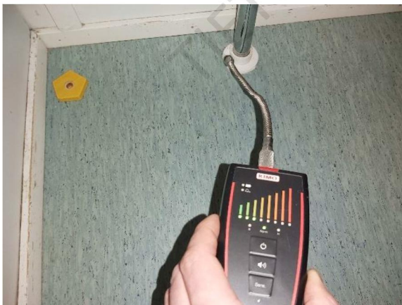
Putkiläpiviennin juuresta havaittu ilmavuoto tilassa 10 (ME.02-AP).
