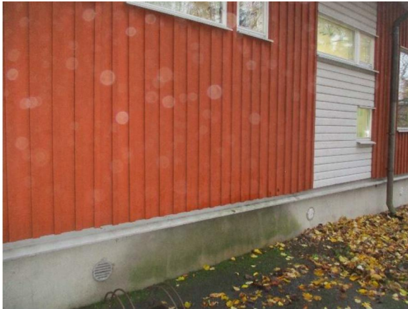
Kuva 4.5. Rakennuksen sokkelissa kosteusjälkiä ja leväkasvustoa rakennuksen länsipuolella.
