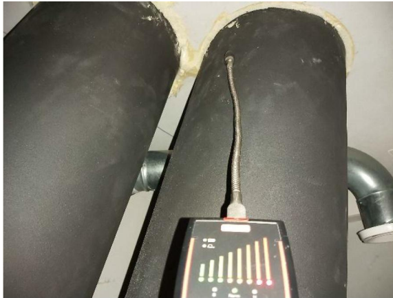
Kuva 7.15. Putkien läpiviennistä vuotoja uudessa ilmanvaihto huoneessa.
