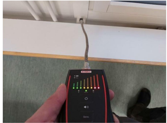
Ulkoseinän merkkiainekokeen yhteydessä ikkunalaudan kiinnikkeestä havaittu vuoto (ME.05-US).
