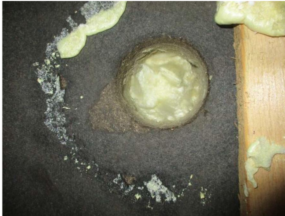
Kuva 5.17. Vanhoja putkiläpivientejä oli tiivistetty uretaanilla.
