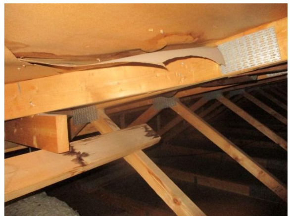
Kuva 7.2. Aluskatteessa ja tukipuissa kosteusjälkiä.
