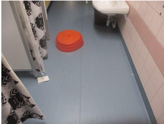
Kuva 5.5. WC-/Pesutiloissa oli lattian pintamateriaalina käytetty muovimattoja. Rakennusneuvoston perusteella toimii lattiapinnoite osana alapohjarakenteen höyrynsulkua.
