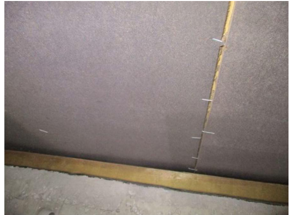
Kuva 5.18. Puukuitulevyjen saumoissa todettiin paikallisesti rakoa ja puukuitulevyjä oli osin kiinnitetty puutteellisesti.
