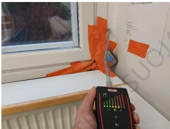
Ulkoseinän merkkiainekokeen yhteydessä ulkoseinän ja ikkunan liittymästä havaitut vuodot (ME.06-US).
