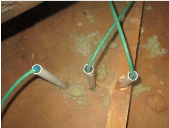
Kuva 7.9. Tiivistämättömiä läpivientejä alakattossa.
