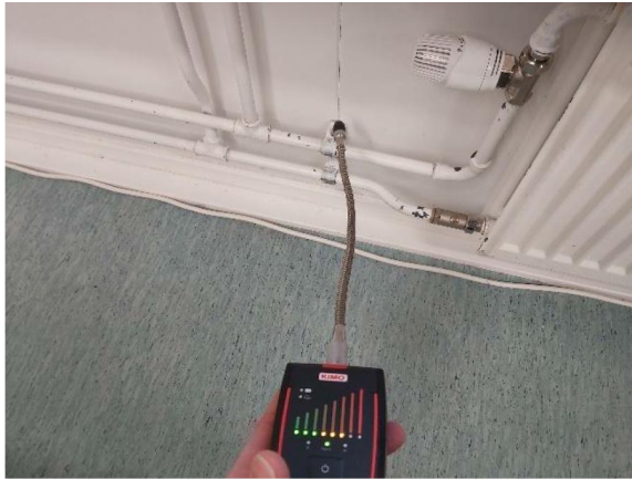
Ulkoseinän merkkiainekokeen yhteydessä putkenkannattimen välistä havaittu vuoto (ME.04-US).
