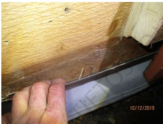
Kuva 6.3. Alaohjauspuu voimakkaasti tummentunut. Sokkelissa myös leväkasvustoa (RA.09-US).
