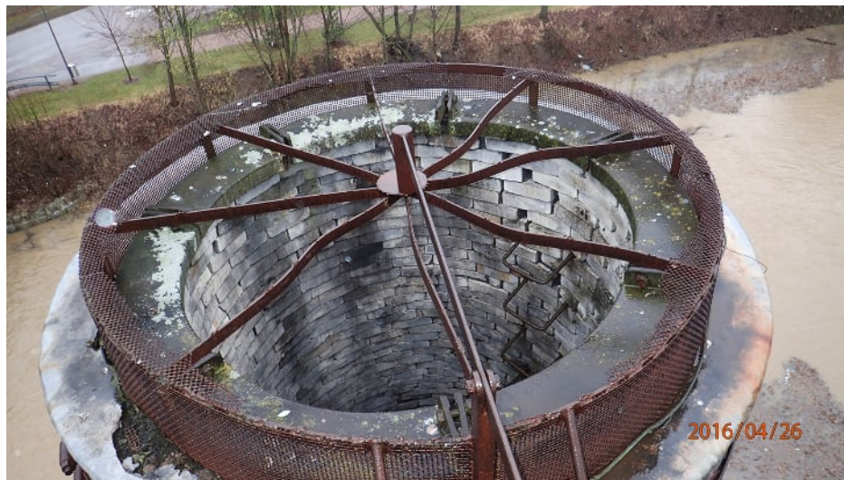
Kuva 4. Piipun yläpään verkko on ruostunut pois ja kauluksen reunoissa ei ole tippareunaa, jolloin vedet valuvat ylimpiin tiiliin
