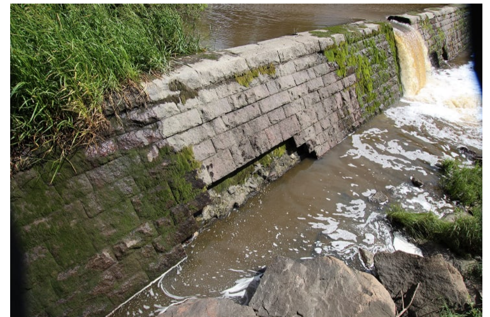
Kuva 6. Padosta on irronnut verhoilukiviä ja betoni on rapautunut
