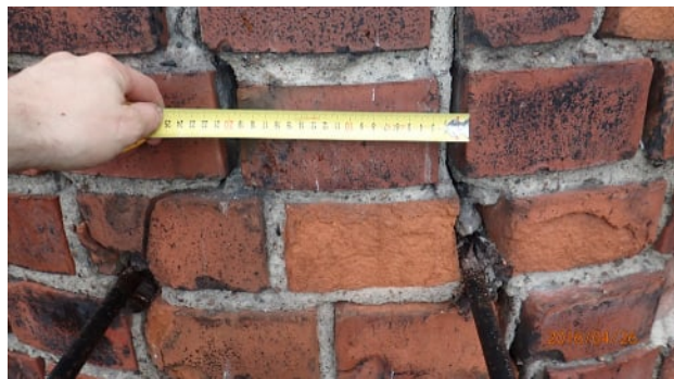
Kuva 3. Halkeamia on eniten huoltotikkaiden kohdalla
